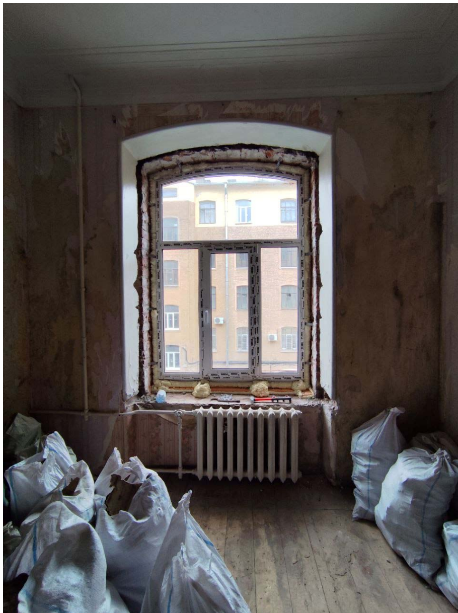
Фото 27. Квартира №32, помещение №5, оконный проем.
