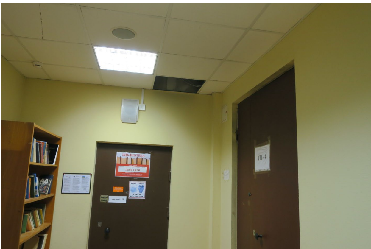
5. Помещение №1 (25-Н) объекта культурного наследия федерального значения «Райсовет Кировский», расположенного по адресу: г. Санкт-Петербург, пр. Стачек, д. 18, литера А. 13.06.2023.
