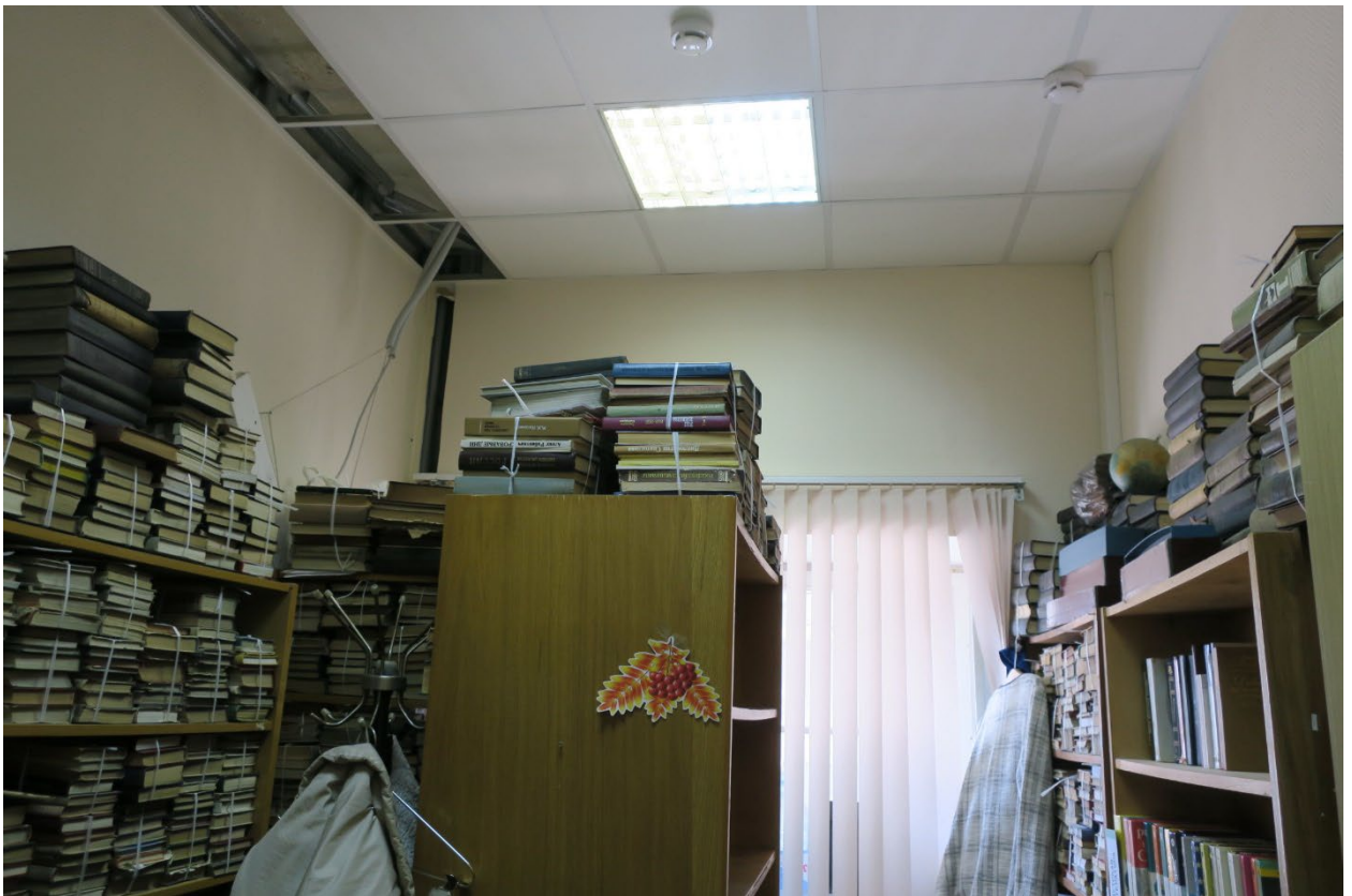
16. Помещение №3 (25-Н) объекта культурного наследия федерального значения «Райсовет Кировский», расположенного по адресу: г. Санкт-Петербург, пр. Стачек, д. 18, литера А. 13.06.2023.
