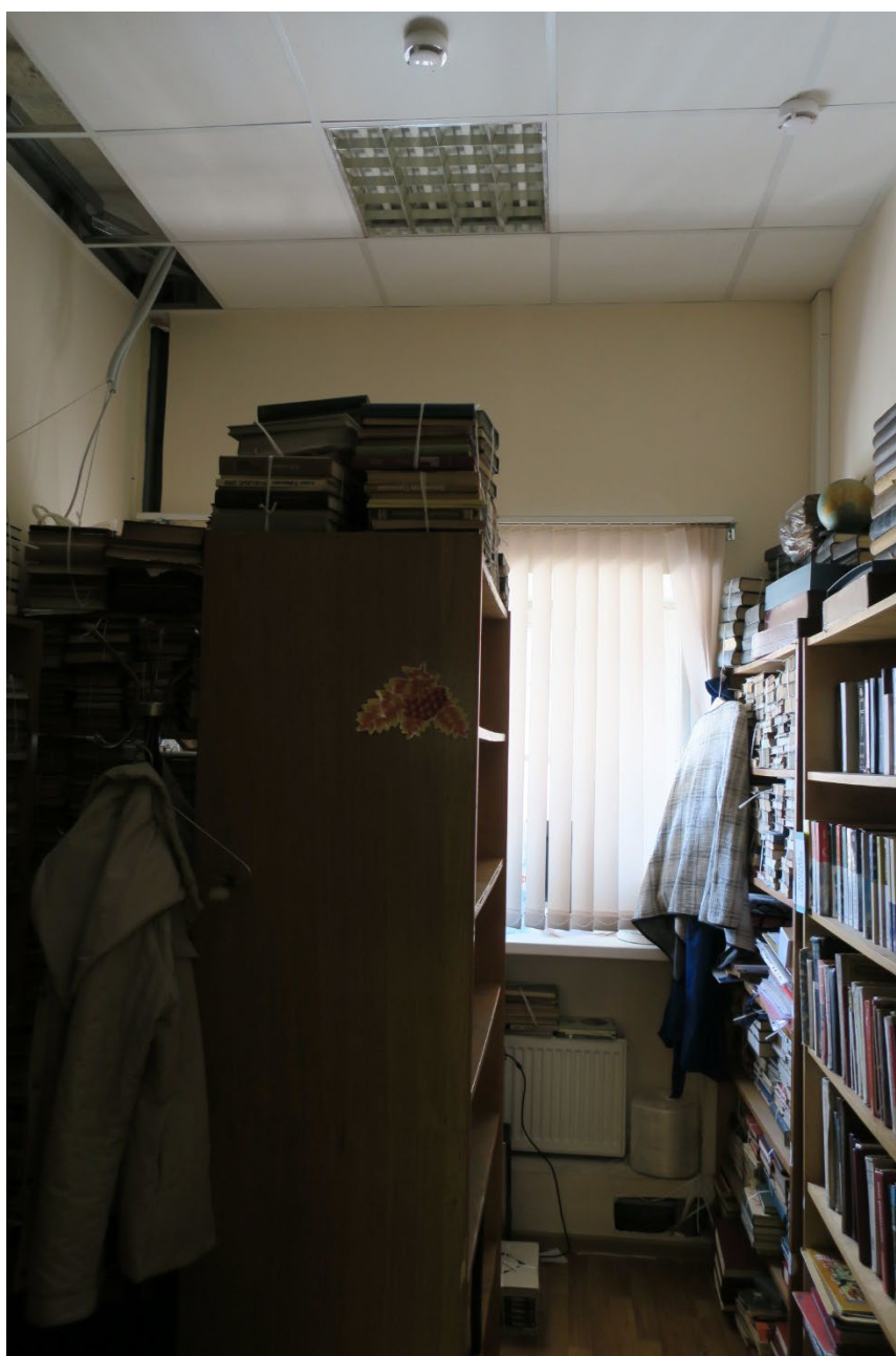
15. Помещение №3 (25-Н) объекта культурного наследия федерального значения «Райсовет Кировский», расположенного по адресу: г. Санкт-Петербург, пр. Стачек, д. 18, литера А. 13.06.2023.
