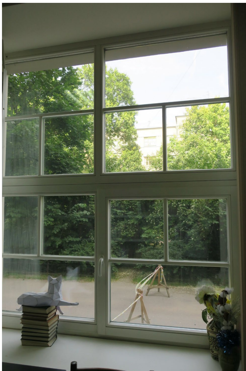
11. Оконные заполнения помещения №7 (25-Н) объекта культурного наследия федерального значения «Райсовет Кировский», расположенного по адресу: г. Санкт-Петербург, пр. Стачек, д. 18, литера А. 13.06.2023.
