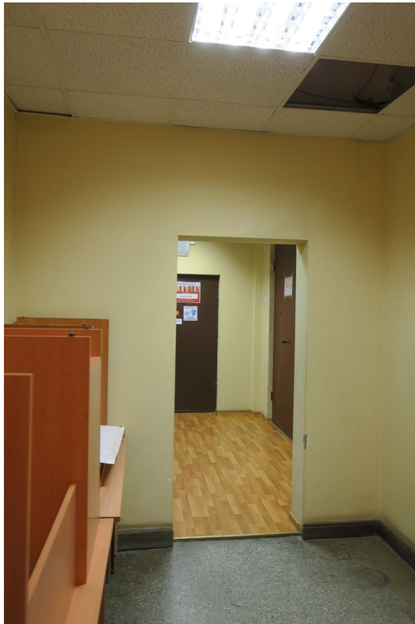
4. Помещение №3 (25-Н) объекта культурного наследия федерального значения «Райсовет Кировский», расположенного по адресу: г. Санкт-Петербург, пр. Стачек, д. 18, литера А. 13.06.2023.
