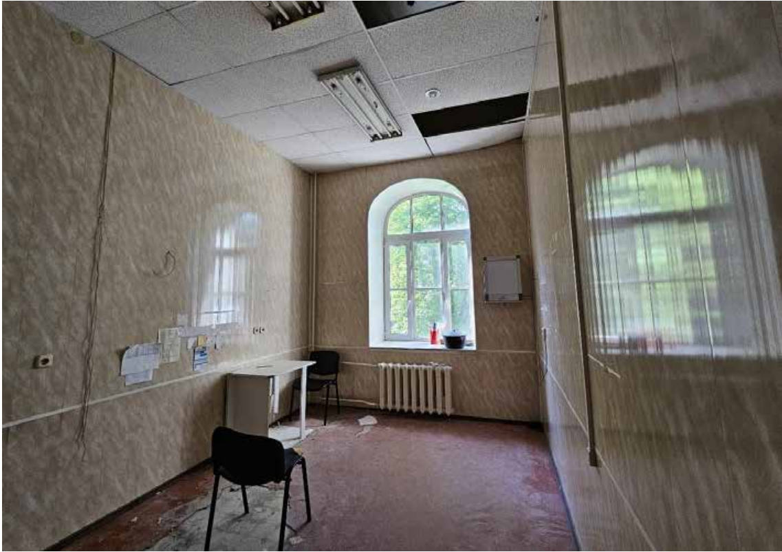
57. Объект культурного наследия регионального значения «Корпус № 2», по адресу: Санкт-Петербург, город Петергоф, Санкт-Петербургский проспект, дом 20, литера В, в составе объекта культурного наследия регионального значения «Комплекс дворцового госпиталя (с территорией)». Общий вид пом. 1-Н (52) в уровне 2-го этажа.
