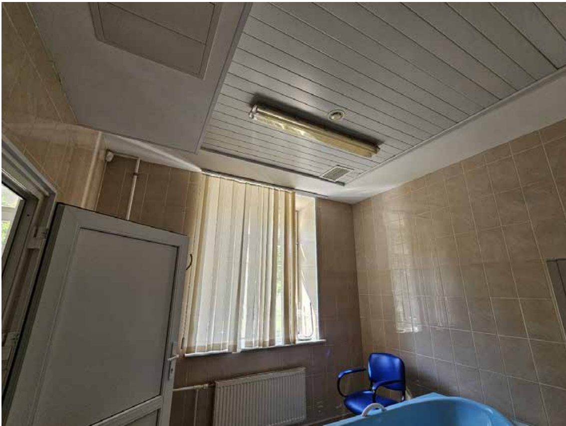
35. Объект культурного наследия регионального значения «Главный корпус», по адресу: Санкт-Петербург, г. Петергоф, Санкт-Петербургский пр., д. 20, лит. А, в составе объекта культурного наследия регионального значения «Комплекс дворцового госпиталя (с территорией)». Общий вид пом. 1-Н (17) в уровне 1-го этажа.
