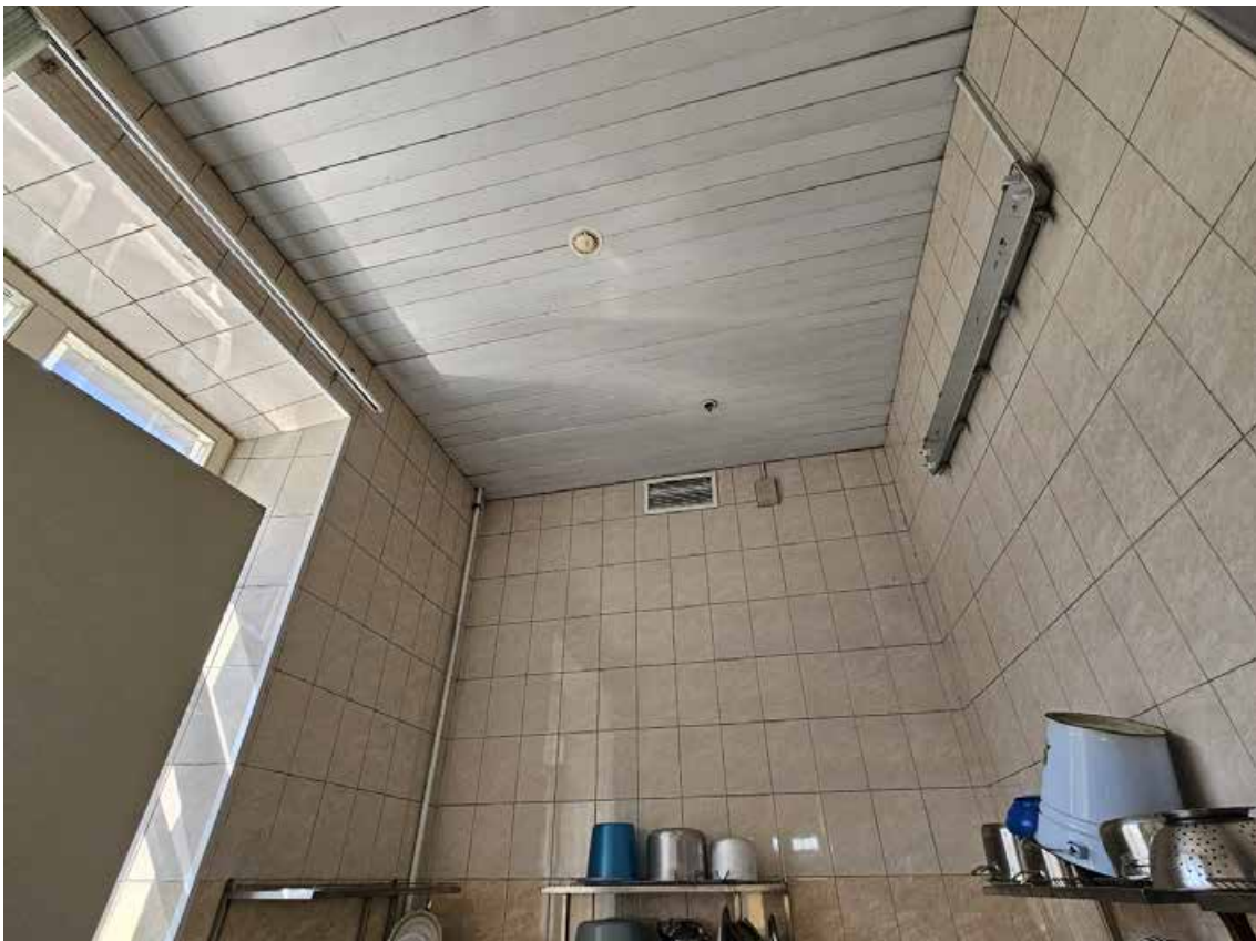
68. Объект культурного наследия регионального значения «Главный корпус», по адресу: Санкт-Петербург, г. Петергоф, Санкт-Петербургский пр., д. 20, лит. А, в составе объекта культурного наследия регионального значения «Комплекс дворцового госпиталя (с территорией)». Общий вид пом. 1-Н (42) в уровне 2-го этажа.
