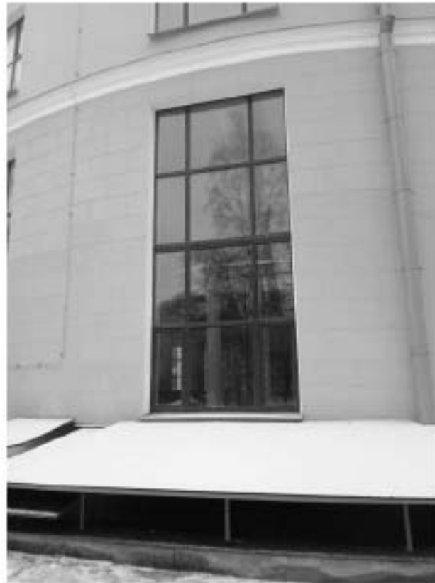
35. ОКНРЗ «Дворец пушкинъ». Фрагмент центрального ризалита восточного фасада. Вид на юго-запад. Дата съёмки: 15.01.2024г.
