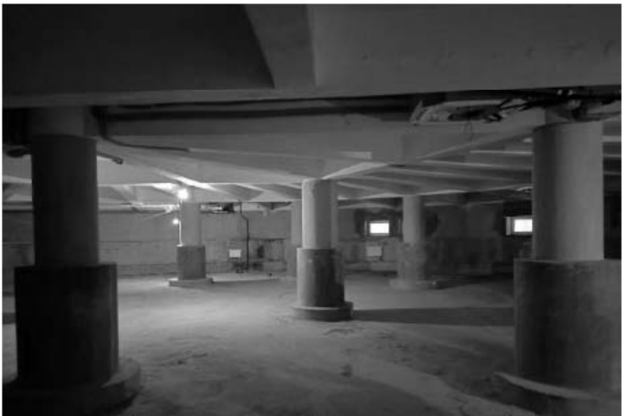
6. ОКНРЗ «Дворец пушкины». Интерьер подвального этажа. Фрагмент конструктивной системы – колонны и историческое перекрытие (перекрестная система железобетонных балок с бетонным заполнением). Дата дополнительной съёмки: 15.07.2024г.
