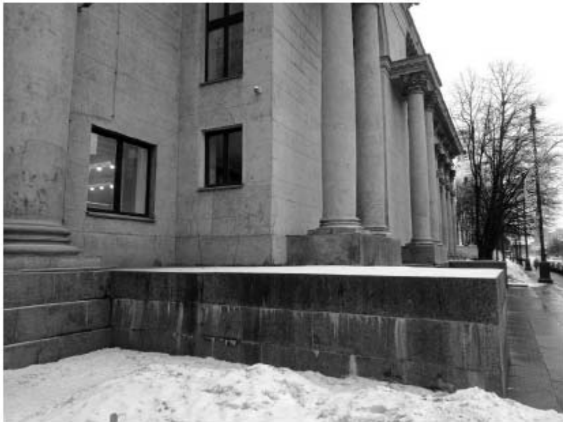
21. ОКНРЗ «Дворец пушкинский». Фрагмент портика. Дата съёмки: 15.01.2024г.
