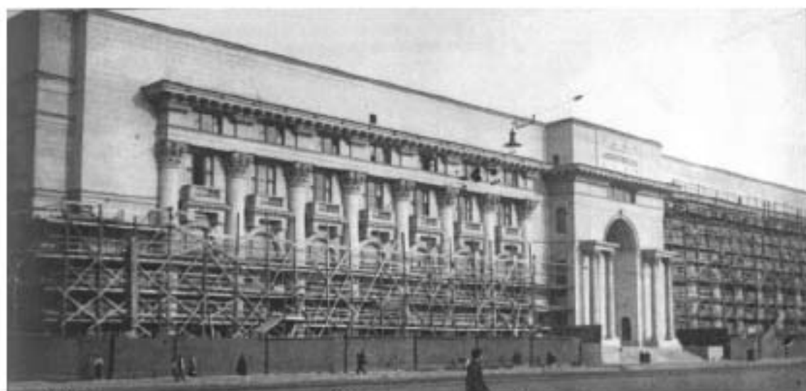
49. Окончание строительства Дворца пушкины. Демонтаж строительных лесов с главных фасадов. 1938г. ЦГАКФФД СПб. Вр 49698.
