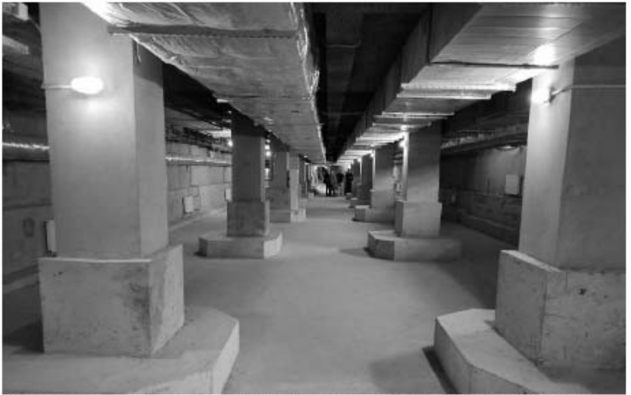
3. ОКНРЗ «Дворец пушкины». Интерьер подвального этажа. Фрагмент конструктивной системы – колонны. Дата дополнительной съёмки: 15.07.2024г.
