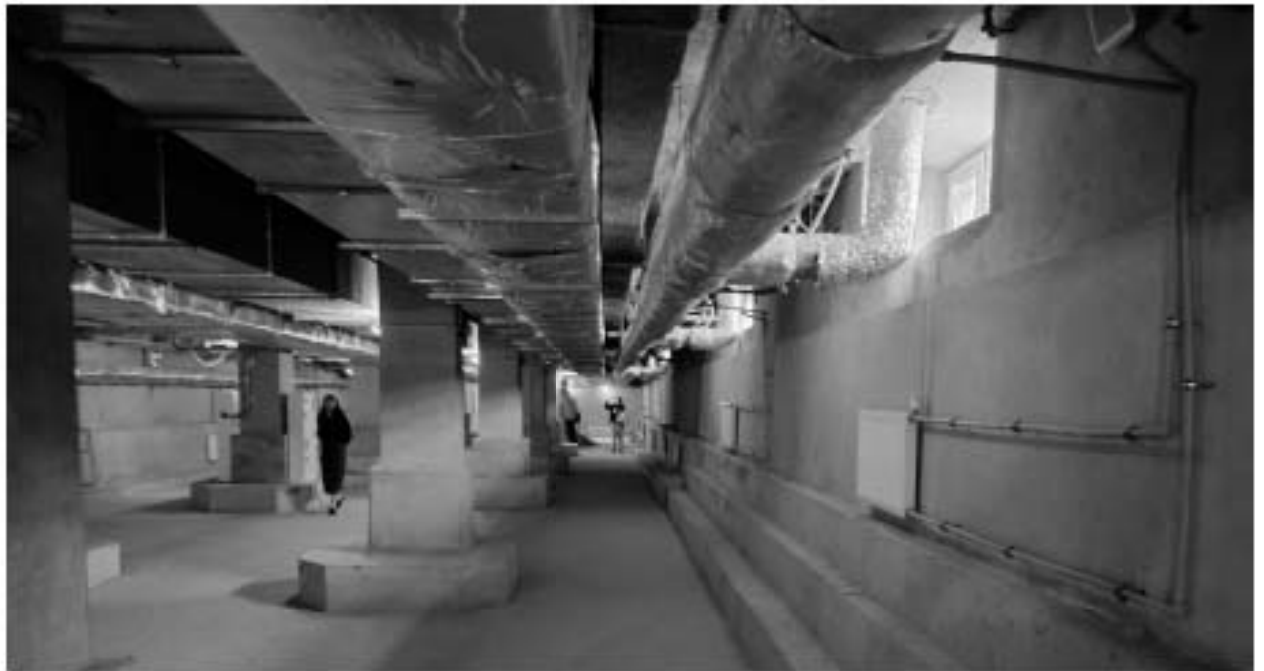
1. ОКНРЗ «Дворец пушкины». Интерьер подвального этажа. Фрагмент конструктивной системы – колонны. Дата съёмки: 15.01.2024г.
