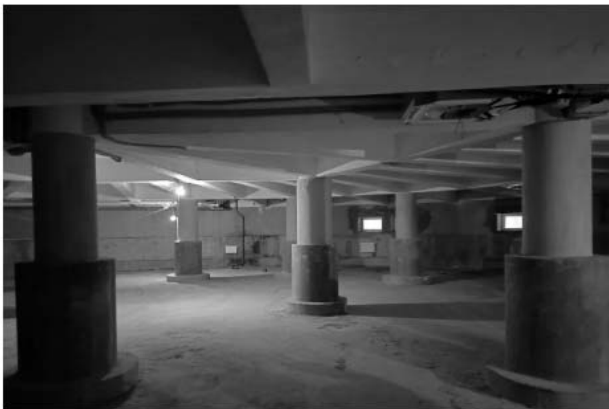
6. ОКНРЗ «Дворец пушкинъ». Интерьер подвального этажа. Фрагмент конструктивной системы – колонны и историческое перекрытие (перекрестная система железобетонных балок с бетонным заполнением). Дата съёмки: 15.01.2024г.
