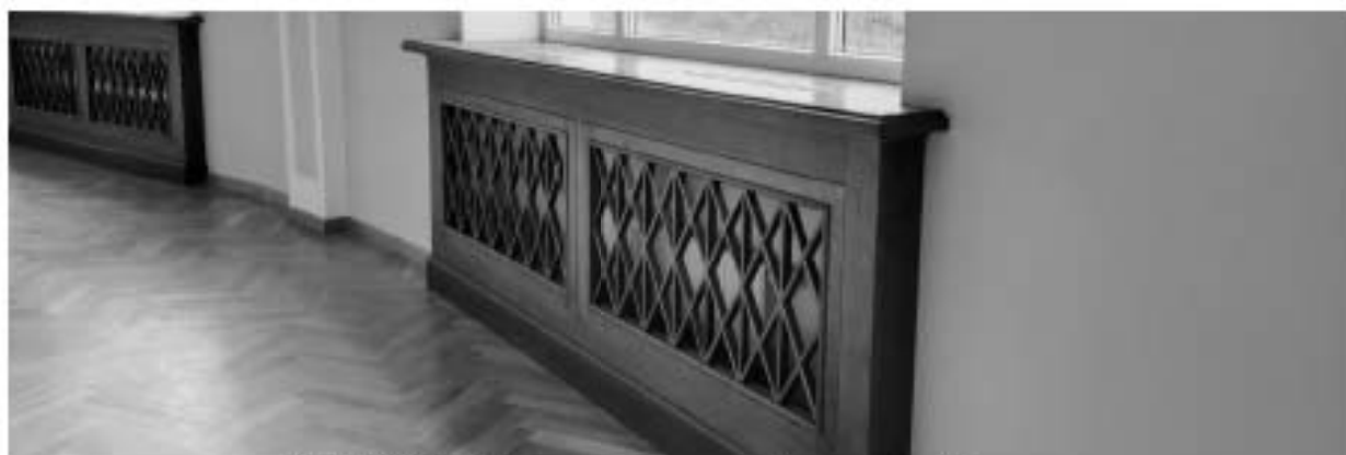
27. ОКНРЗ «Дворец пушнина». Аукционный зал. Деревянные решетки радиатора с рисунком в виде ромбовидной сетки. Дата съёмки: 15.01.2024г.
