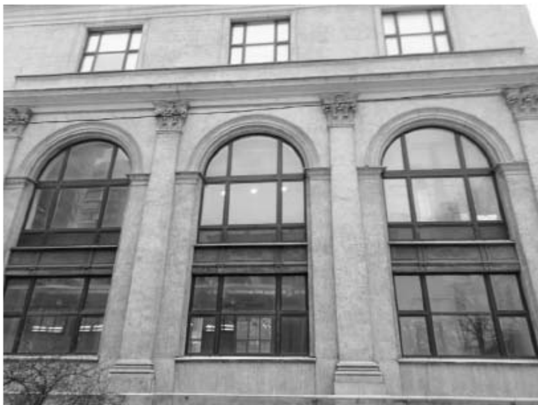
24. ОКНРЗ «Дворец пушкинъ». Фрагмент северного фасада. 15.01.2024г.
