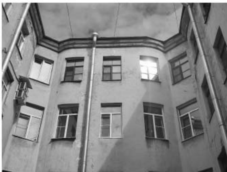
29. «Дом З.Н. Левина», 6-я Красноармейская ул., д. 15, лит. А. Дворовый фасад. Фрагмент. Фото 22.04.2024г.
