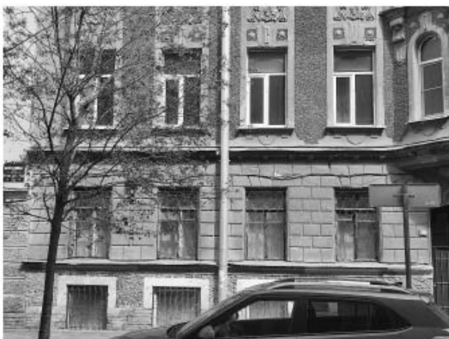
6. «Дом З.Н. Левина», 6-я Красноармейская ул., д. 15, лит. А. Южный фасад. Фрагмент. Фото 22.04.2024г.
