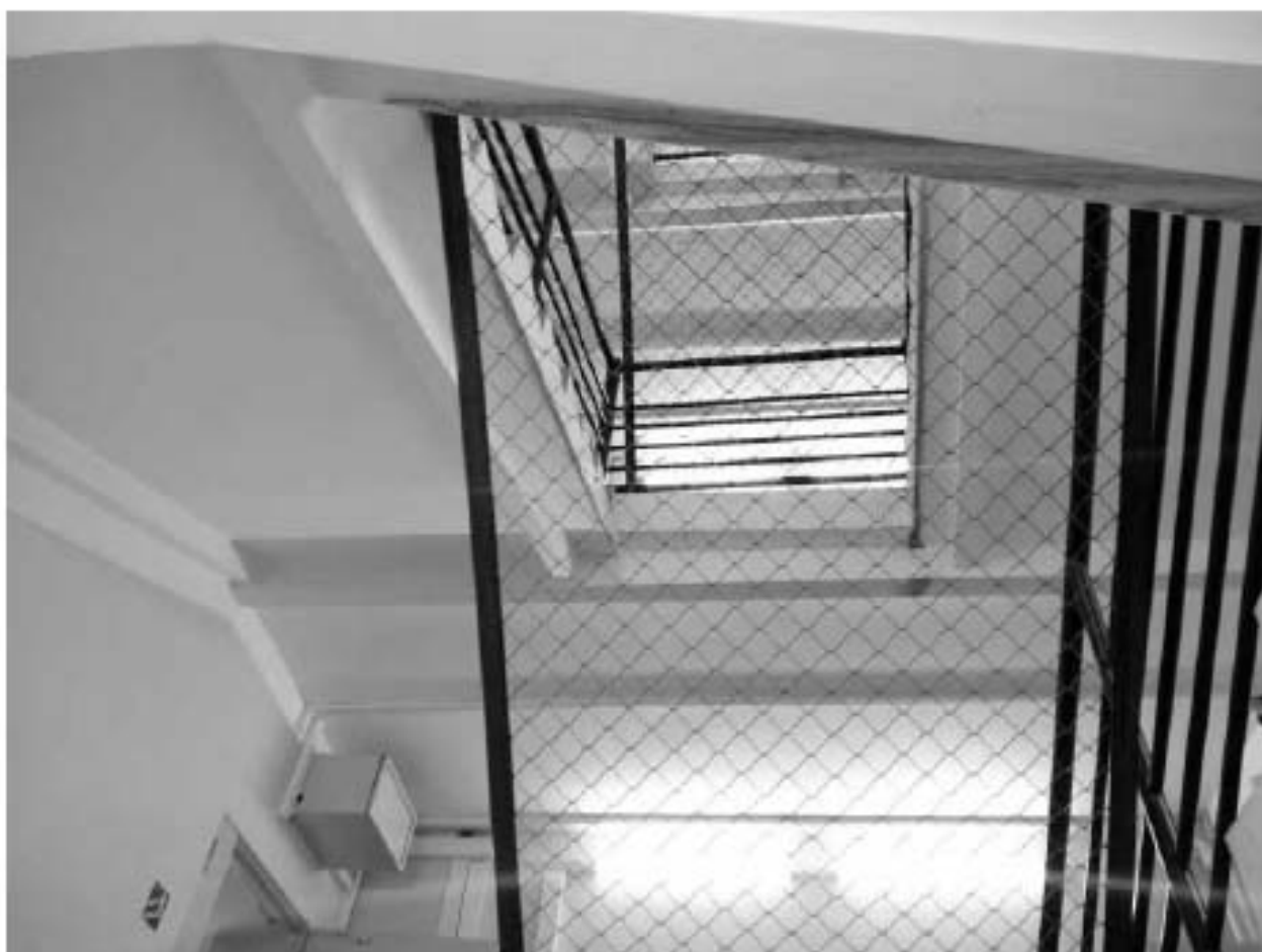
14. Лестница на стыке центрального и южного объема. Общий вид с площадки 1 этажа.
