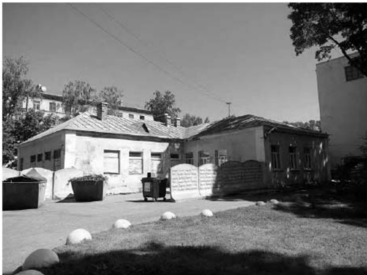
5. Общий вид здания с юго-запада. Оконные проёмы частично заложены. Имеются утраты фрагментов штукатурного карниза, в плоскости фасада – утраты окрасочного и штукатурного слоя, трещины, намокание.
