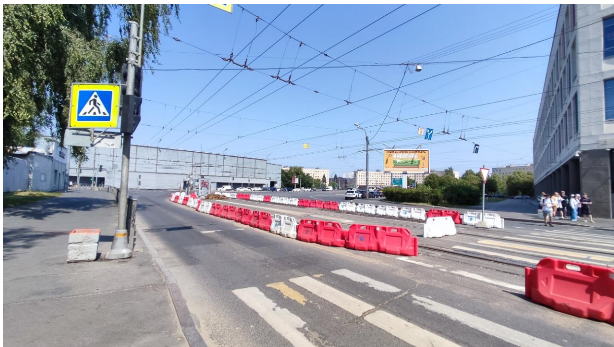
Фото 7. Общий вид на участок планируемых работ по ремонту трамвайных путей от Новочеркасского пр., с юго-запада.
