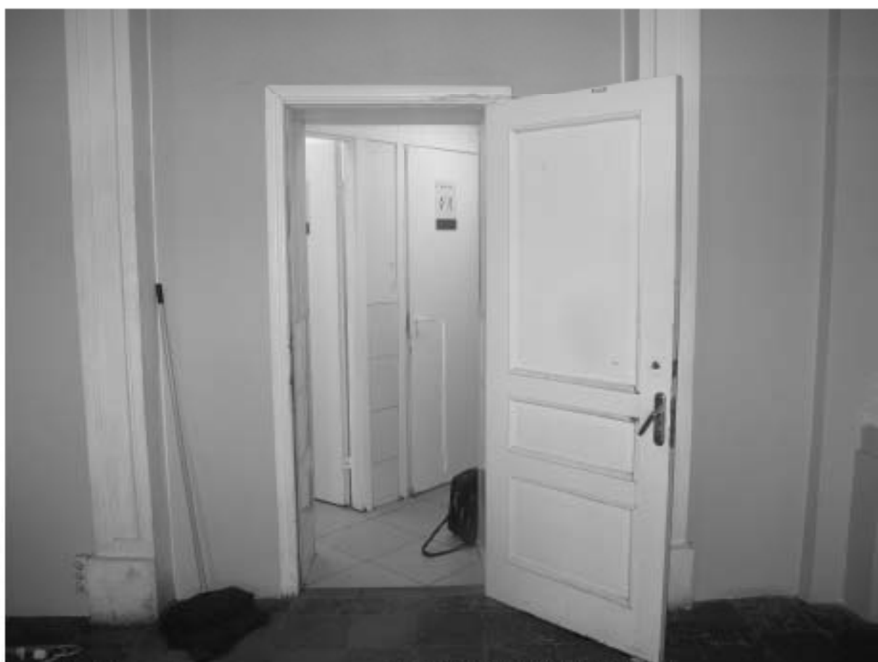
2. Входной проем в помещения №№ 318, 319, 320, 321, 322 объекта культурного наследия федерального значения «Академия художеств. Главное здание», расположенного по адресу: г. Санкт-Петербург, Университетская набережная, д. 17, литера Ц. 23.05.2024
