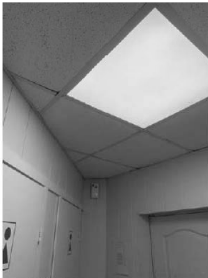
5. Помещение № 318 объекта культурного наследия федерального значения «Академия художеств. Главное здание», расположенного по адресу: г. Санкт-Петербург, Университетская набережная, д. 17, литера Ц. 23.05.2024
