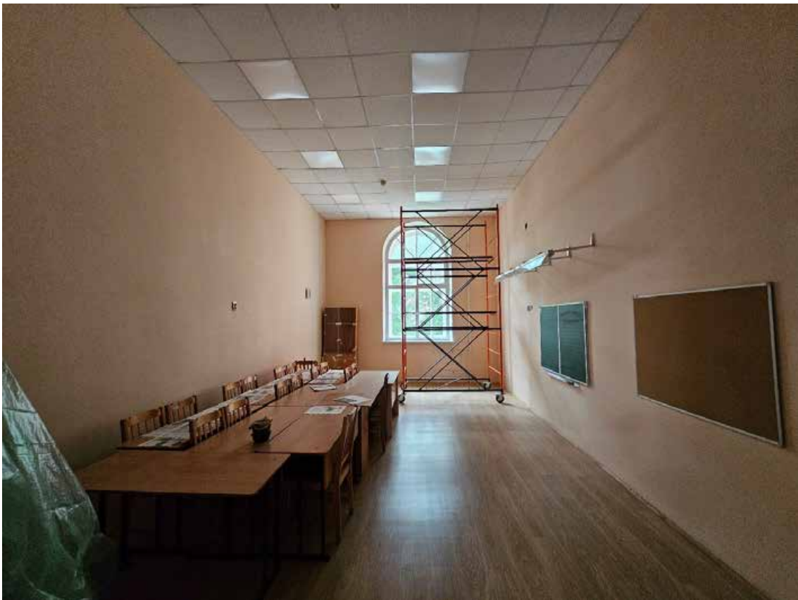
111. Объект культурного наследия регионального значения «Павловский институт с территорией, садом и оградой», по адресу: г. Санкт-Петербург, ул. Восстания, д. 8, лит. А. Общий вид пом. 7-Н (36) в уровне 2-го этажа.
