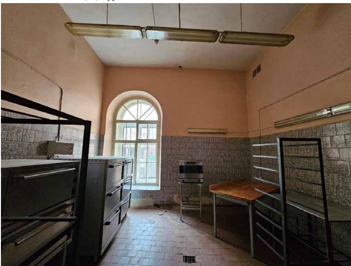
87. Объект культурного наследия регионального значения «Павловский институт с территорией, садом и оградой», по адресу: г. Санкт-Петербург, ул. Восстания, д. 8, лит. А. Общий вид пом. 5-Н (29) в уровне 1-го этажа.
