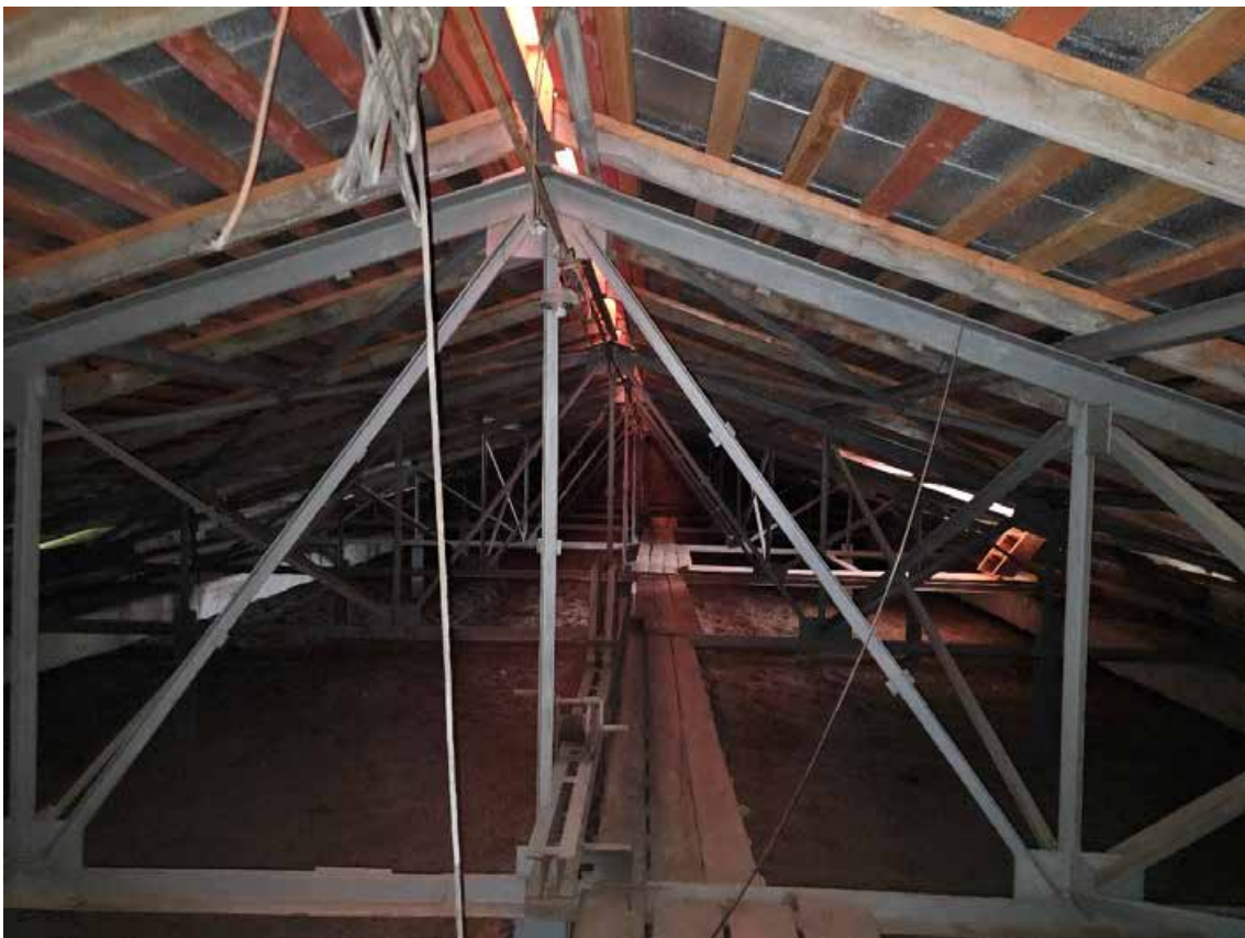
210. Объект культурного наследия регионального значения «Павловский институт с территорией, садом и оградой», по адресу: г. Санкт-Петербург, ул. Восстания, д. 8, лит. А. Фрагмент конструкции крыши юго-восточного флигеля.
