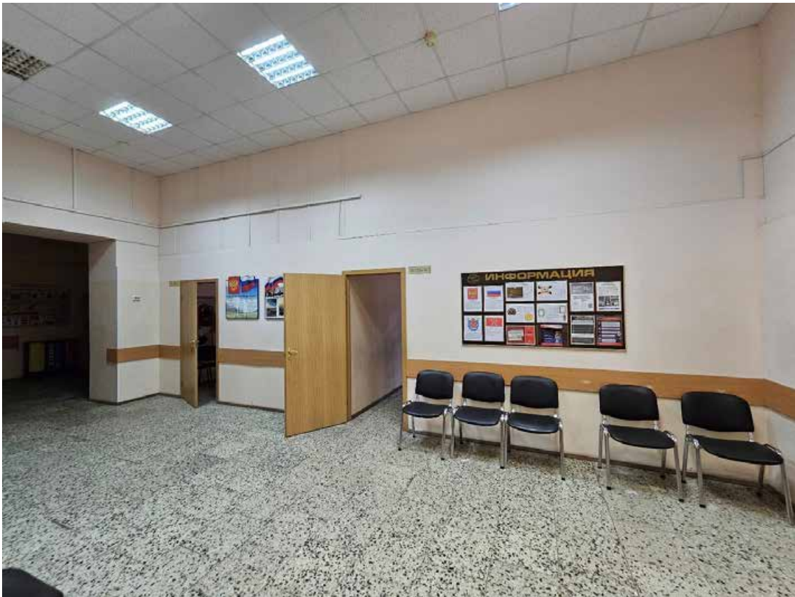
66. Объект культурного наследия регионального значения «Павловский институт с территорией, садом и оградой», по адресу: г. Санкт-Петербург, ул. Восстания, д. 8, лит. А. Общий вид пом. 5-Н (67) в уровне 1-го этажа.
