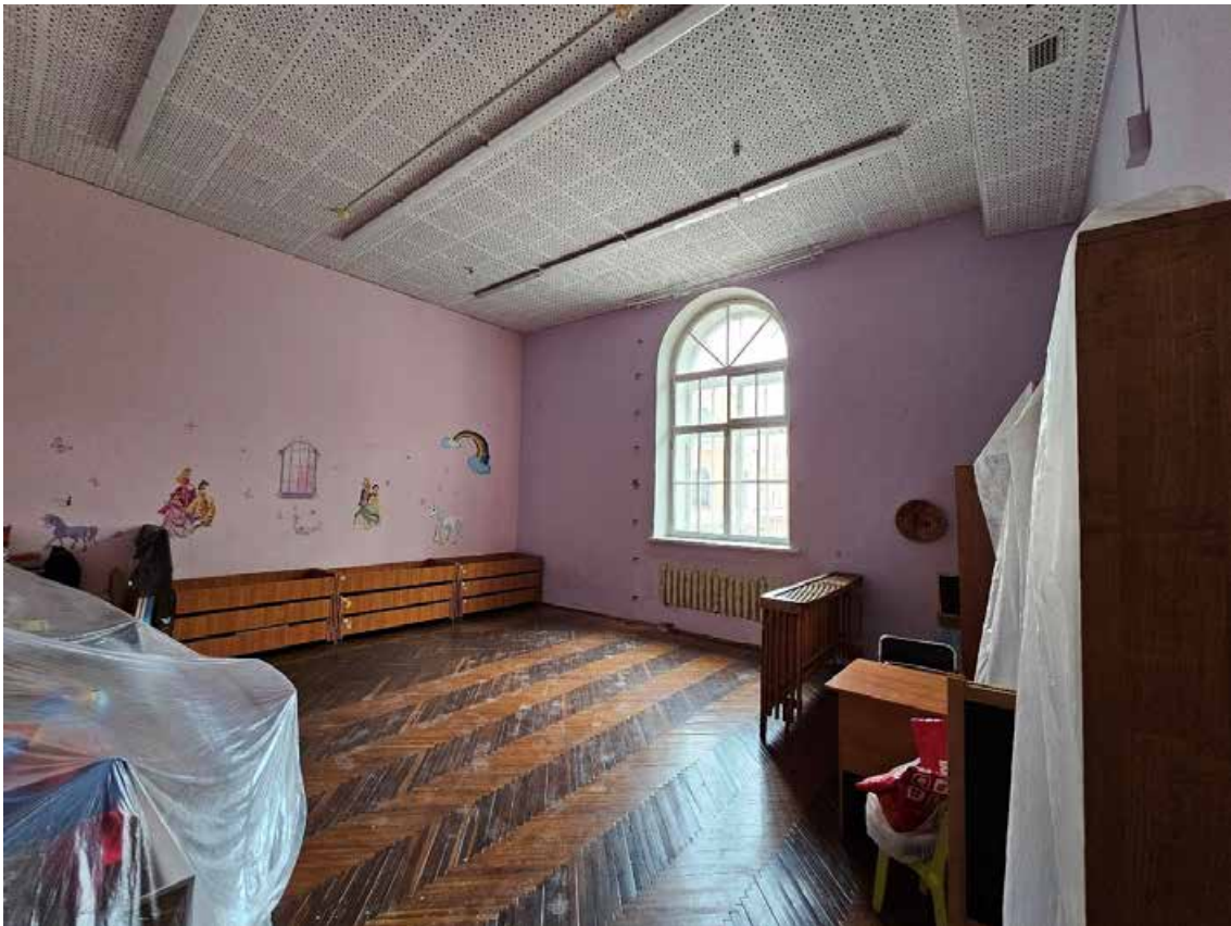
130. Объект культурного наследия регионального значения «Павловский институт с территорией, садом и оградой», по адресу: г. Санкт-Петербург, ул. Восстания, д. 8, лит. А. Общий вид пом. 13-Н (16) в уровне 2-го этажа.
