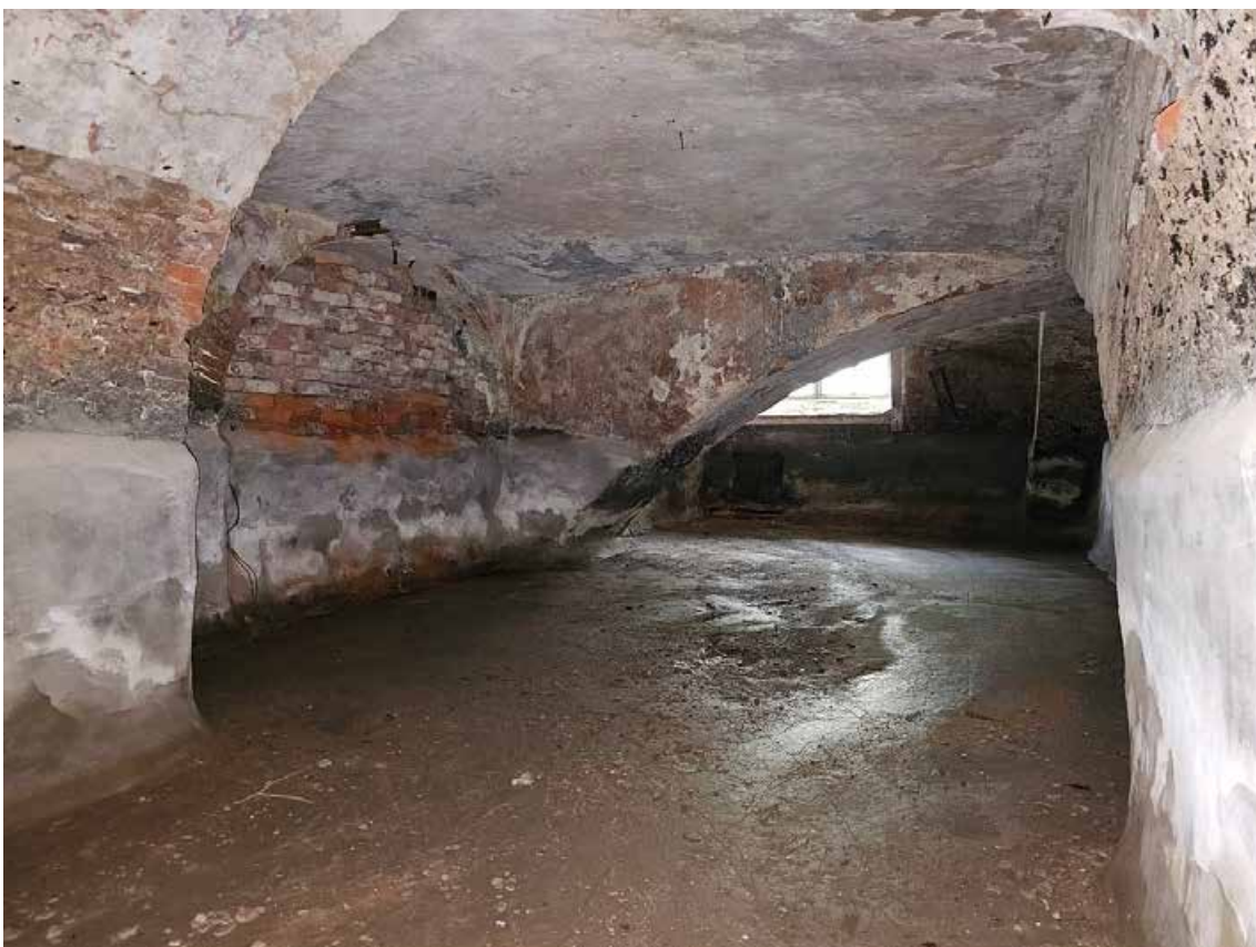
25. Объект культурного наследия регионального значения «Павловский институт с территорией, садом и оградой», по адресу: г. Санкт-Петербург, ул. Восстания, д. 8, лит. А. Общий вид пом. 4-Н (5) в уровне подвала.
