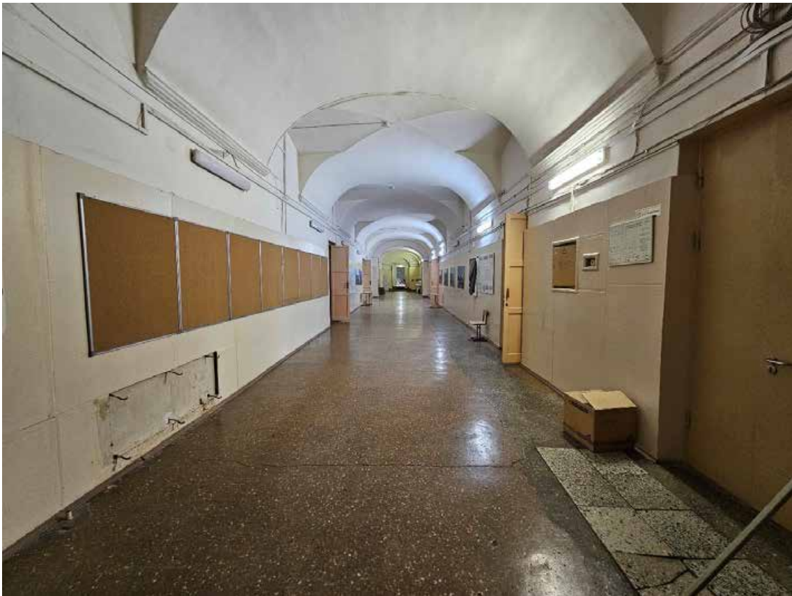
64. Объект культурного наследия регионального значения «Павловский институт с территорией, садом и оградой», по адресу: г. Санкт-Петербург, ул. Восстания, д. 8, лит. А. Общий вид пом. 5-Н (65) в уровне 1-го этажа.
