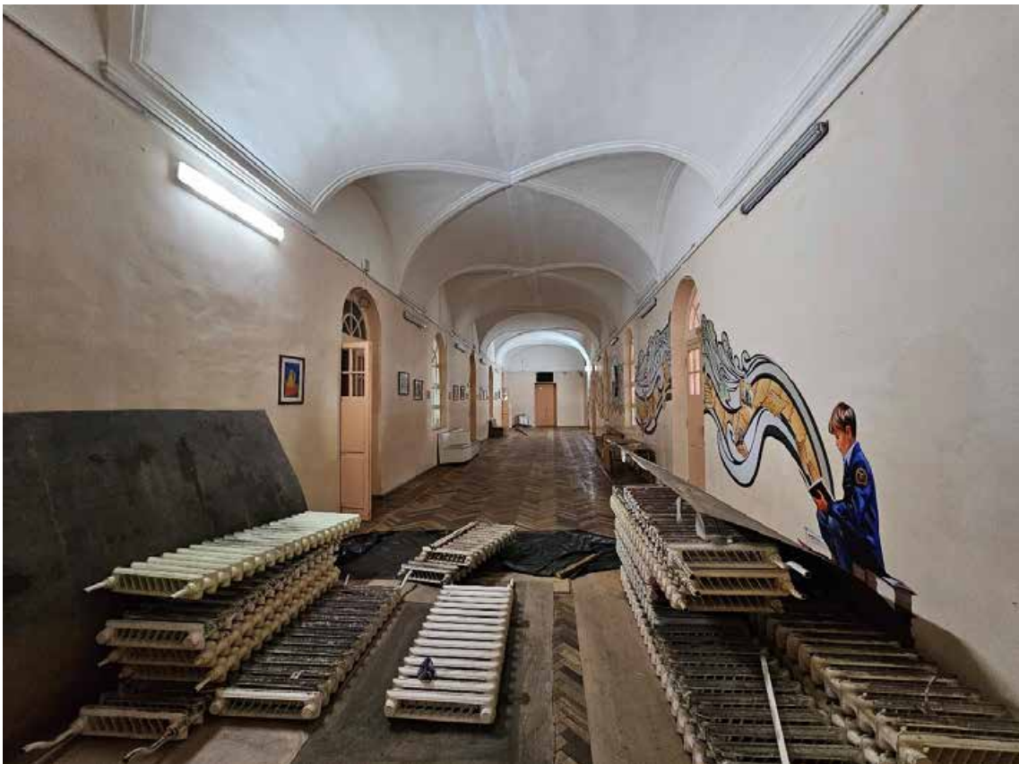
170. Объект культурного наследия регионального значения «Павловский институт с территорией, садом и оградой», по адресу: г. Санкт-Петербург, ул. Восстания, д. 8, лит. А. Общий вид пом. 11-Н (27) в уровне 3-го этажа.
