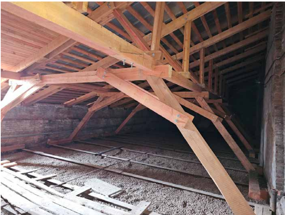
213. Объект культурного наследия регионального значения «Павловский институт с территорией, садом и оградой», по адресу: г. Санкт-Петербург, ул. Восстания, д. 8, лит. А. Фрагмент конструкции крыши в южной части лицевого корпуса.
