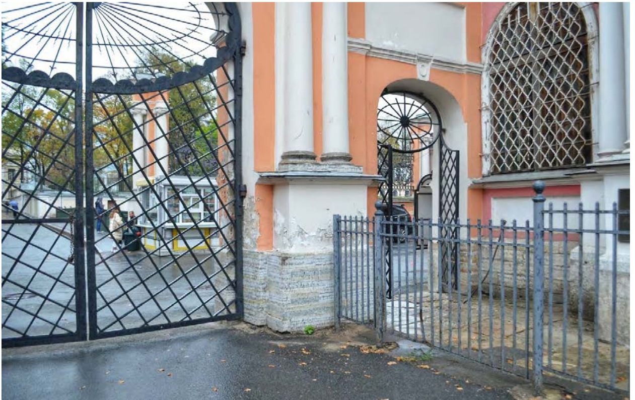
Фото 54. ОКН федерального значения «Корпус просфорный с северными воротами главного двора» (наб. реки Монастырки, дом 1, литера Г). Ворота. Фрагмент. Съёмка 28.10.2020 г.
