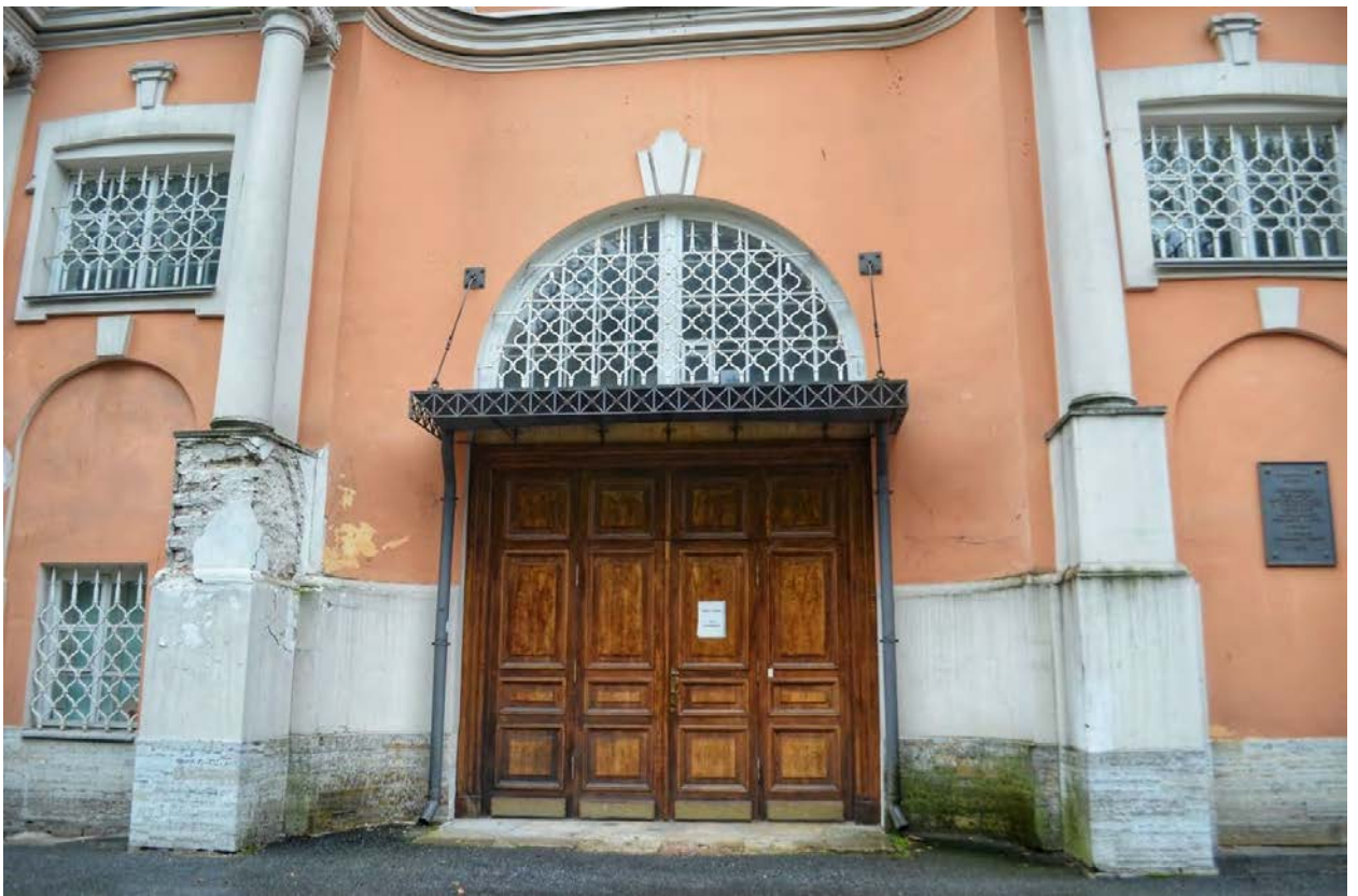
Фото 15. ОКН федерального значения «Корпус просфорный с северными воротами главного двора» (наб. реки Монастырки, дом 1, литера Г). Северо-западный фасад. Фрагмент. Съёмка 28.10.2020 г.
