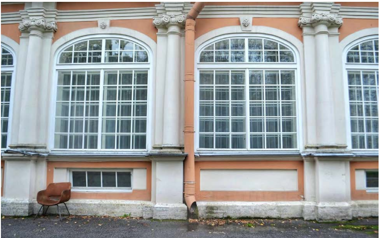
Фото 38. ОКН федерального значения «Корпус просфорный с северными воротами главного двора» (наб. реки Монастырки, дом 1, литера Г). Юго-восточный фасад. Оконные проёмы. Фрагмент. Съёмка 28.10.2020 г.
