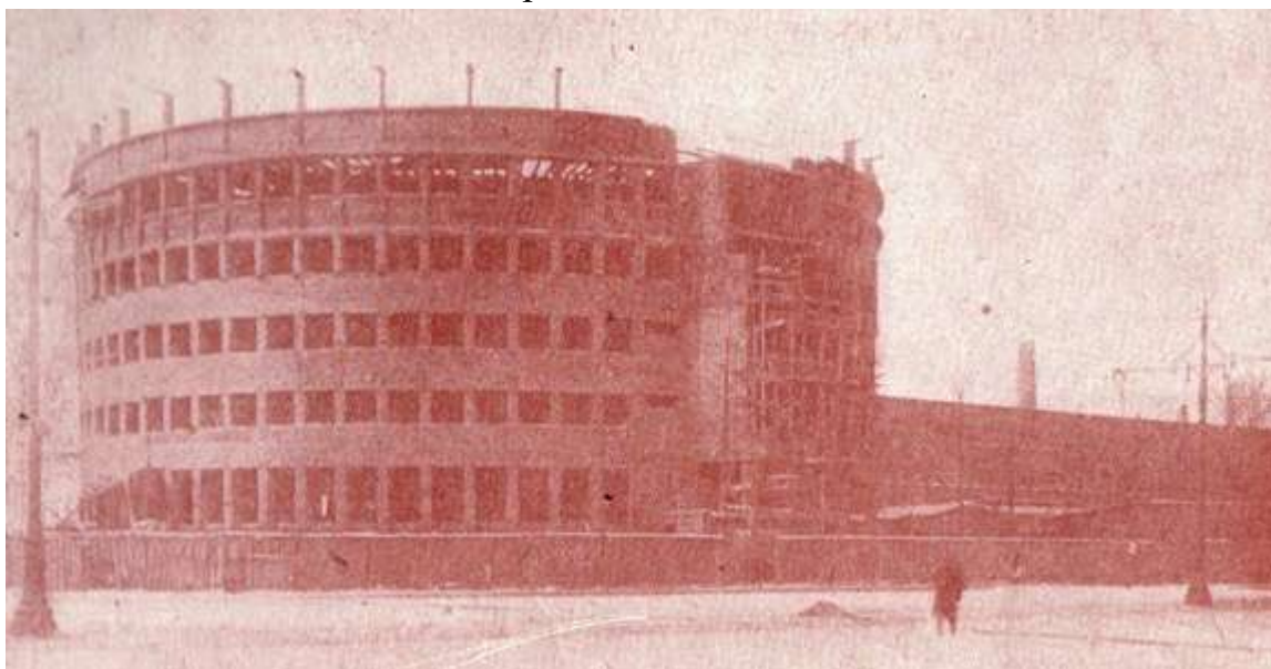
32. Строительство Дома Советов Московского района. 1931–1933 гг. Ленинград. Московский район. В борьбе за образцовый: Моск. район от 2 к 3 райпартконф-ции 1931-1933 гг./Фото-альбом сост. И.В. Михайлов, Г.С. Леви; текст альбома дан А.С. и В.С. Животовыми. Л.: 1 тип. Изд-ва Ленингр. облисполкома и Ленсовета, 1934
