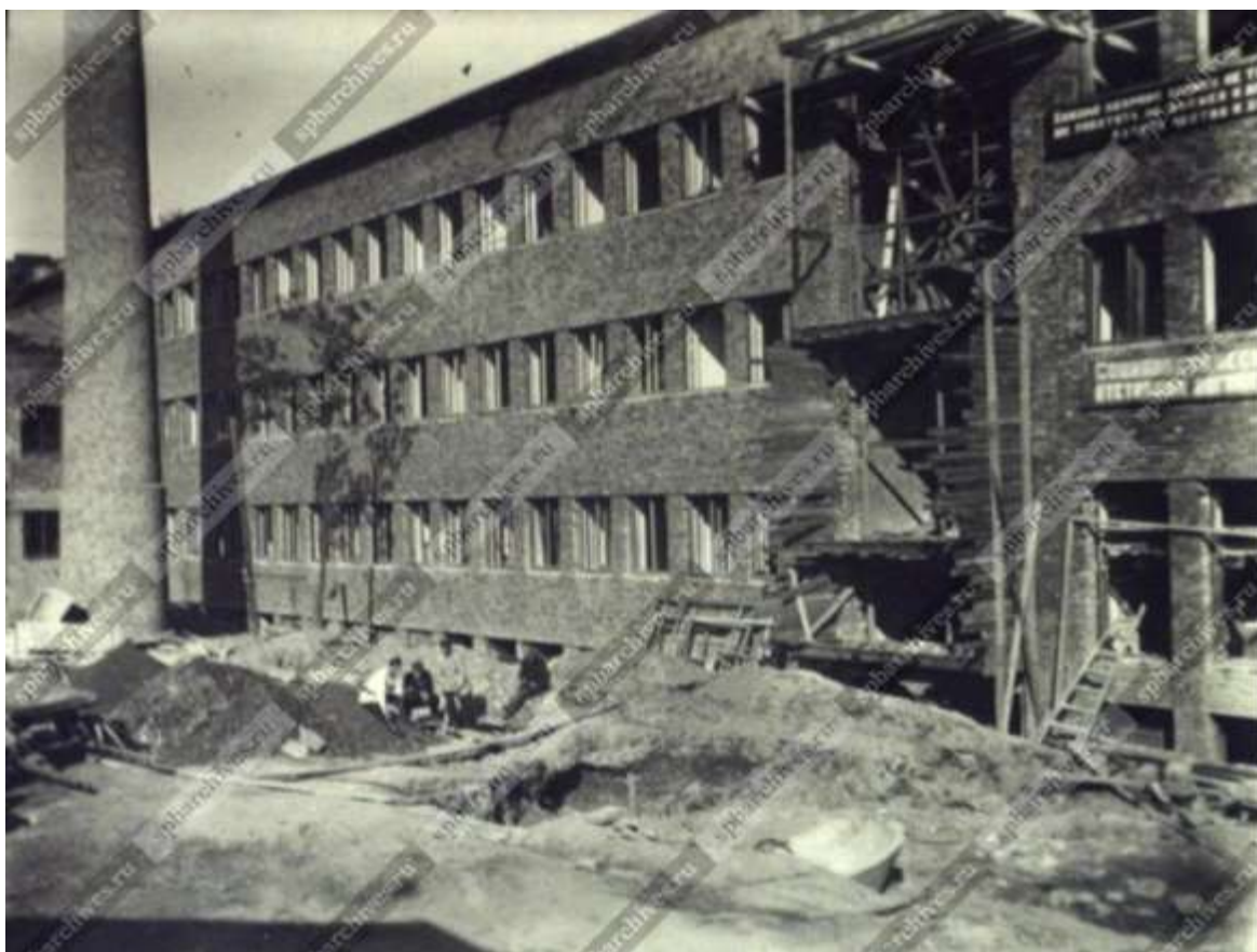
37. Строительство здания Московского райсовета на Московском проспекте, д.129. 1932-1933 г. ЦГАКФФД СПб. Фотодокументы. Оп.1ВР-53. Ед.хр.77379
