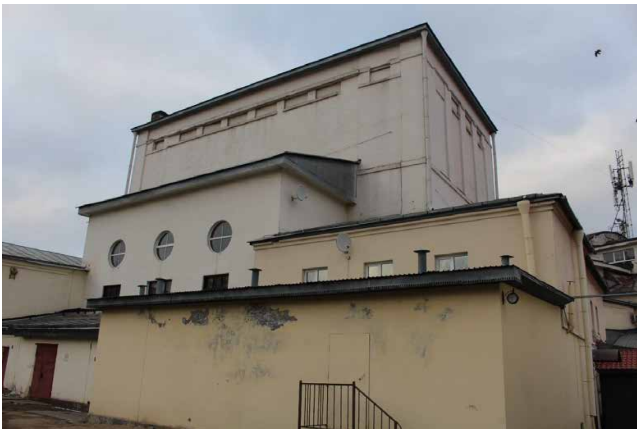
Фото 25. Вид на юго-западный фасад Дома культуры выявленного объекта культурного наследия «Дом культуры текстильщиков (Дворец культуры им. Н.К. Крупской) (с флигелем)».
