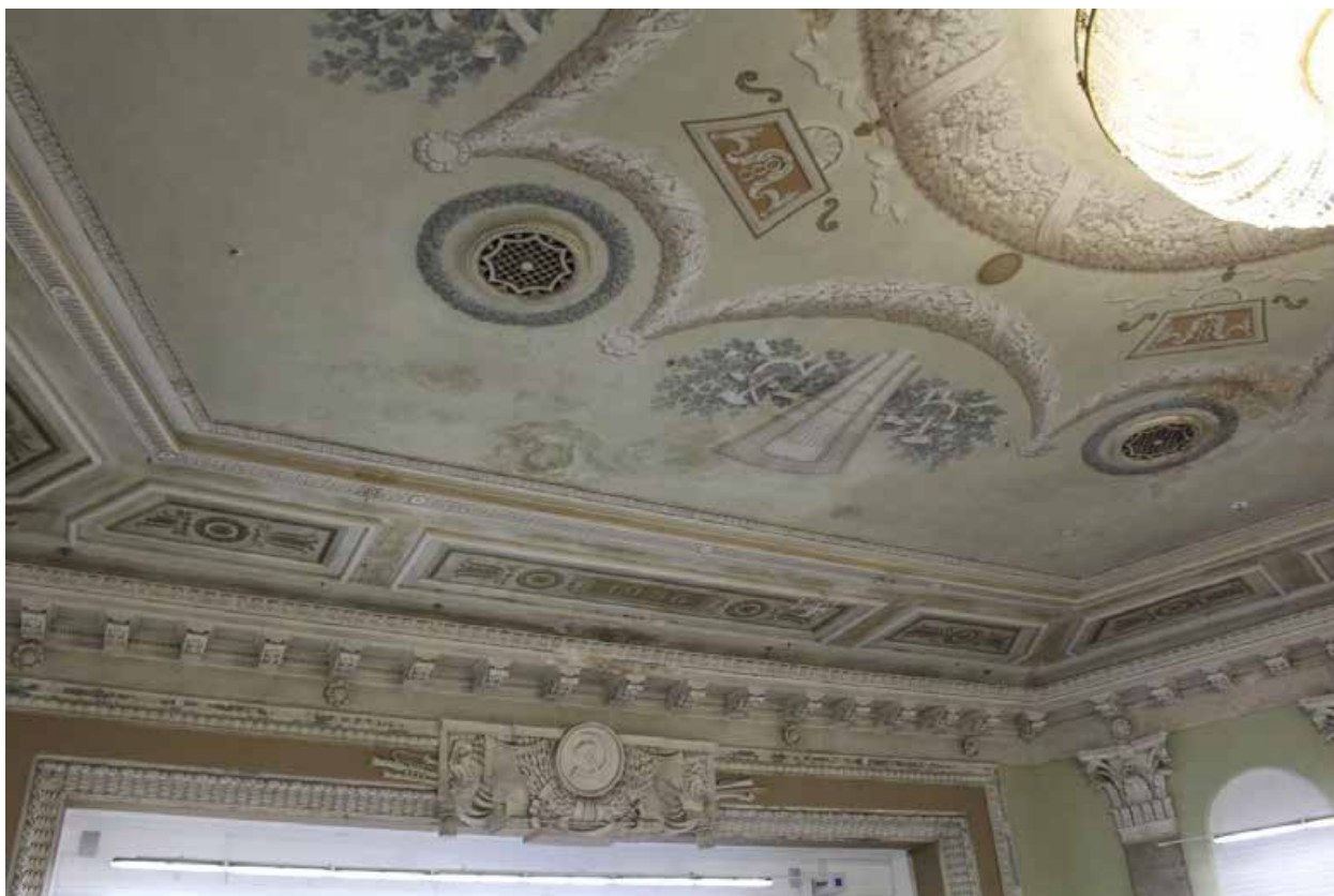
Фото 101. Внутренние помещения 2-го этажа выявленного объекта культурного наследия «Дом культуры текстильщиков (Дворец культуры им. Н.К. Крупской) (с флигелем)». Помещение 11-Н(66) пл. 297,1 кв. м.
