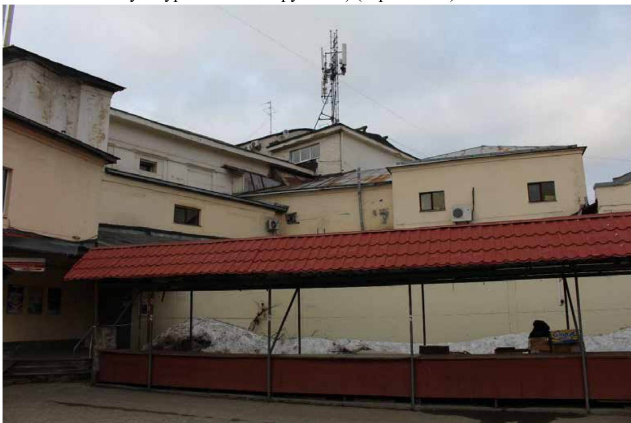
Фото 22. Вид на поздние пристройки к Дому культуры и Флигелю выявленного объекта культурного наследия «Дом культуры текстильщиков (Дворец культуры им. Н.К. Крупской) (с флигелем)» с юга.
