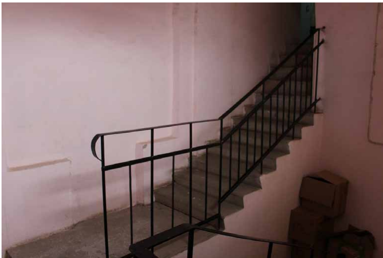
Фото 68. Внутренние помещения выявленного объекта культурного наследия «Дом культуры текстильщиков (Дворец культуры им. Н.К. Крупской) (с флигелем)». Служебная многомаршевая лестница в северо-западной части Дома культуры (помещение 11-Н(33) пл. 11,0 кв. м) в уровне 2-го этажа.
