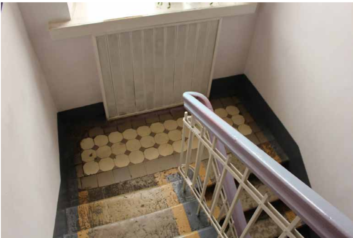
Фото 125. Внутренние помещения выявленного объекта культурного наследия «Дом культуры текстильщиков (Дворец культуры им. Н.К. Крупской) (с флигелем)». Восточная служебная лестница Дома культуры в уровне 1-го – 2-го этажей (помещение 11-Н(81) пл. 12,4 кв. м).
