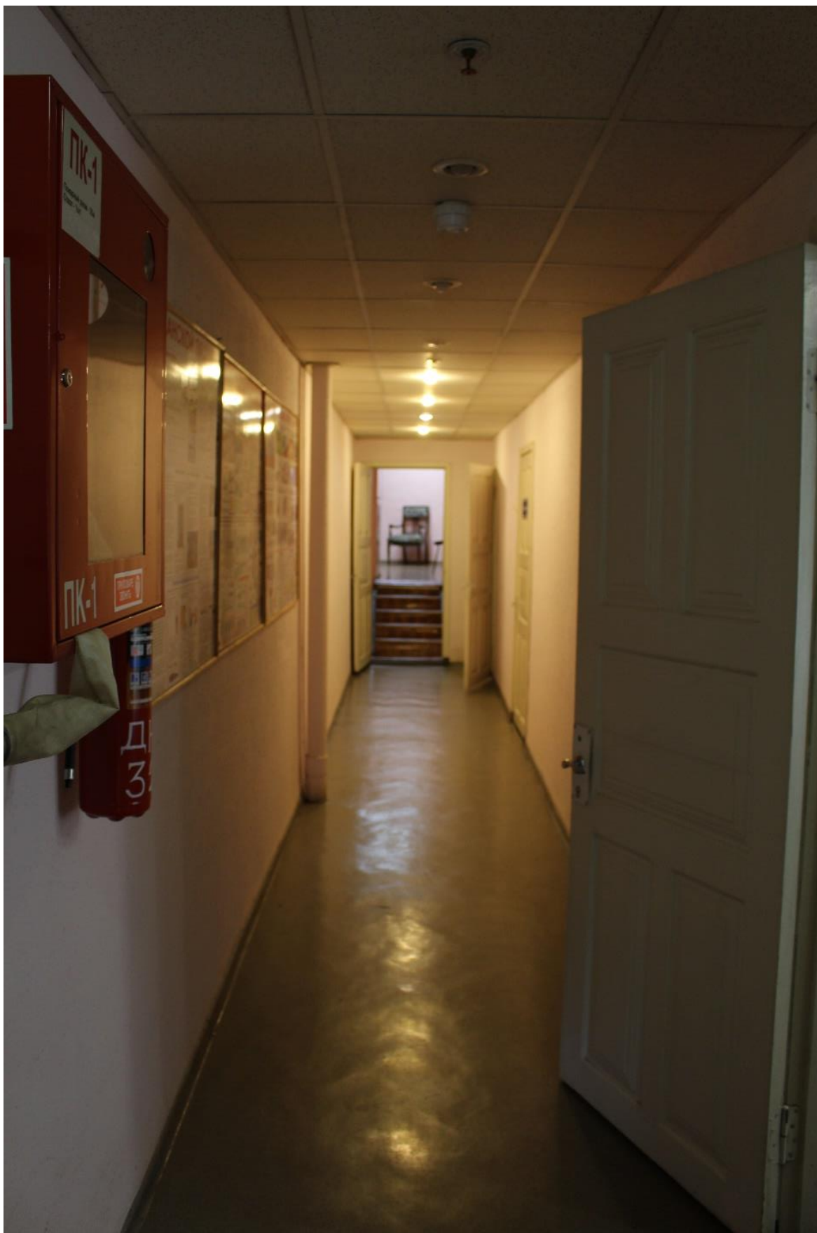
Фото 128. Внутренние помещения 2-го этажа выявленного объекта культурного наследия «Дом культуры текстильщиков (Дворец культуры им. Н.К. Крупской) (с флигелем)». Помещение 11-Н(24) пл. 16,3 кв. м.
