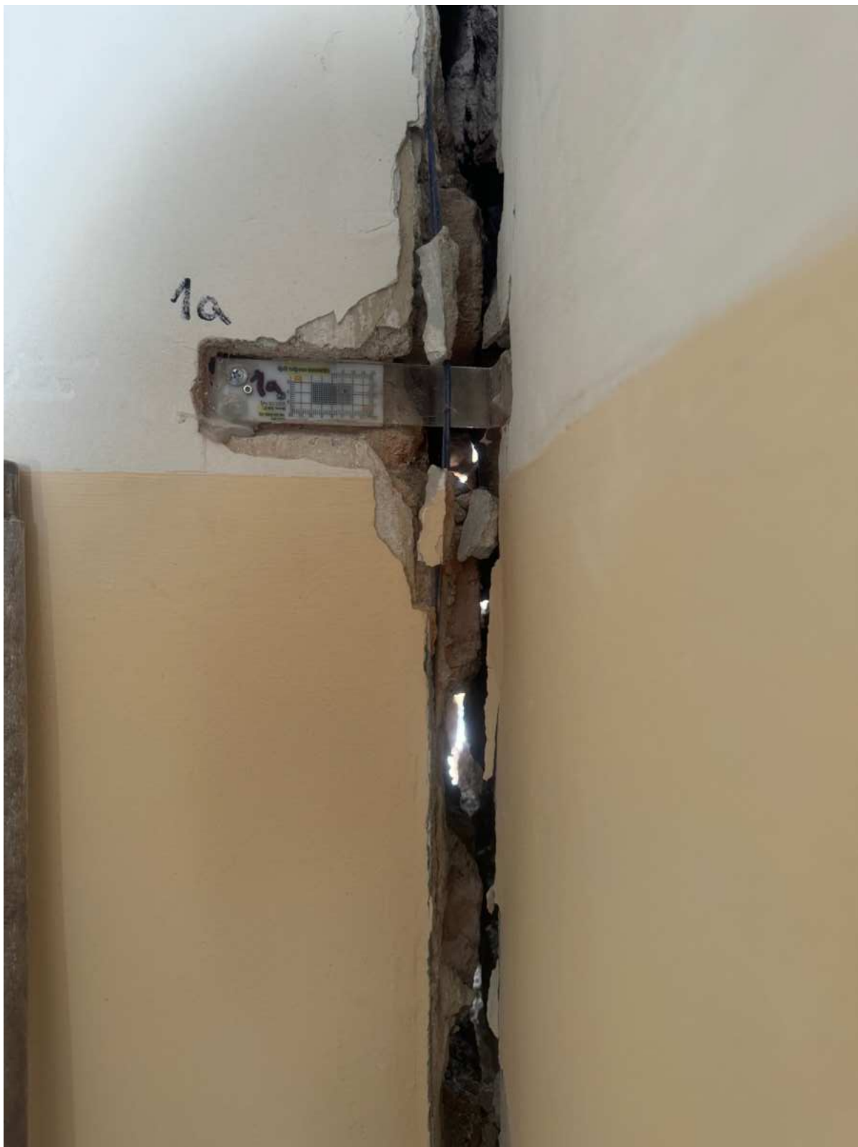
108. Строительный маяк на трещину в части лестницы 4ЛК объекта культурного наследия.
