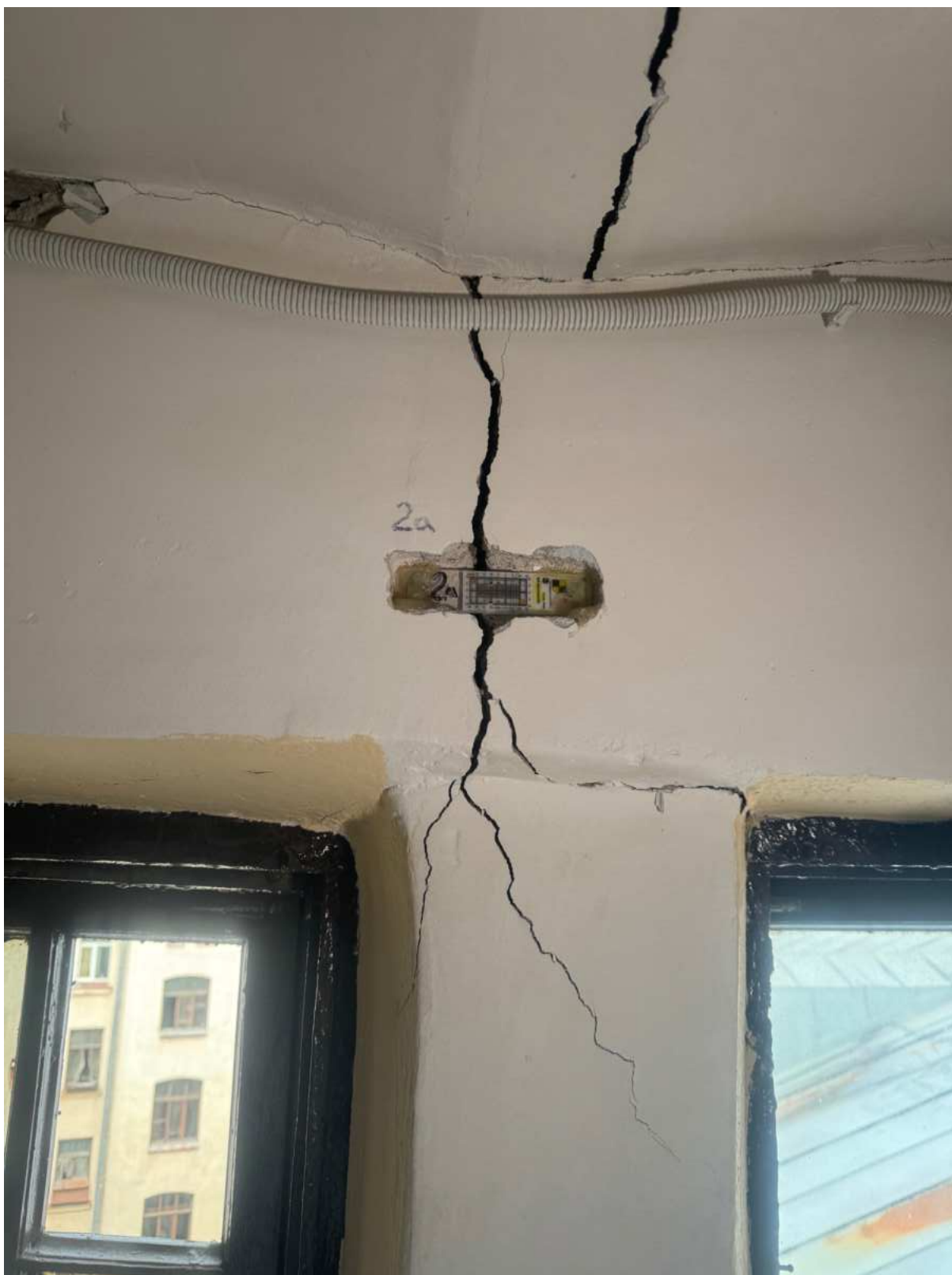
106. Строительный маяк на трещину в части лестницы 4ЛК объекта культурного наследия.
