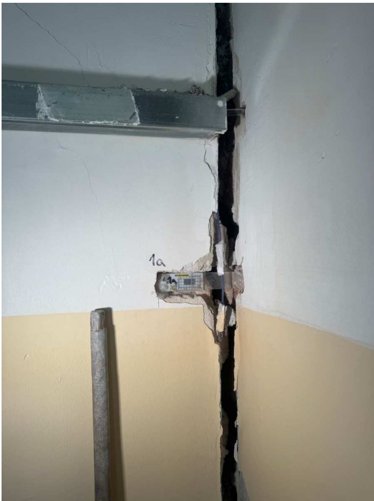
107. Строительный маяк на трещину в части лестницы 4ЛК объекта культурного наследия.
