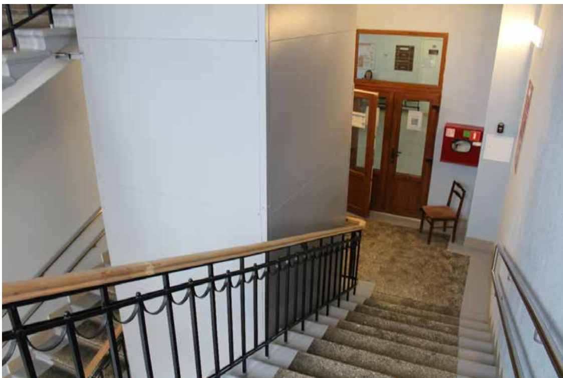
Фото 39. Вид на главную лестницу в центральной части Ш-образного объема в уровне 3-го этажа (помещение 1-Н(78)) выявленного объекта культурного наследия «Здание Общества железопрокатного и проволочного заводов (с металлическими оградами)».
