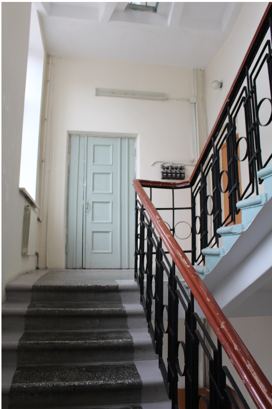
Фото 47. Вид на западную лестницу в уровне 3-го этажа (помещение 1-Н(87) выявленного объекта культурного наследия «Здание Общества железопрокатного и проволочного заводов (с металлическими оградами)»).
