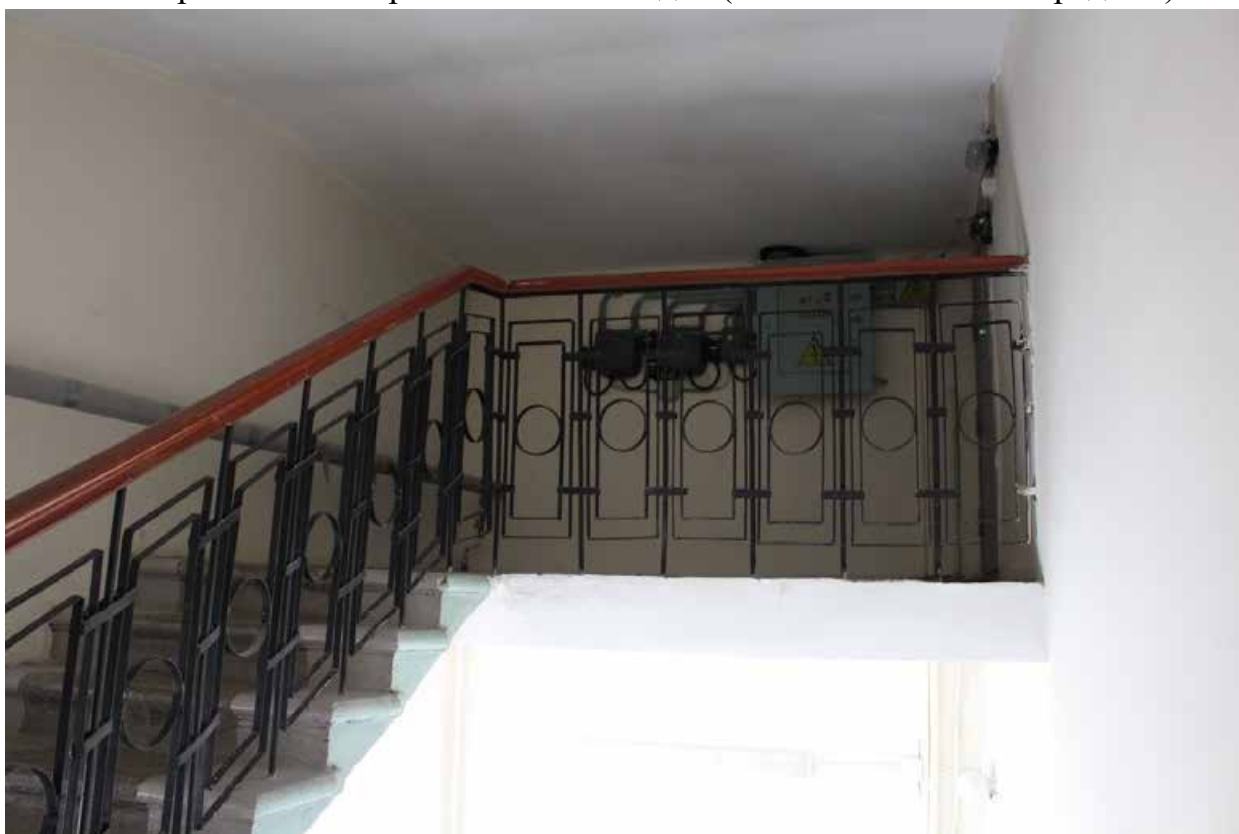
Фото 49. Вид на западную лестницу в уровне чердачного этажа (помещение 1-Н(117) выявленного объекта культурного наследия «Здание Общества железопрокатного и проволочного заводов (с металлическими оградами)»).
