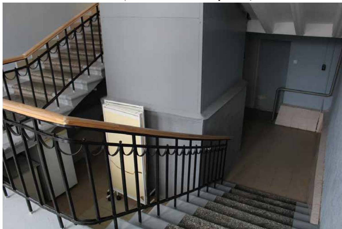
Фото 34. Вид на главную лестницу в центральной части Ш-образного объема в уровне подвального этажа (помещение 1-Н(140) выявленного объекта культурного наследия «Здание Общества железопрокатного и проволочного заводов (с металлическими оградами)»).
