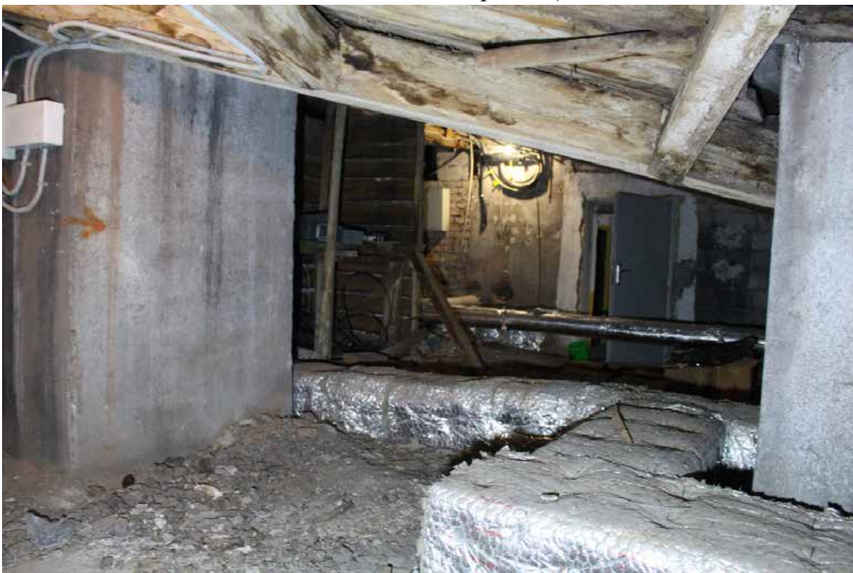
Фото 63. Чердачные помещения выявленного объекта культурного наследия «Здание Общества железопрокатного и проволочного заводов (с металлическими оградами)».
