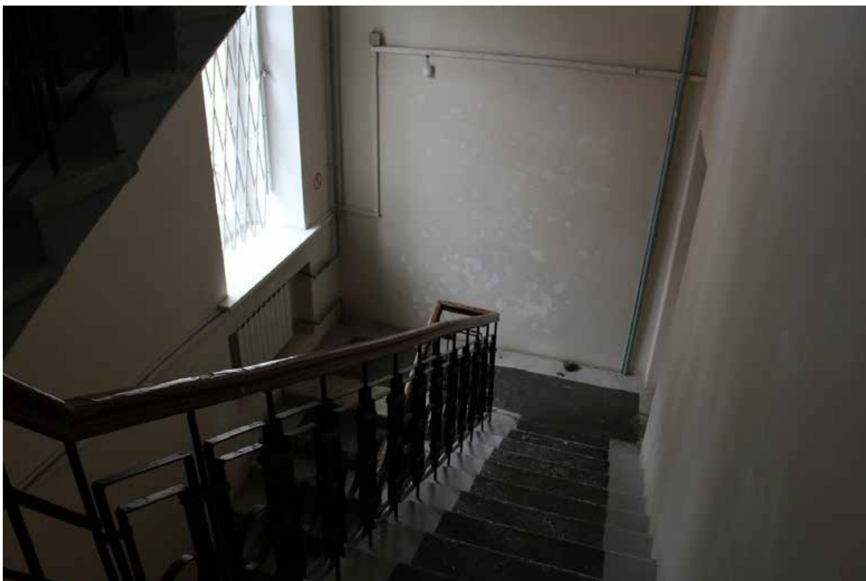
Фото 45. Вид на западную лестницу в уровне 2-го этажа (помещение 1-Н(44) выявленного объекта культурного наследия «Здание Общества железопрокатного и проволочного заводов (с металлическими оградами)»).
