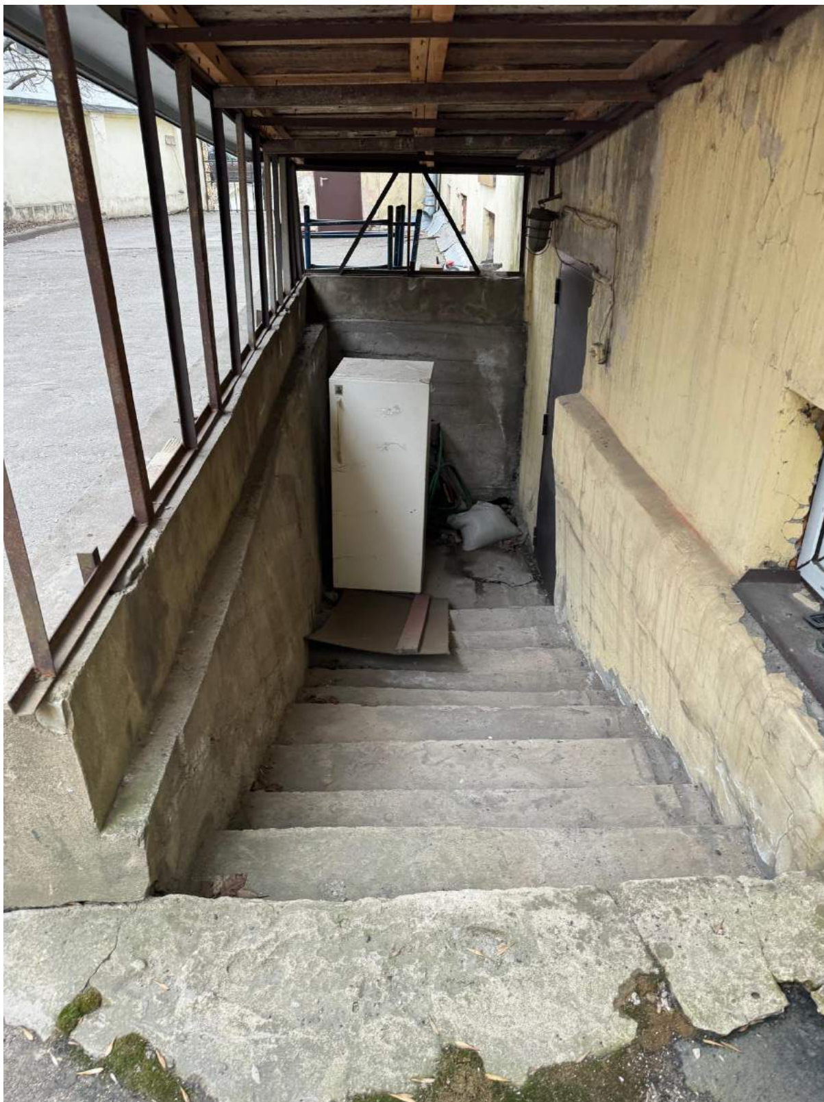
16. Лестница при двореом фасаде объекта культурного наследия «Главное здание» с дворовой территории.
