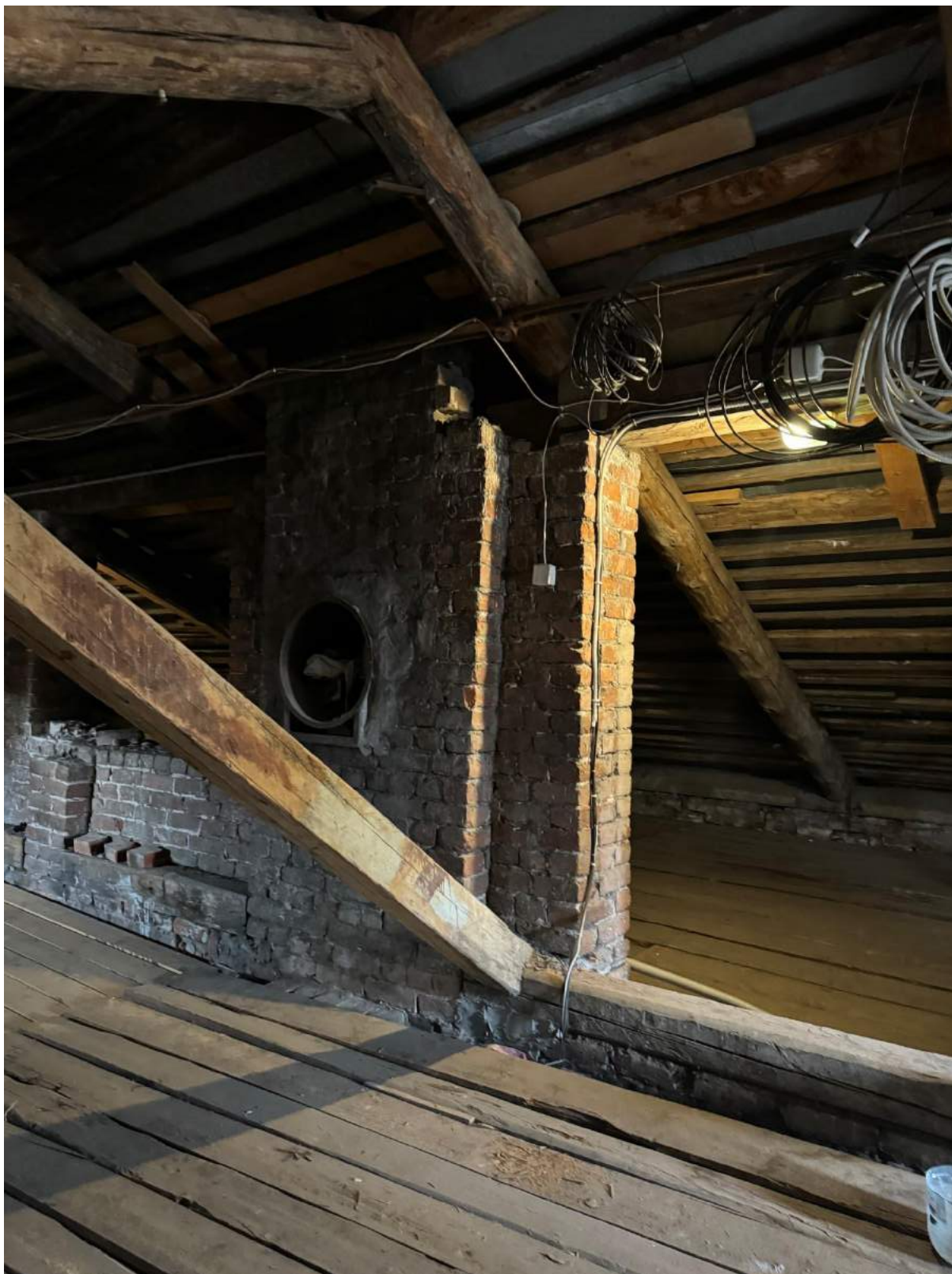
106. Вид на чердачное помещение выявленного объекта культурного наследия «Корпус для подопытных животных».
