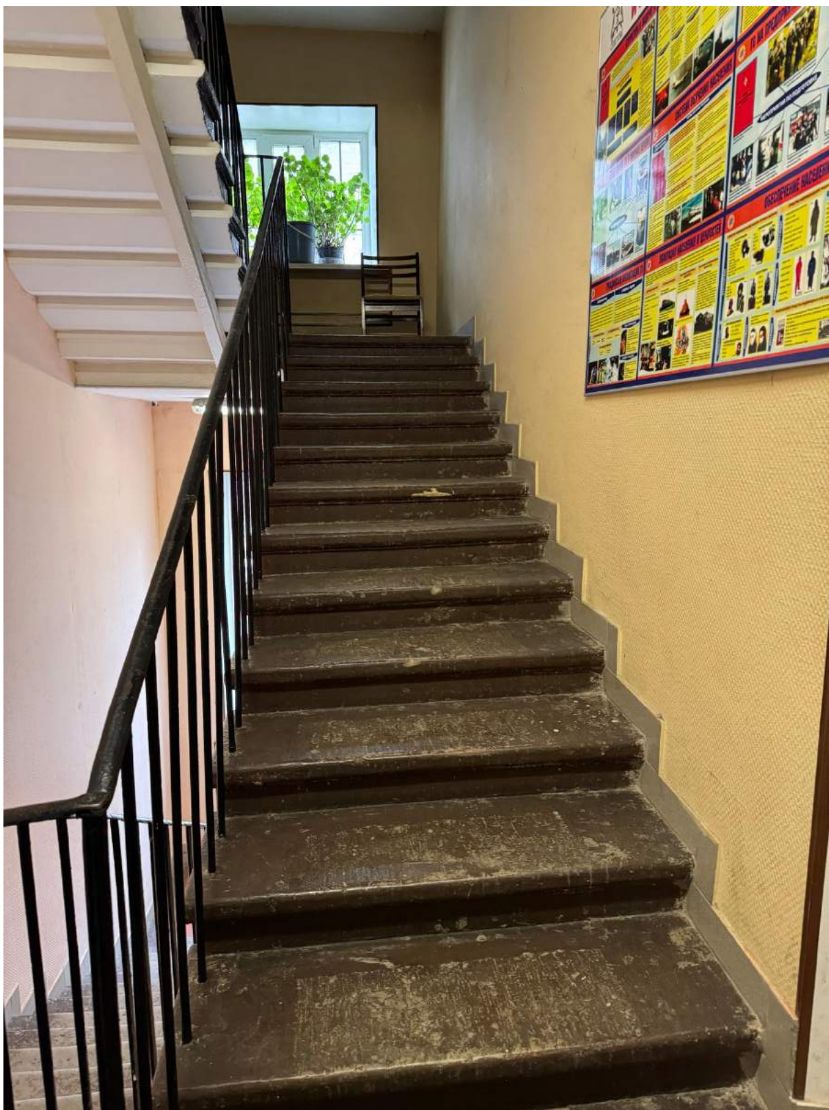
70. Вид на лестницу в помещении 1-Н(47) выявленного объекта культурного наследия «Главное здание».
