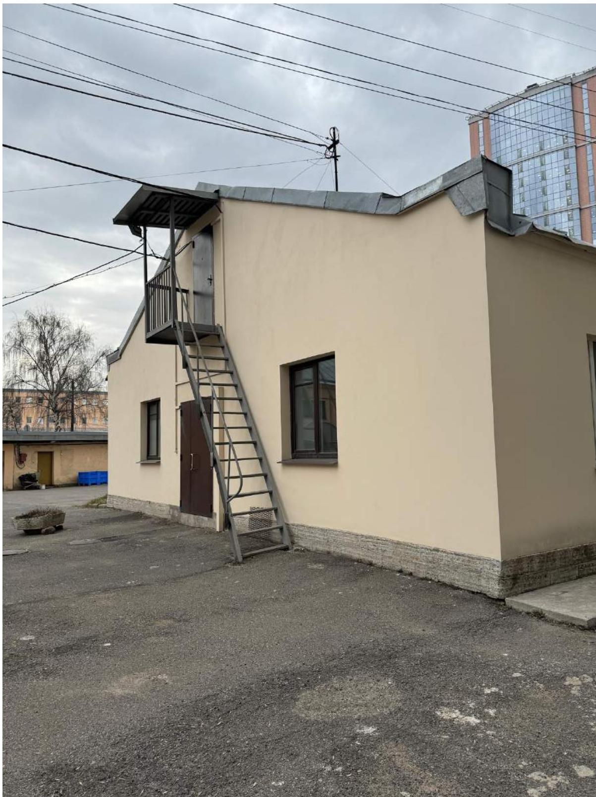
33. Фрагмент фасада объекта культурного наследия «Корпус для подопытных животных» с дворовой территории.
