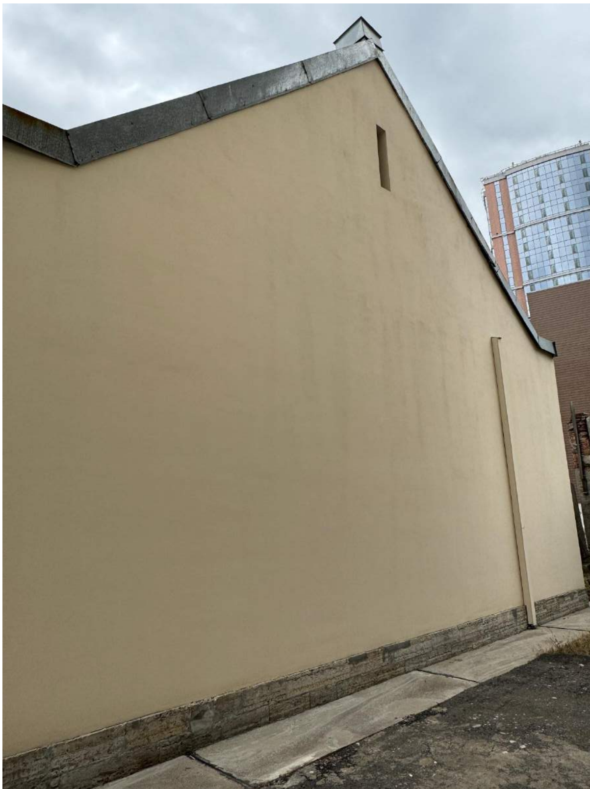
34. Фрагмент фасада объекта культурного наследия «Корпус для подопытных животных» с дворовой территории.
