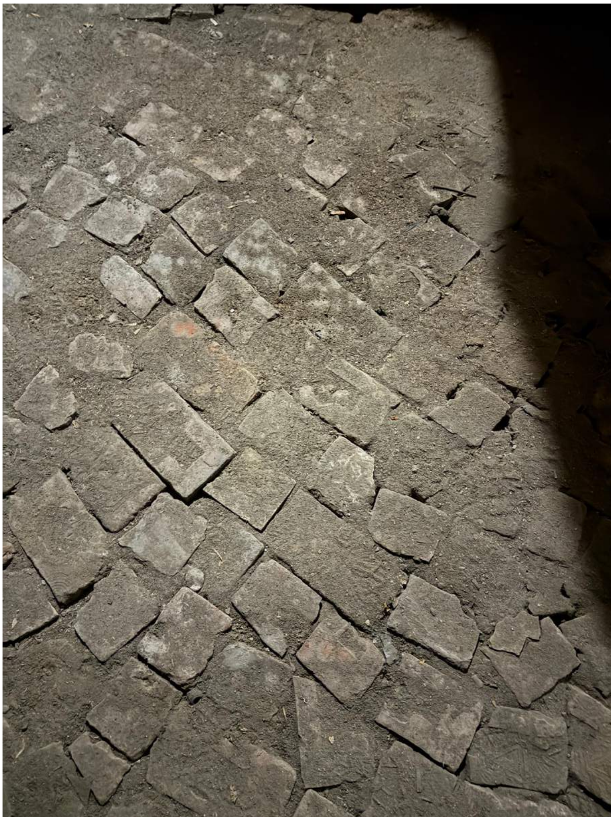
83. Брусчатка в части сводов в чердачных помещениях выявленного объекта культурного наследия «Главное здание».
