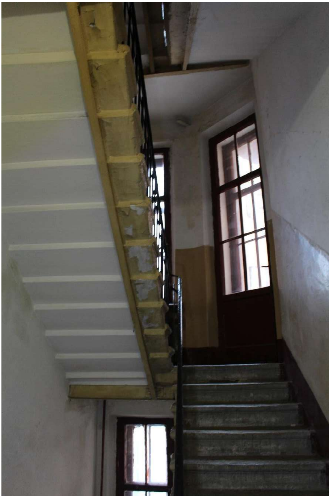
Фото 170. Выявленный объект культурного наследия «Дом Второго Санкт-Петербургского товарищества для устройства постоянных квартир (с курдонером, палисадниками и оградой)». Лестничная клетка БЛК в уровне 3-го этажа.
