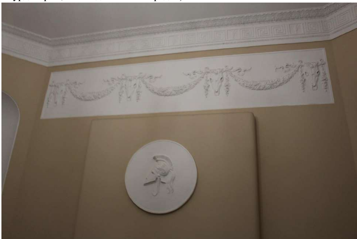
Фото 65. Выявленный объект культурного наследия «Дом Второго Санкт-Петербургского товарищества для устройства постоянных квартир (с курдонером, палисадниками и оградой)». Вестибюль лестничной клетки 1ЛК.
