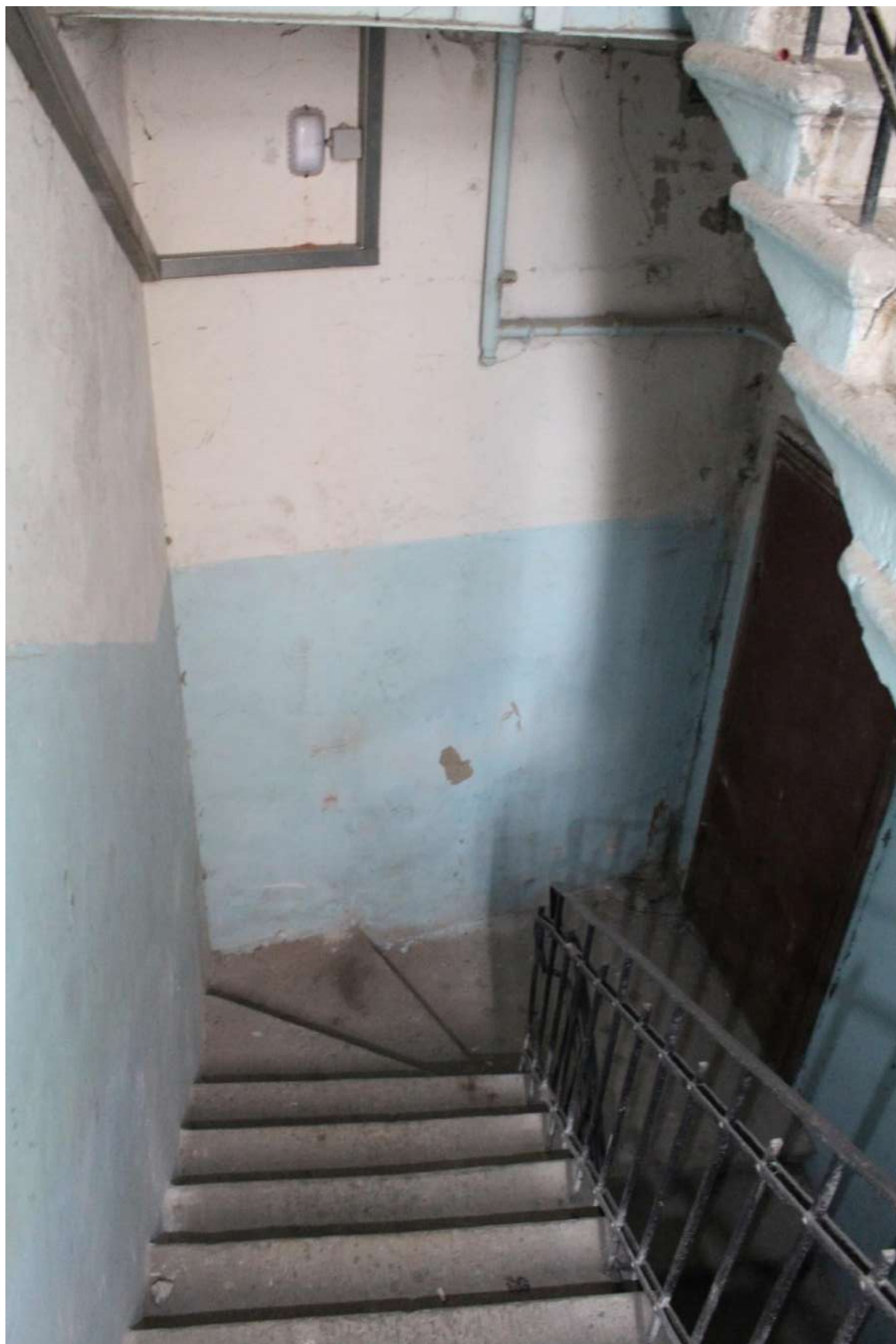
Фото 222. Выявленный объект культурного наследия «Дом Второго Санкт-Петербургского товарищества для устройства постоянных квартир (с курдонером, палисадниками и оградой)». Лестничная клетка 10ЛК в уровне 1-го этажа.
