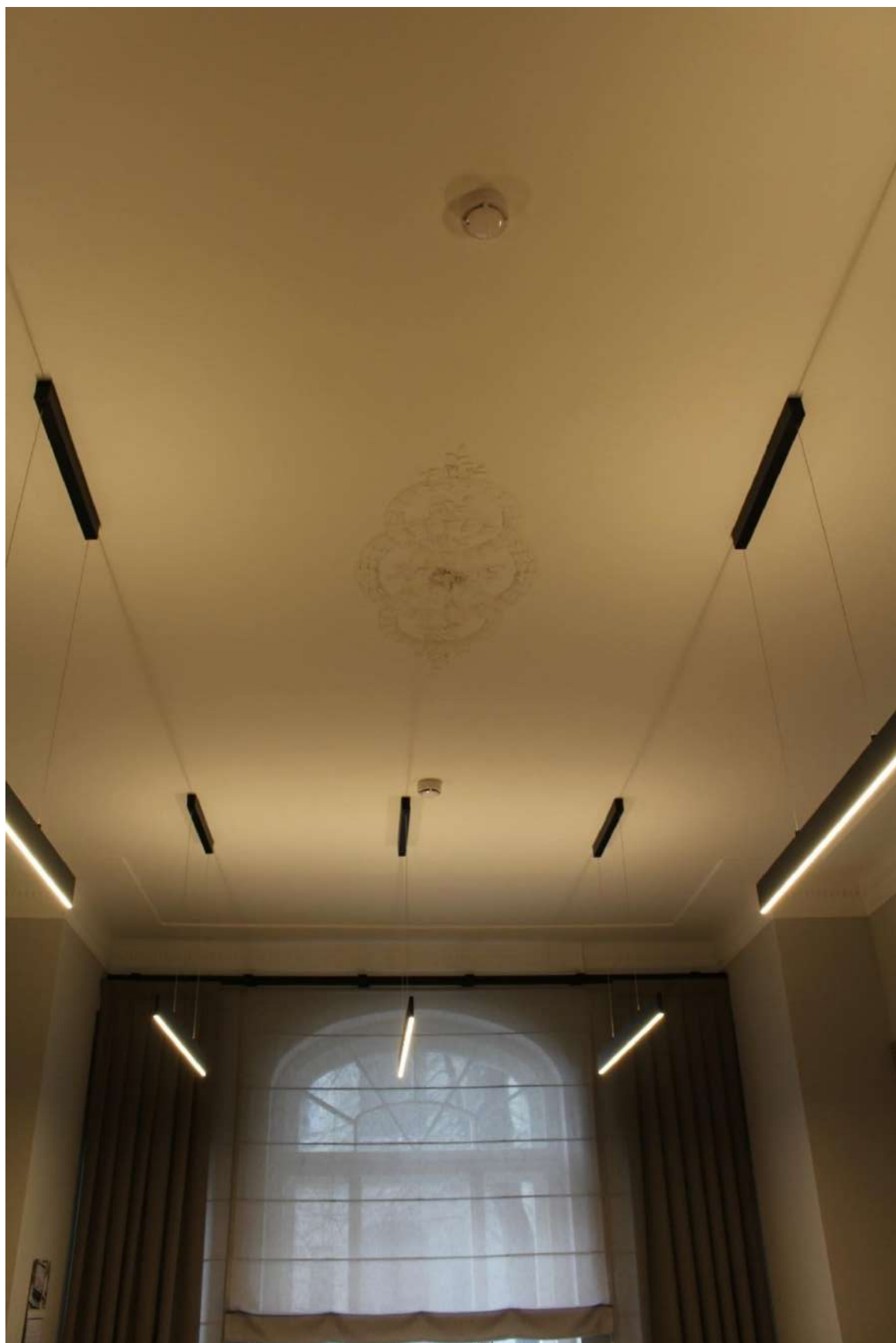
Фото 256. Выявленный объект культурного наследия «Дом Второго Санкт-Петербургского товарищества для устройства постоянных квартир (с курдонером, палисадниками и оградой)». Помещение 10-Н.
