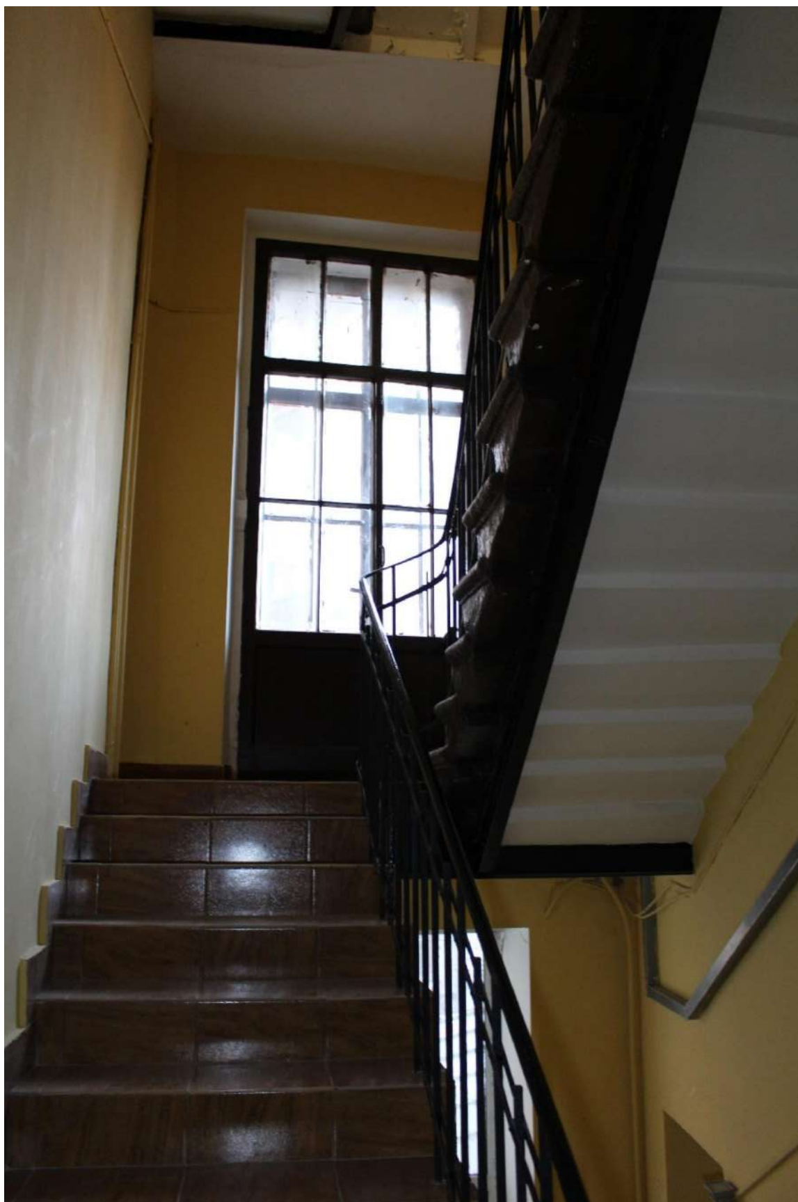
Фото 196. Выявленный объект культурного наследия «Дом Второго Санкт-Петербургского товарищества для устройства постоянных квартир (с курдонером, палисадниками и оградой)». Лестничная клетка 8ЛК в уровне 2-го – 3-го этажей.
