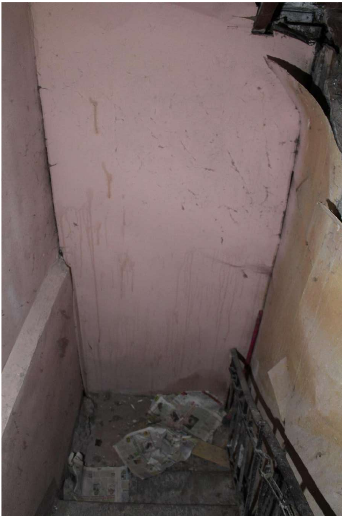
Фото 227. Выявленный объект культурного наследия «Дом Второго Санкт-Петербургского товарищества для устройства постоянных квартир (с курдонером, палисадниками и оградой)». Лестничная клетка 11ЛК в уровне 1-го этажа.
