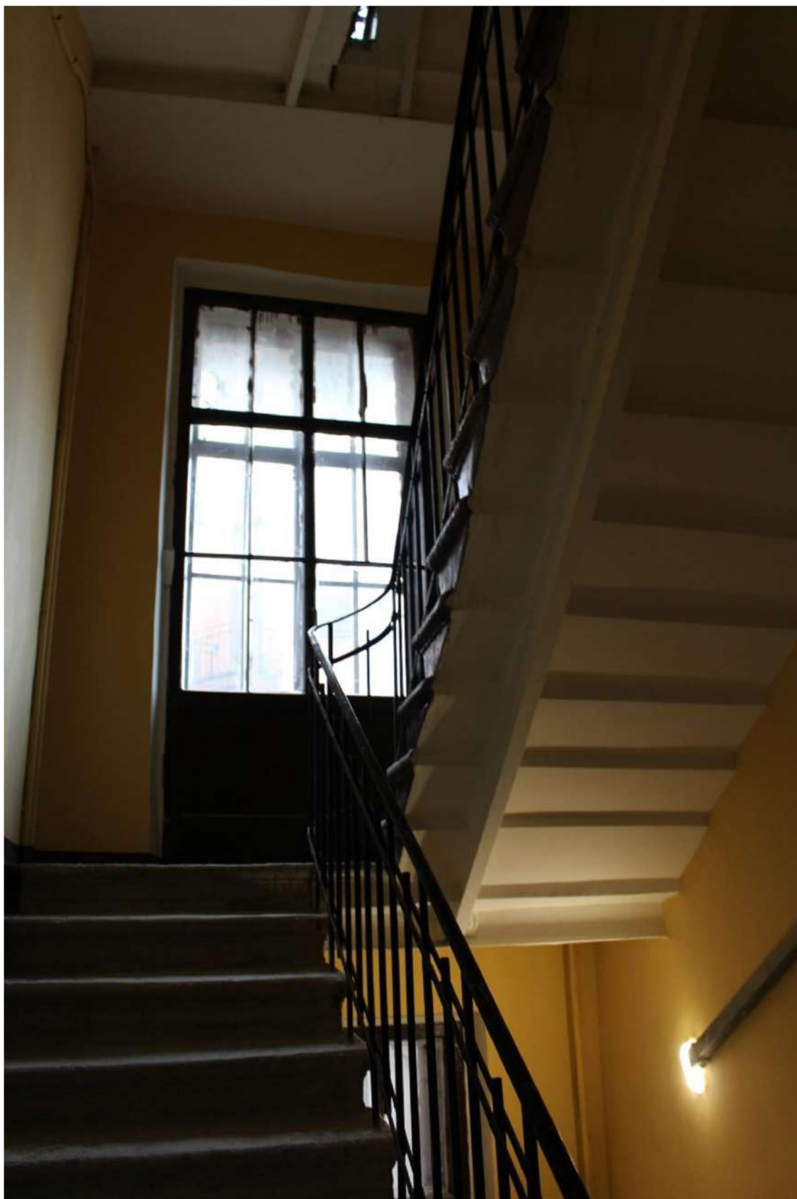
Фото 199. Выявленный объект культурного наследия «Дом Второго Санкт-Петербургского товарищества для устройства постоянных квартир (с курдонером, палисадниками и оградой)». Лестничная клетка 8ЛК в уровне 4-го – 5-го этажей.
