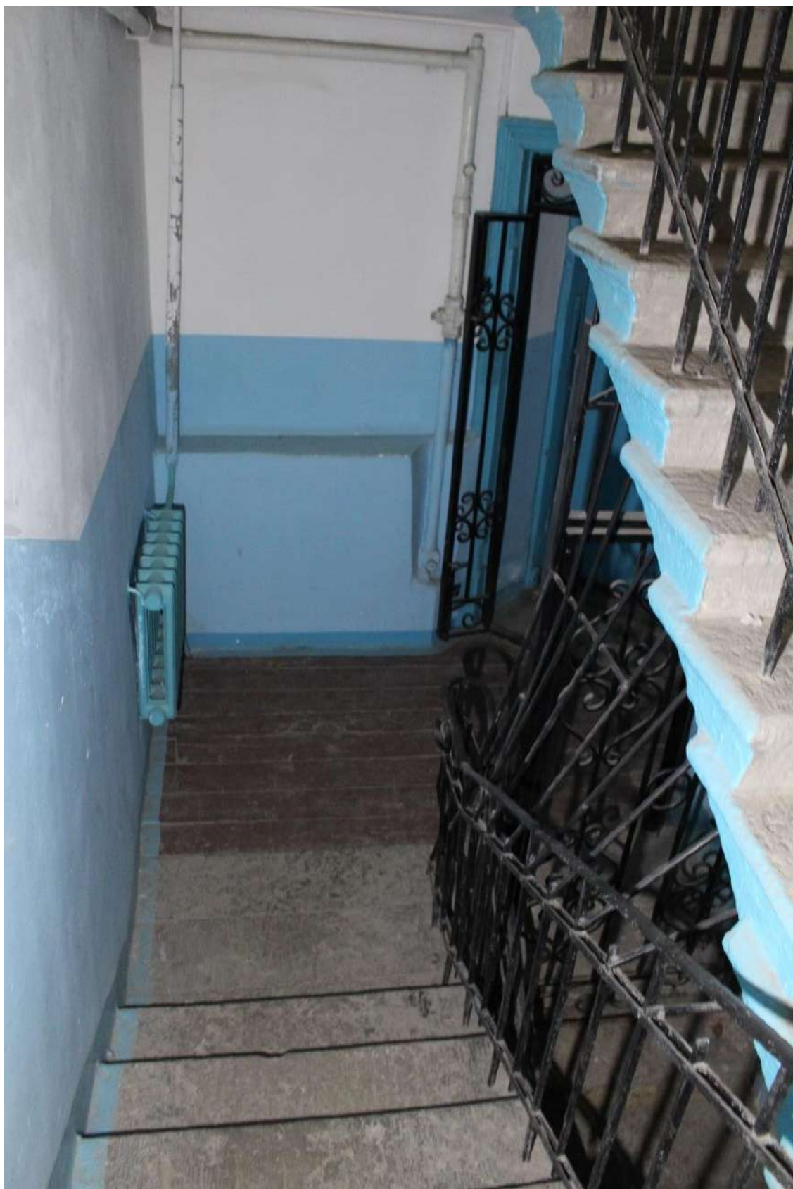
Фото 134. Выявленный объект культурного наследия «Дом Второго Санкт-Петербургского товарищества для устройства постоянных квартир (с курдонером, палисадниками и оградой)». Лестничная клетка ЗЛК в уровне 1-го этажа.
