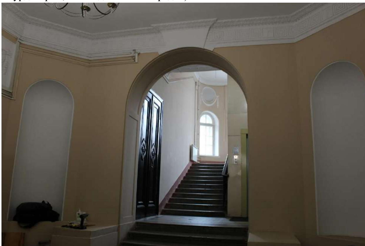
Фото 63. Выявленный объект культурного наследия «Дом Второго Санкт-Петербургского товарищества для устройства постоянных квартир (с курдонером, палисадниками и оградой)». Вестибюль лестничной клетки 1ЛК.
