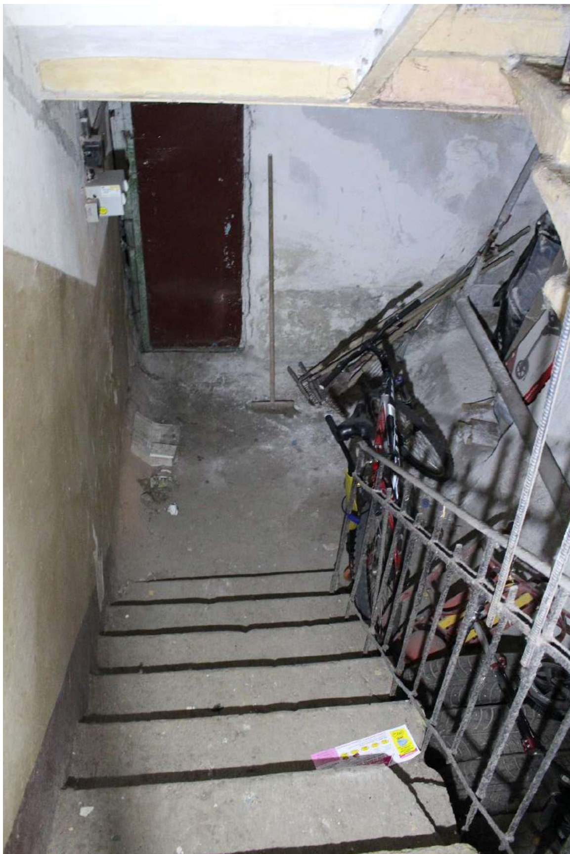
Фото 160. Выявленный объект культурного наследия «Дом Второго Санкт-Петербургского товарищества для устройства постоянных квартир (с курдонером, палисадниками и оградой)». Лестничная клетка БЛК в уровне 1-го этажа.
