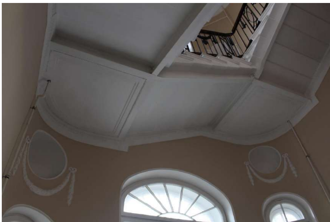
Фото 82. Выявленный объект культурного наследия «Дом Второго Санкт-Петербургского товарищества для устройства постоянных квартир (с курдонером, палисадниками и оградой)». Лестничная клетка 1ЛК в уровне 3-го - 4-го этажей.
