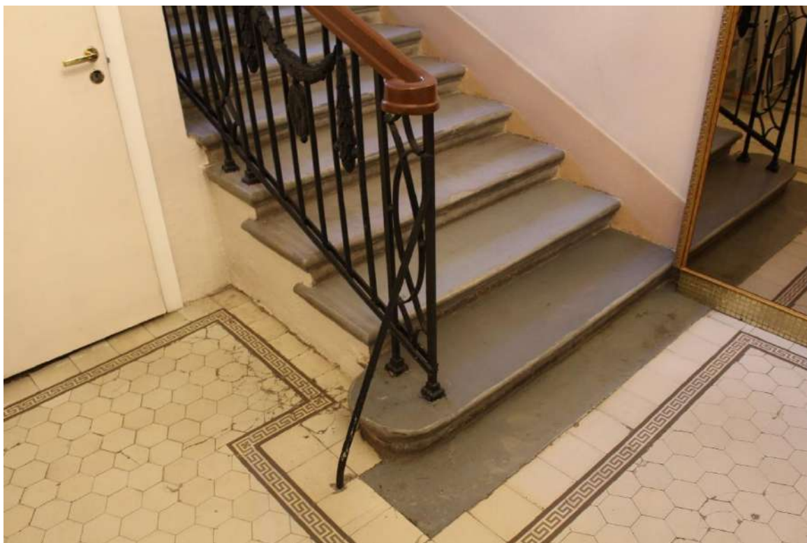
Фото 181. Выявленный объект культурного наследия «Дом Второго Санкт-Петербургского товарищества для устройства постоянных квартир (с курдонером, палисадниками и оградой)». Лестничная клетка 7ЛК в уровне 1-го этажа.
