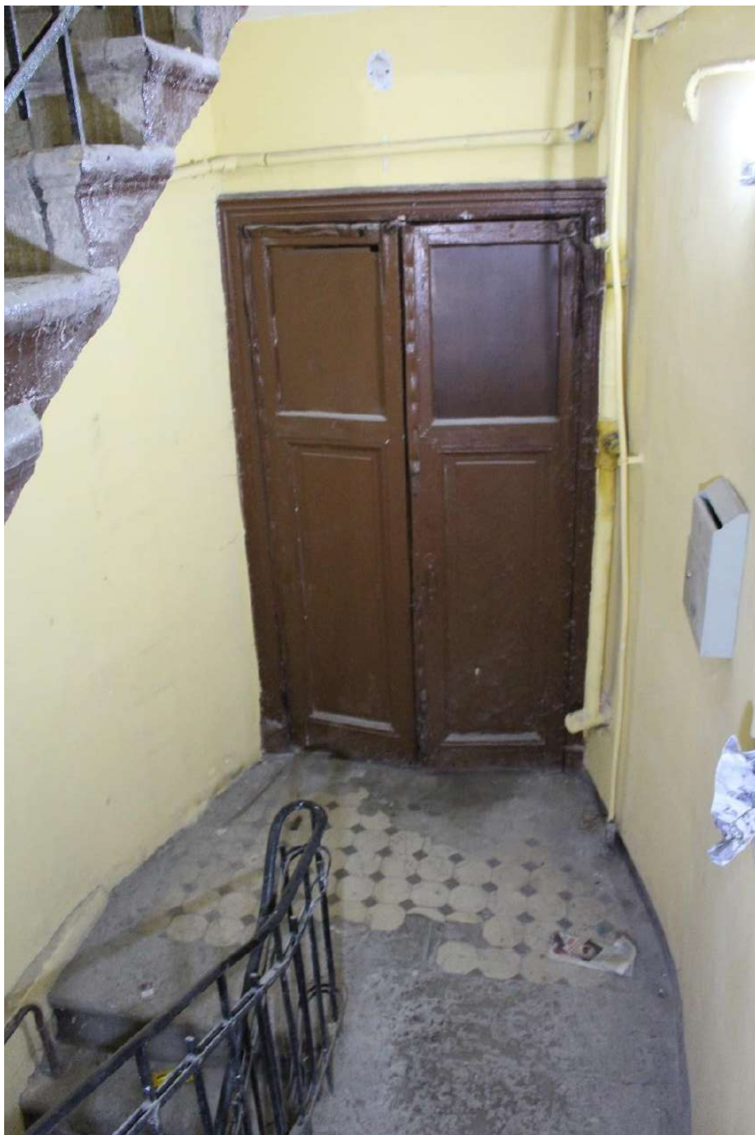
Фото 148. Выявленный объект культурного наследия «Дом Второго Санкт-Петербургского товарищества для устройства постоянных квартир (с курдонером, палисадниками и оградой)». Лестничная клетка 5ЛК в уровне 1-го этажа.
