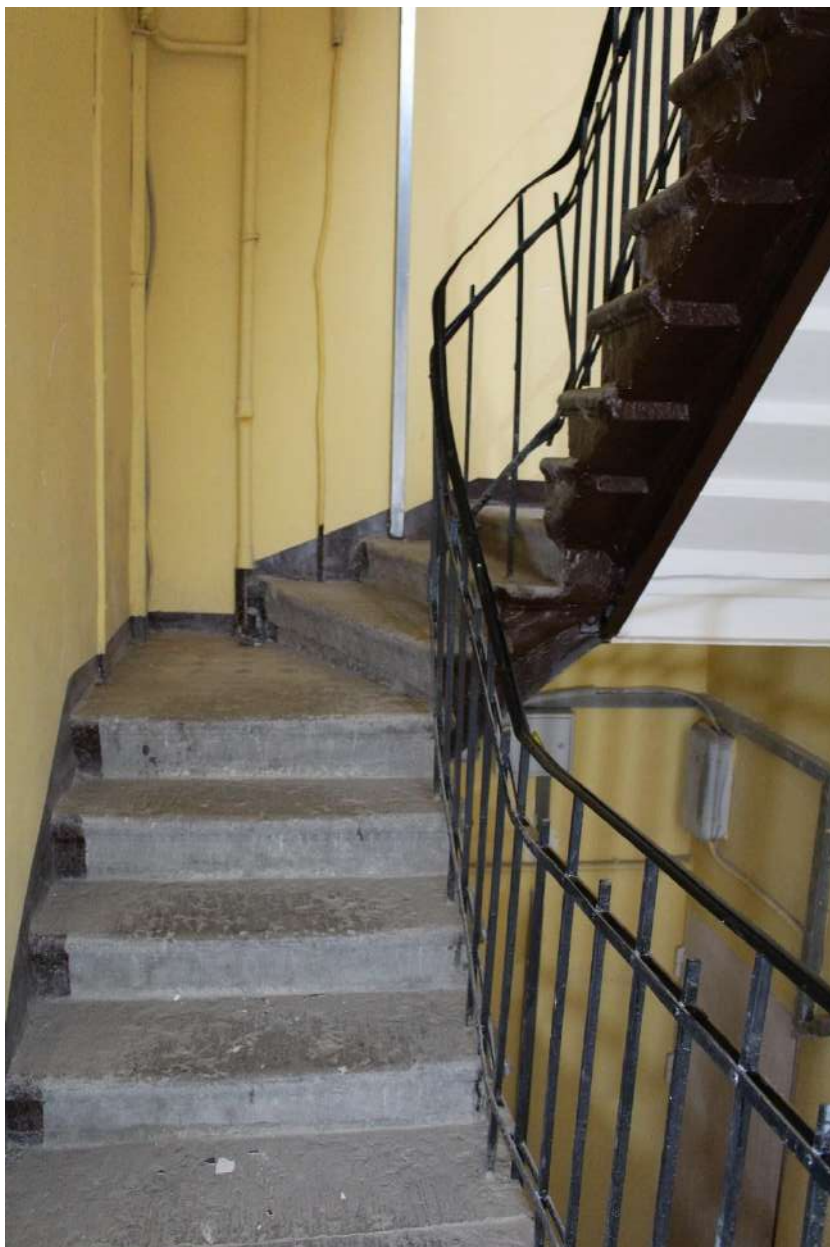
Фото 155. Выявленный объект культурного наследия «Дом Второго Санкт-Петербургского товарищества для устройства постоянных квартир (с курдонером, палисадниками и оградой)». Лестничная клетка 5ЛК в уровне 4-го этажа.
