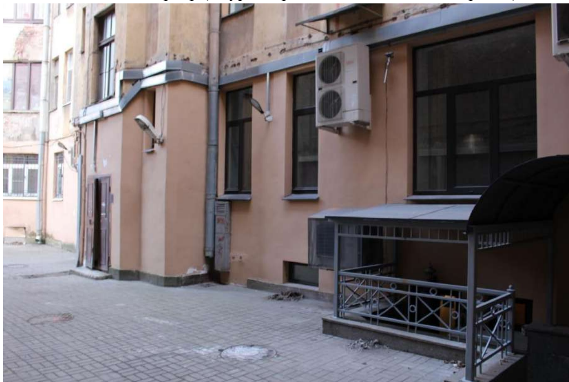
Фото 29. Фрагмент дворового фасада юго-западного корпуса выявленного объекта культурного наследия «Дом Второго Санкт-Петербургского товарищества для устройства постоянных квартир (с курдонером, палисадниками и оградой)».
