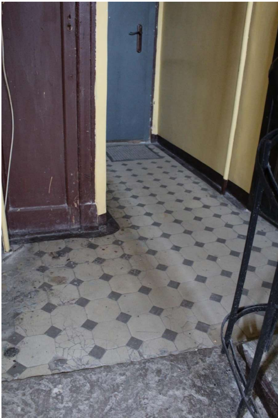
Фото 202. Выявленный объект культурного наследия «Дом Второго Санкт-Петербургского товарищества для устройства постоянных квартир (с курдонером, палисадниками и оградой)». Лестничная клетка 8ЛК в уровне 6-го этажа.
