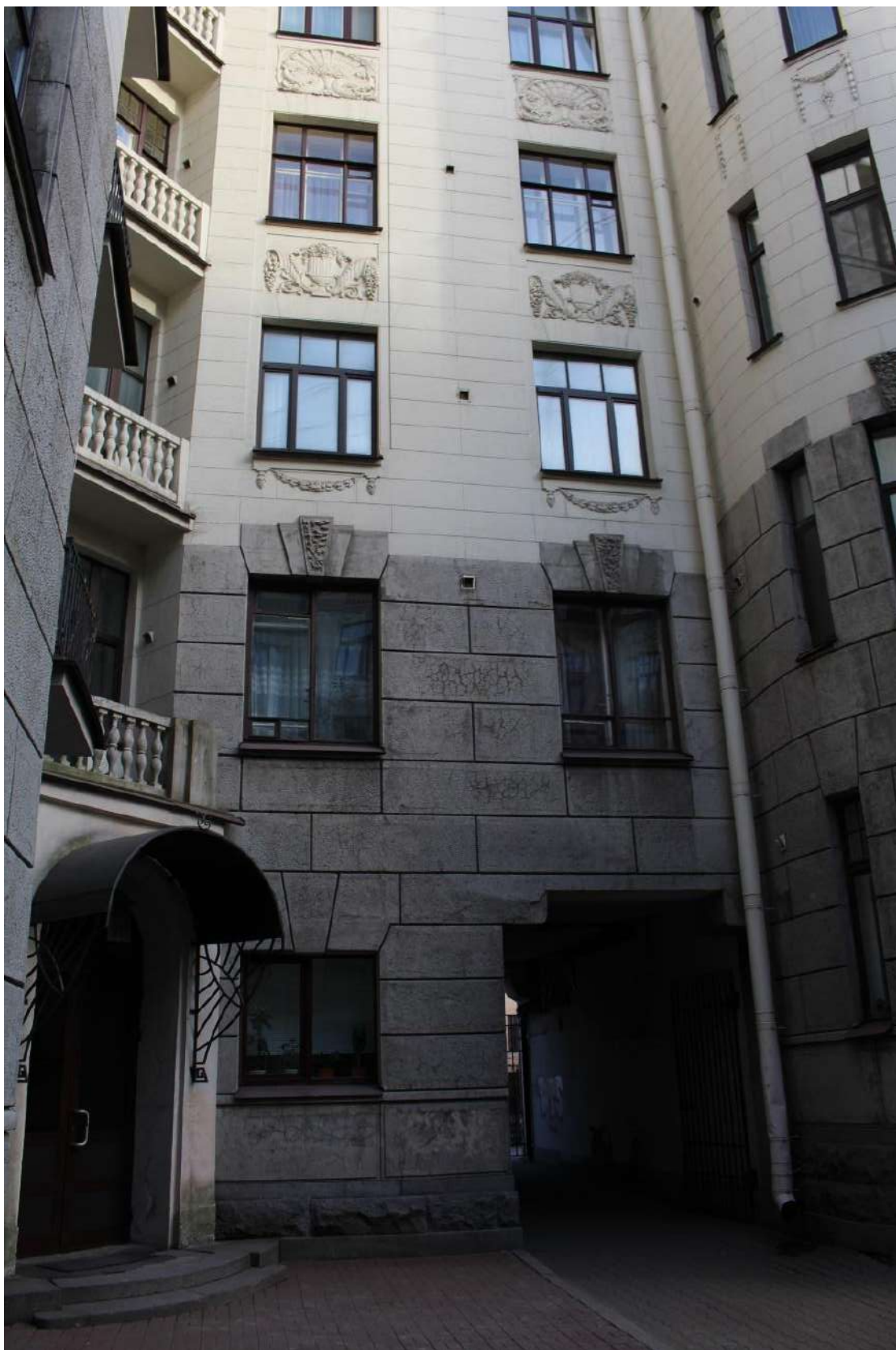
Фото 15. Вид на восточную часть лицевого фасада северного корпуса выявленного объекта культурного наследия «Дом Второго Санкт-Петербургского товарищества для устройства постоянных квартир (с курдонером, палисадниками и оградой)».
