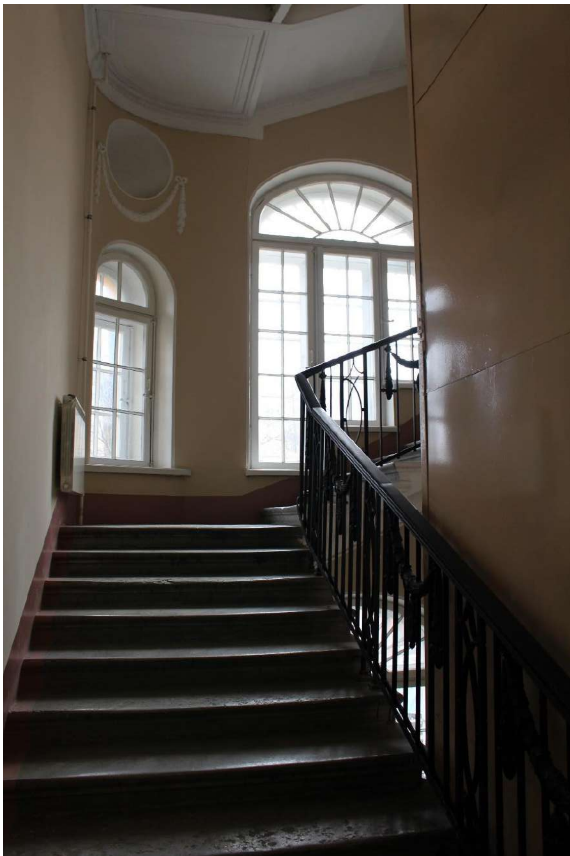
Фото 76. Выявленный объект культурного наследия «Дом Второго Санкт-Петербургского товарищества для устройства постоянных квартир (с курдонером, палисадниками и оградой)». Лестничная клетка 1ЛК в уровне 2-го - 3-го этажей.
