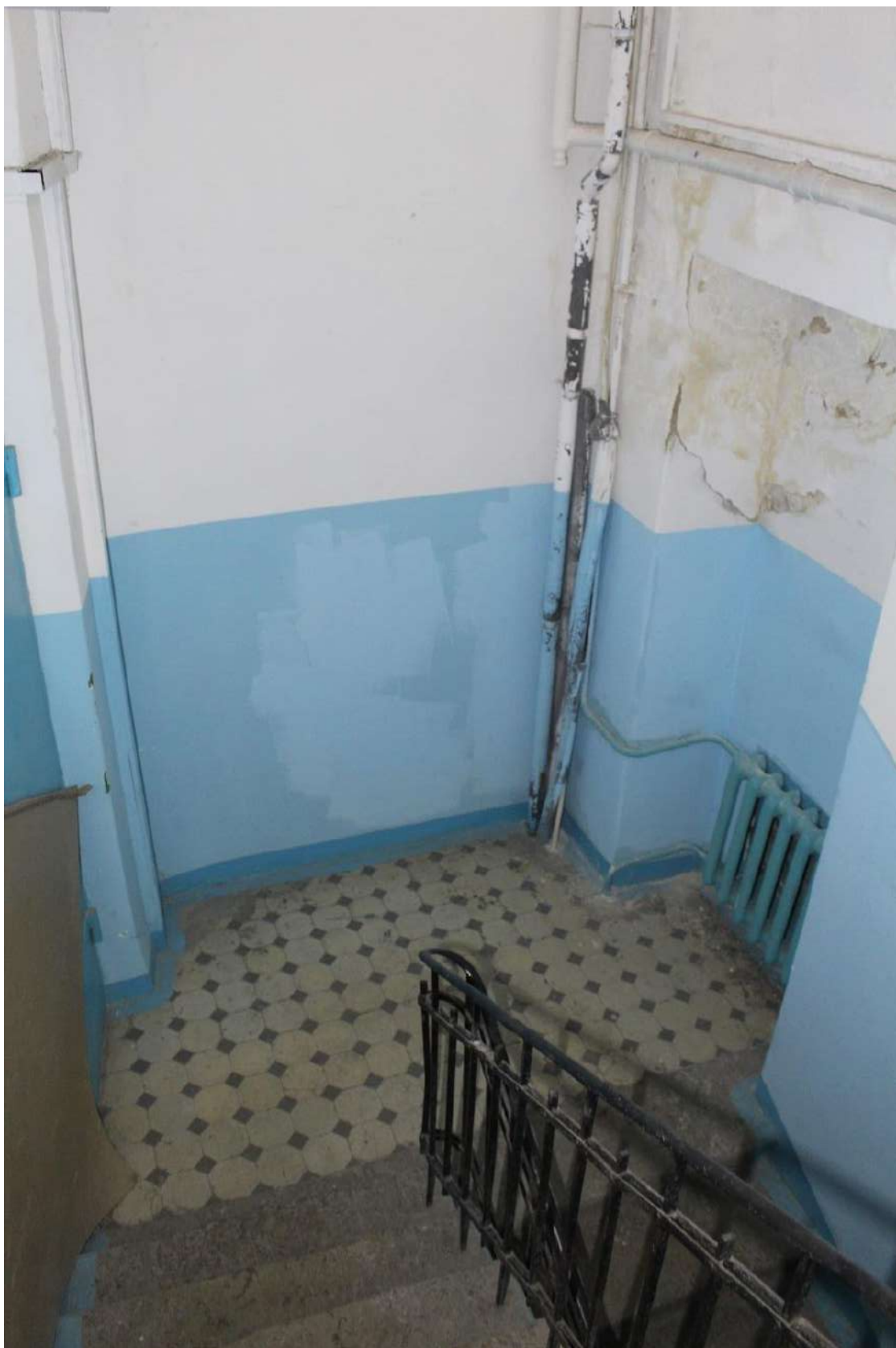
Фото 135. Выявленный объект культурного наследия «Дом Второго Санкт-Петербургского товарищества для устройства постоянных квартир (с курдонером, палисадниками и оградой)». Лестничная клетка ЗЛК в уровне 1-го этажа.
