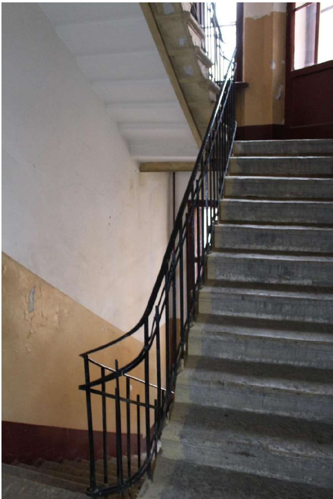
Фото 173. Выявленный объект культурного наследия «Дом Второго Санкт-Петербургского товарищества для устройства постоянных квартир (с курдонером, палисадниками и оградой)». Лестничная клетка БЛК в уровне 4-го этажа.
