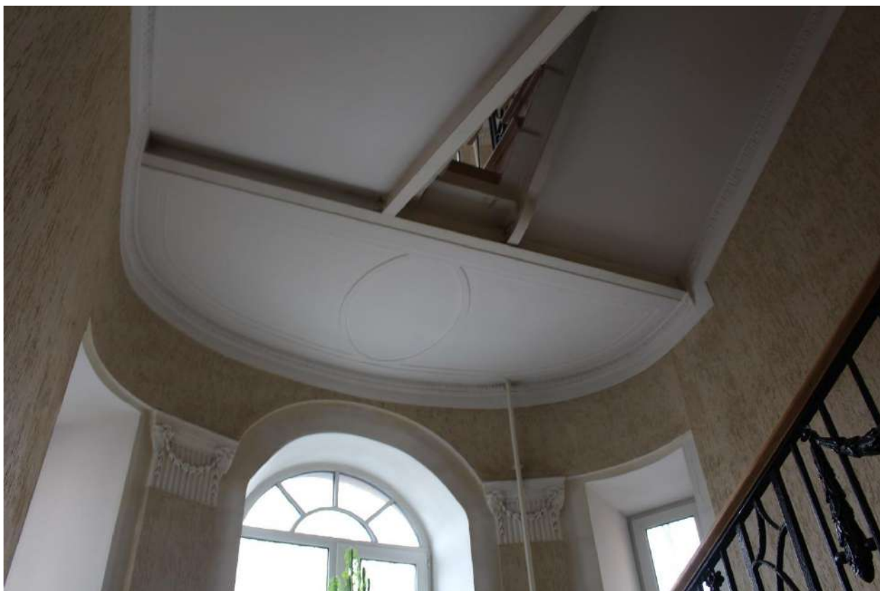
Фото 212. Выявленный объект культурного наследия «Дом Второго Санкт-Петербургского товарищества для устройства постоянных квартир (с курдонером, палисадниками и оградой)». Лестничная клетка 9ЛК в уровне 3-го – 4-го этажей.
