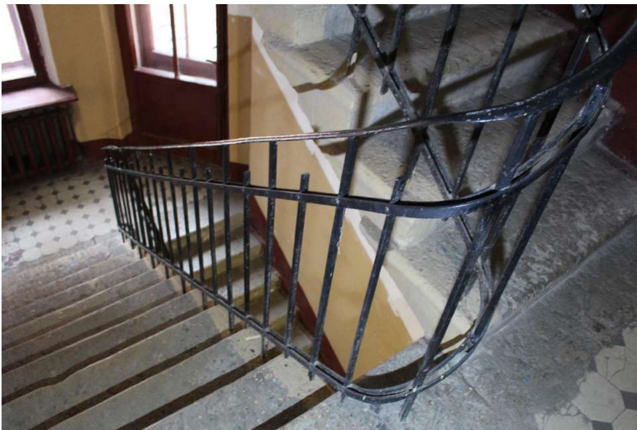
Фото 172. Выявленный объект культурного наследия «Дом Второго Санкт-Петербургского товарищества для устройства постоянных квартир (с курдонером, палисадниками и оградой)». Лестничная клетка БЛК в уровне 4-го этажа.
