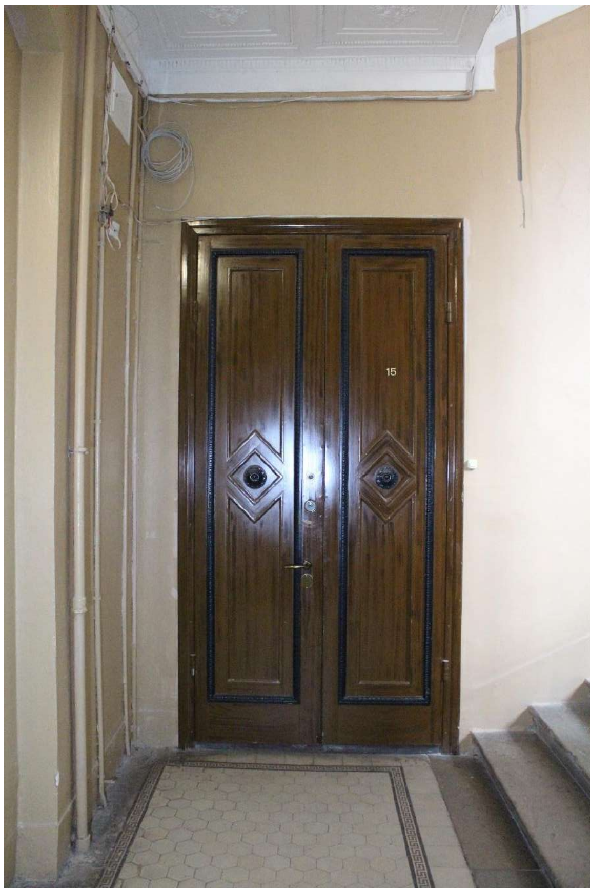
Фото 119. Выявленный объект культурного наследия «Дом Второго Санкт-Петербургского товарищества для устройства постоянных квартир (с курдонером, палисадниками и оградой)». Лестничная клетка 2ЛК в уровне 3-го этажа.
