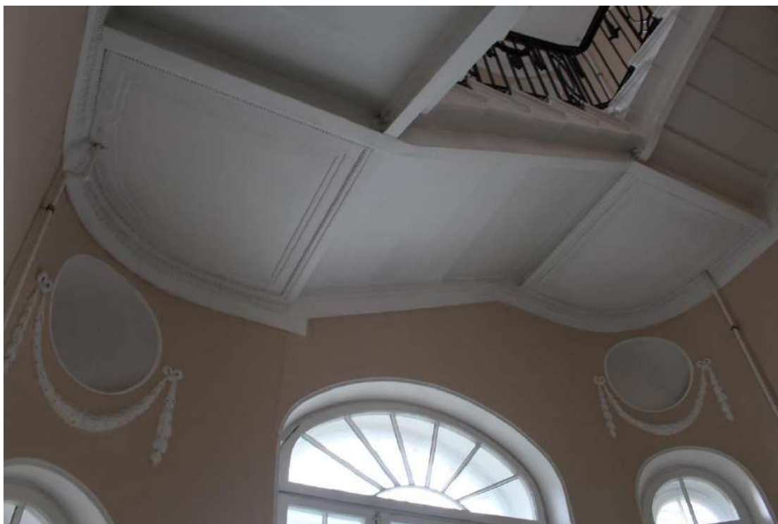
Фото 77. Выявленный объект культурного наследия «Дом Второго Санкт-Петербургского товарищества для устройства постоянных квартир (с курдонером, палисадниками и оградой)». Лестничная клетка 1ЛК в уровне 2-го - 3-го этажей.
