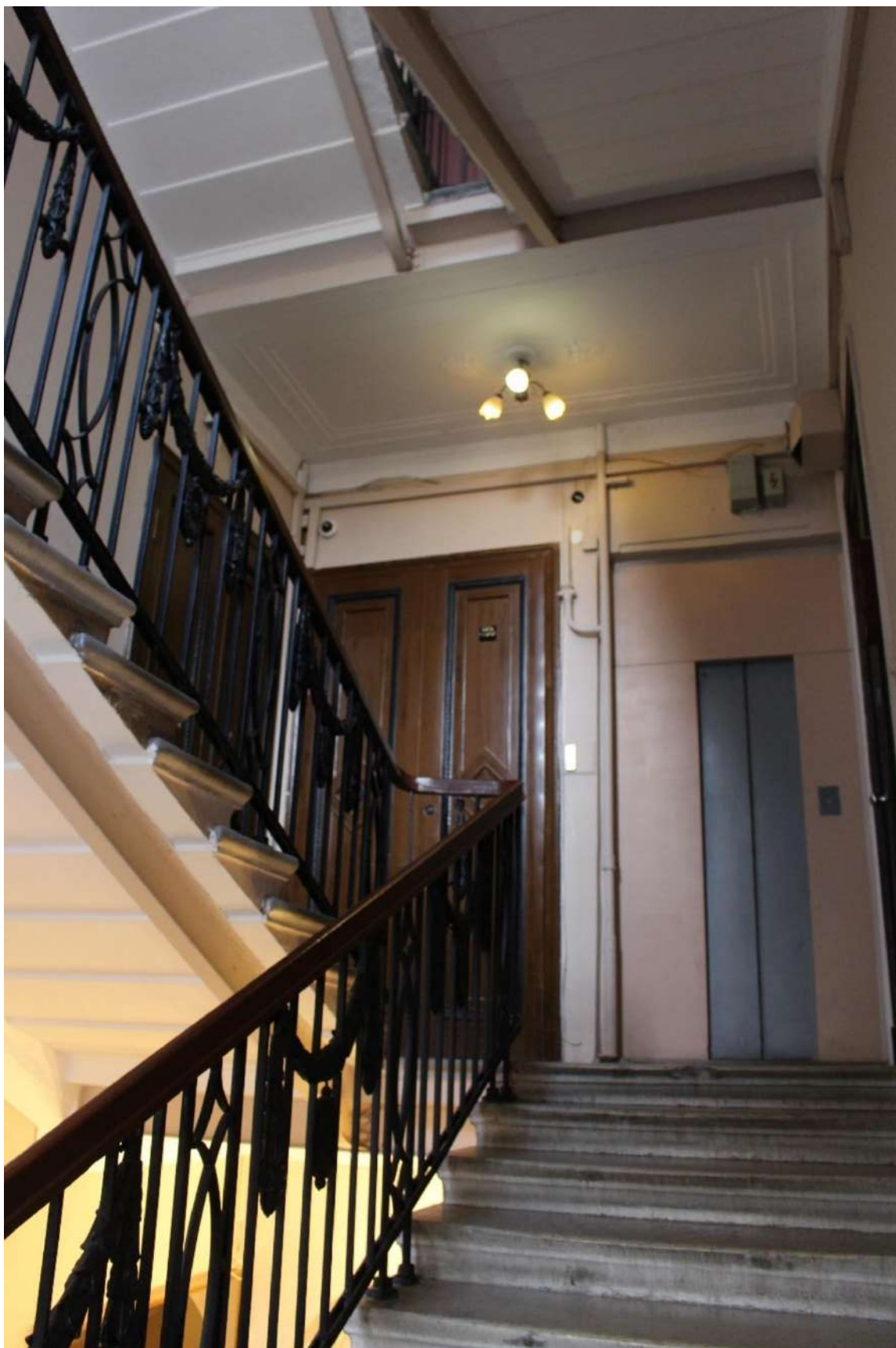
Фото 183. Выявленный объект культурного наследия «Дом Второго Санкт-Петербургского товарищества для устройства постоянных квартир (с курдонером, палисадниками и оградой)». Лестничная клетка 7ЛК в уровне 2-го этажа.
