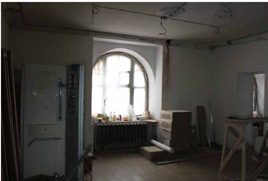
Фото 62. Западный жилой корпус (ул. Комиссара Смирнова, д. 15, лит. В) выявленного объекта культурного наследия «Жилой дом Выборгского товарищества для устройства постоянных квартир (Дворец культуры «Выборгский» с двумя жилыми корпусами)». Квартира № 87, объединенные помещения №№ 2, 3, 4.
