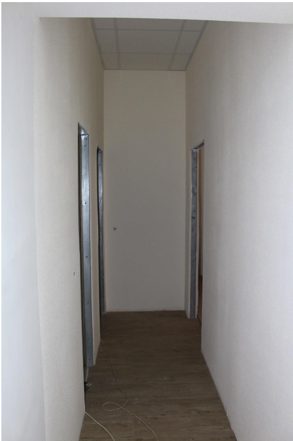
Фото 64. Западный жилой корпус (ул. Комиссара Смирнова, д. 15, лит. В) выявленного объекта культурного наследия «Жилой дом Выборгского товарищества для устройства постоянных квартир (Дворец культуры «Выборгский» с двумя жилыми корпусами)». Квартира № 87, часть помещений № 4, 7 с новой планировкой.
