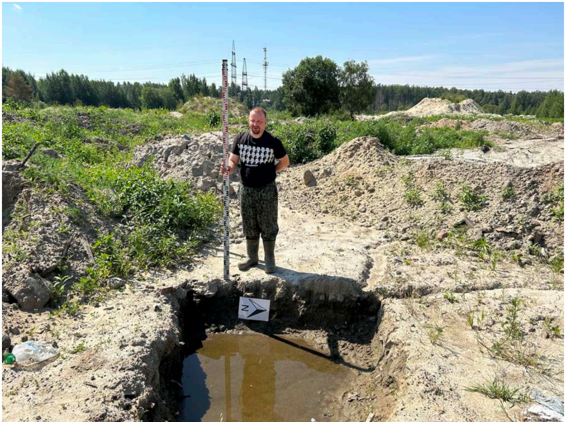
Рис. 214. Земельный участок с кадастровым номером 78:36:0013262:3829 по адресу Санкт-Петербург, внутригородское муниципальное образование Санкт-Петербурга поселок Парголово, Михайловская дорога, земельный участок 8. Место выполнения зачистки № 3, вид с востока.
