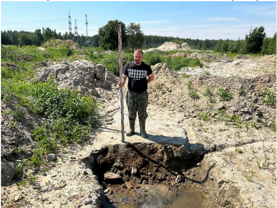
Рис. 247. Земельный участок с кадастровым номером 78:36:0013262:3829 по адресу Санкт-Петербург, внутригородское муниципальное образование Санкт-Петербурга поселок Парголово, Михайловская дорога, земельный участок 8. Зачистка № 3, вид с востока после рекультивации.
