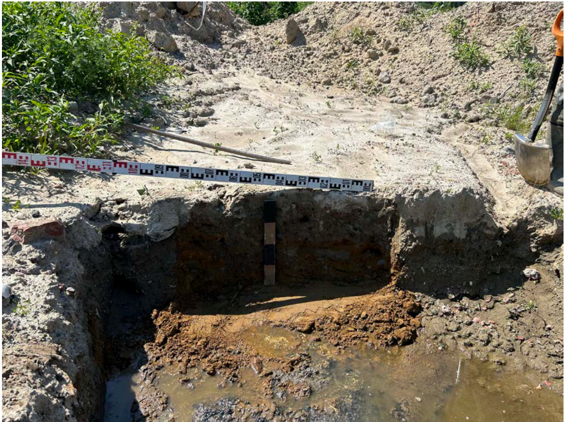
Рис. 236. Земельный участок с кадастровым номером 78:36:0013262:3829 по адресу Санкт-Петербург, внутригородское муниципальное образование Санкт-Петербурга поселок Парголово, Михайловская дорога, земельный участок 8. Место выполнения зачистки № 3, вид с востока на западную стенку.
