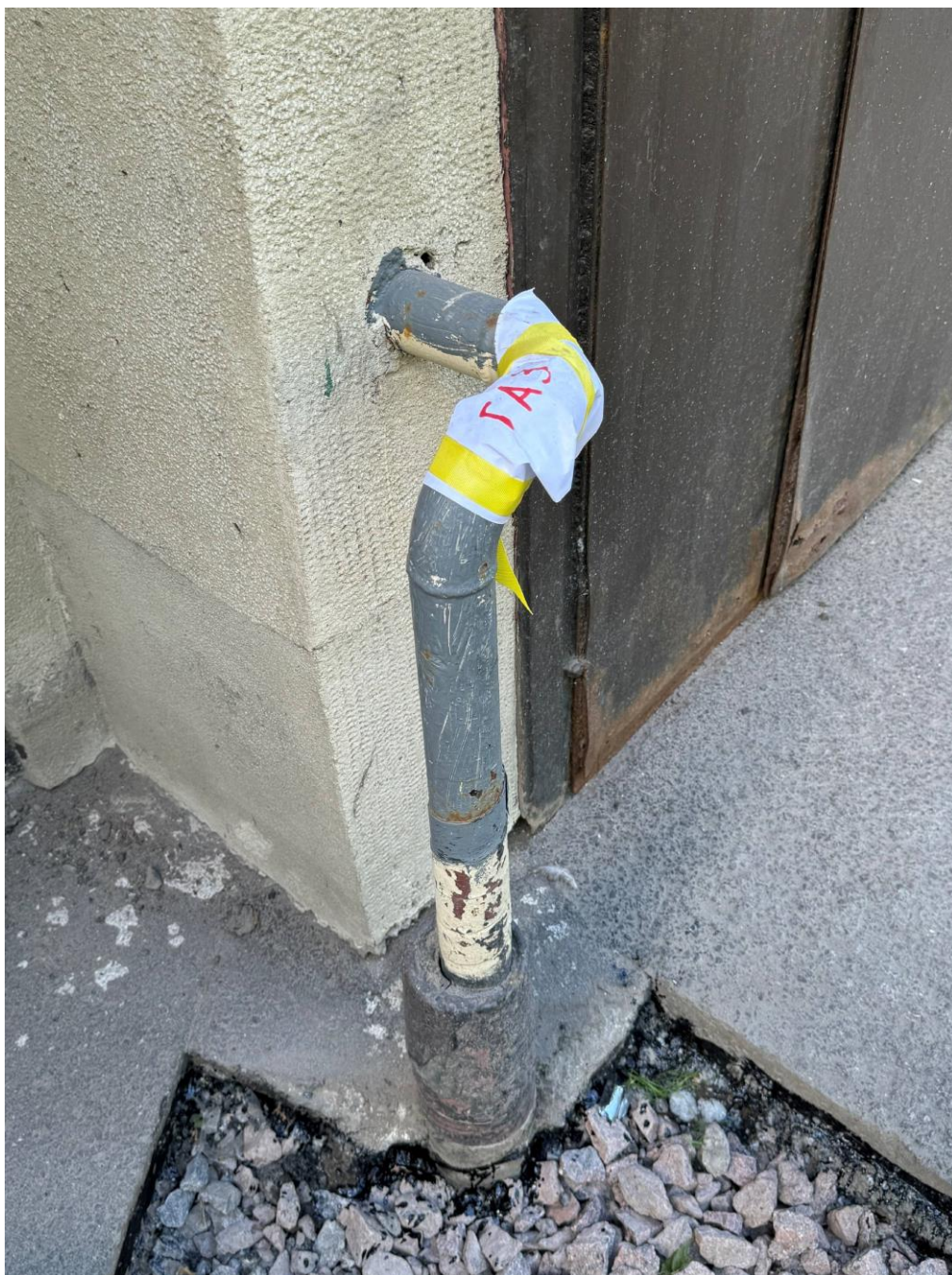
Фото 24. Объект культурного наследия регионального значения «Комплекс жилых домов (6 зданий)», расположенный по адресу: Санкт-Петербург, Малоохтинский проспект, дом 84, литера А, дом 86, литера А, дом 88, литера А, дом 92, литера А, дом 94, литера А, дом 96/2, литера А. Место ввода газовой трубы. Фото Васильева Н. В. (09.07.2024 г.)
