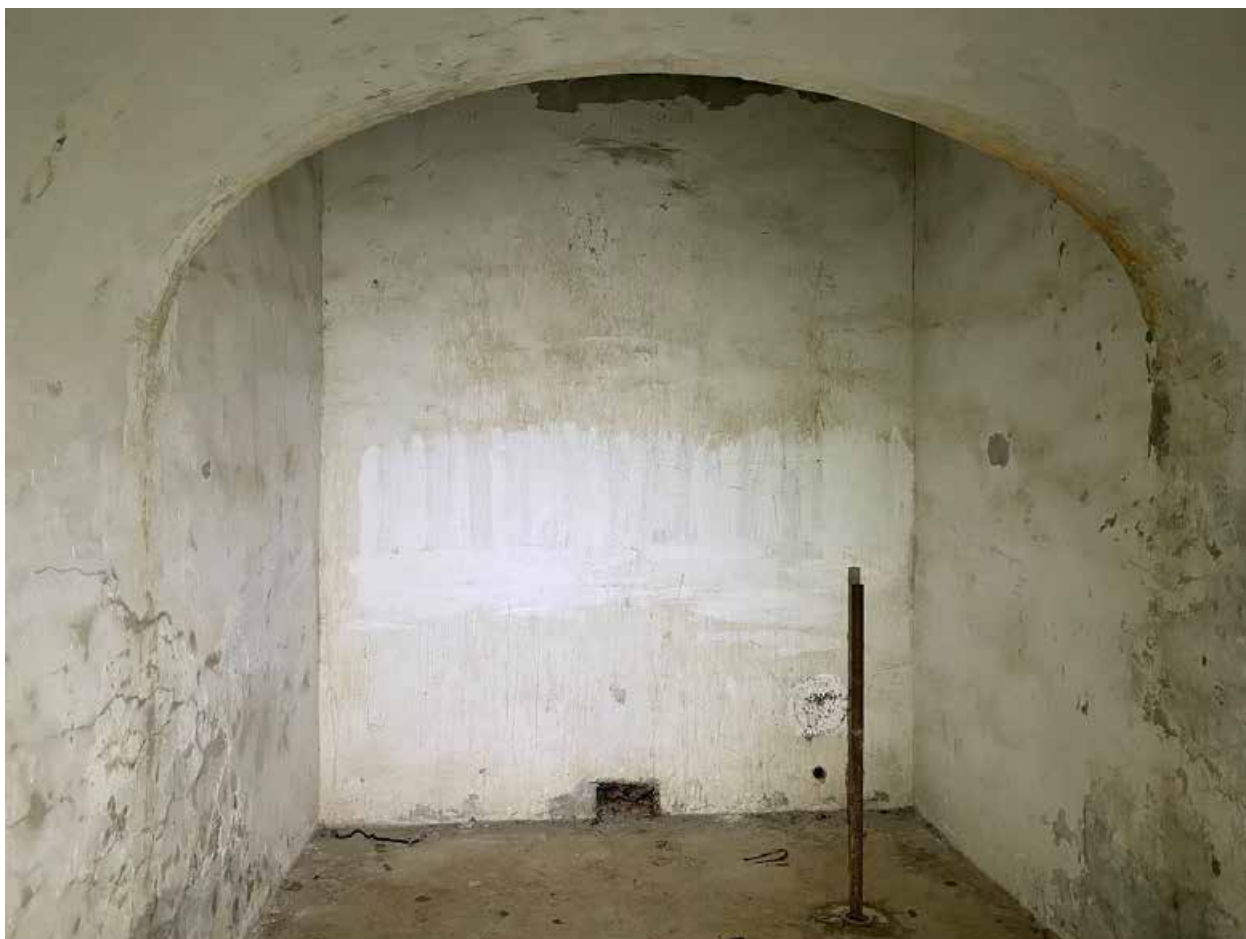
Фото 37. Внутренние помещения 1-го яруса центральной части (центральной оборонительной позиции форта) объекта культурного наследия федерального значения «Форт «Константин» – Батареи казематированной 2-х ярусной «Брылкин» на восемь 6-ти дюймовых (152 мм) орудий, 1898-1901 гг.
