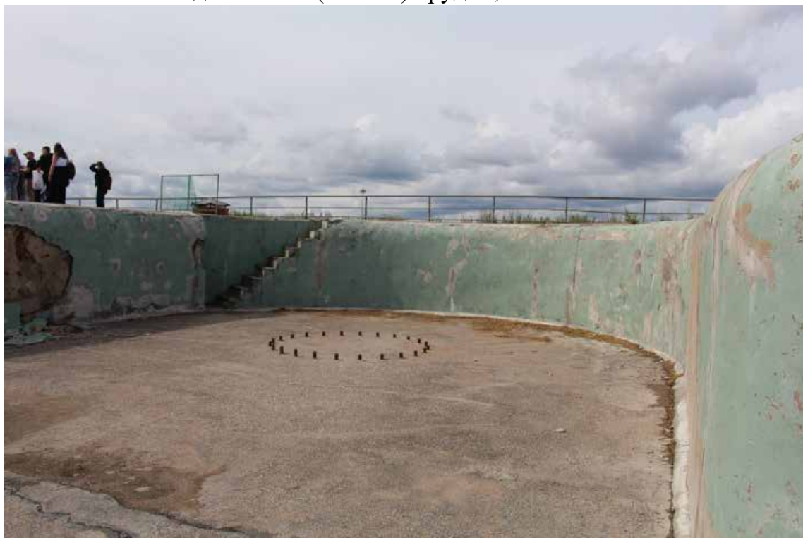
Фото 12. Вид на валганг центральной части (центральной оборонительной позиции форта) объекта культурного наследия федерального значения «Форт «Константин» – Батареи казематированной 2-х ярусной «Брылкин» на восемь 6-ти дюймовых (152 мм) орудий, 1898-1901 гг.
