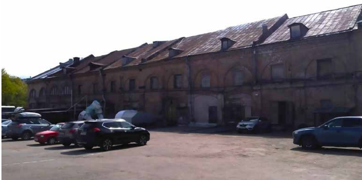
Фото 8. Дворовый фасад восточного корпуса. В настоящее время выполнены демонтажные работы гаражей и наклонных входов – навесов в подвальные помещения, в соответствии с согласованной документацией.
