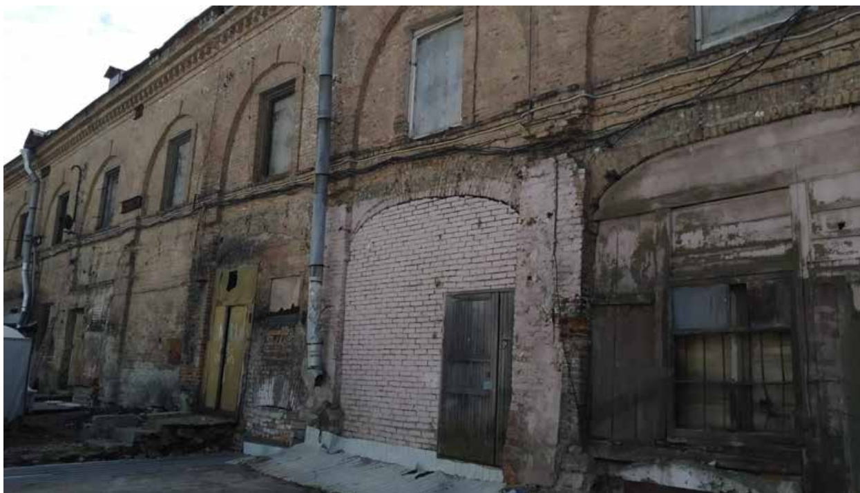
Фото 9. Фрагмент дворового фасада восточного корпуса. В настоящее время выполнены демонтажные работы гаражей и наклонных входов – навесов в подвальные помещения, в соответствии с согласованной документацией.
