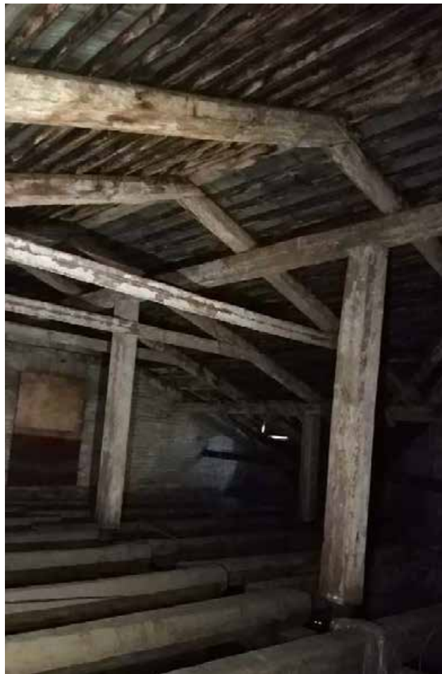
Фото 25. Чердачное помещение восточного корпуса. Повсеместные следы увлажнения элементов стропильной системы.
