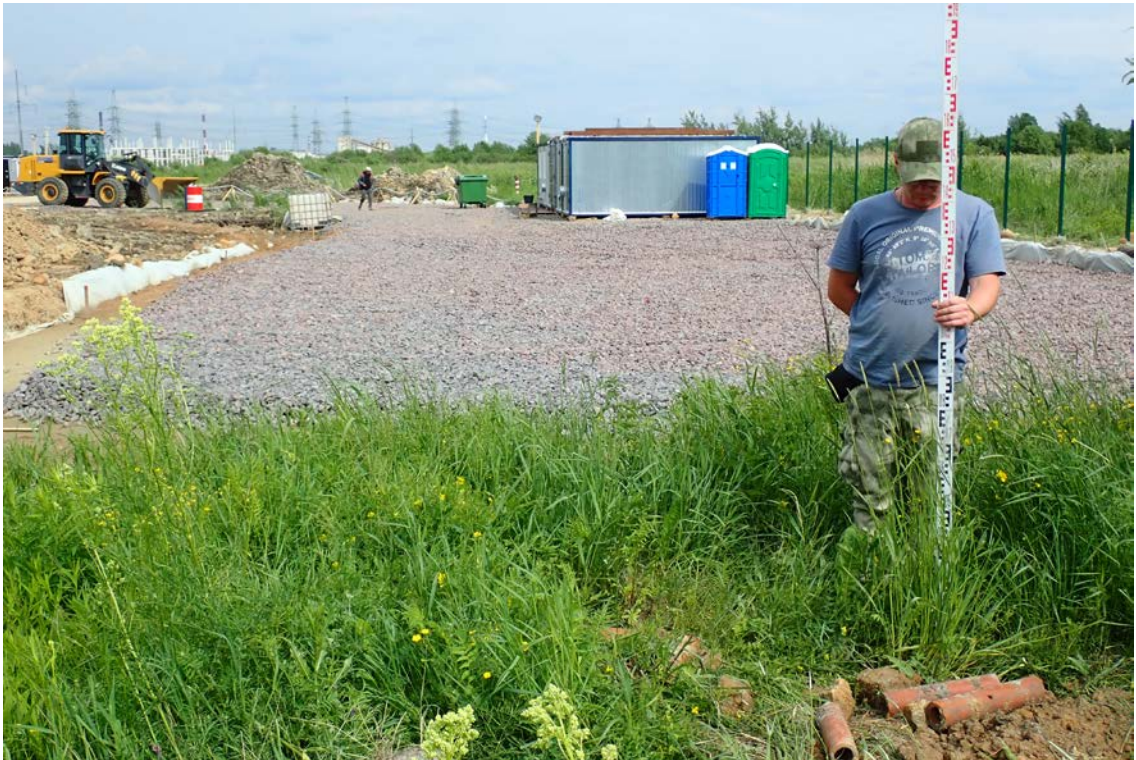
Рис. 12. Земельный участок с кадастровым номером 78:42:0018326:412, расположенный по адресу: Санкт-Петербург, внутригородское муниципальное образование Санкт-Петербурга поселок Шушары. Точка фотофиксации 1. Площадка под бытовки со снятым плодородным слоем в юго-восточной части участка. Керамические мелиоративные трубы XX века. Вид с запада
