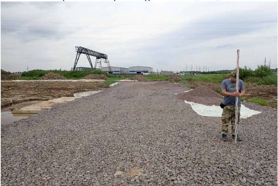
Рис. 13 Земельный участок с кадастровым номером 78:42:0018326:412, расположенный по адресу: Санкт-Петербург, внутригородское муниципальное образование Санкт-Петербурга поселок Шушары. Точка фотофиксации 2. Нарушения в центральной части участка. Вид с юга.
