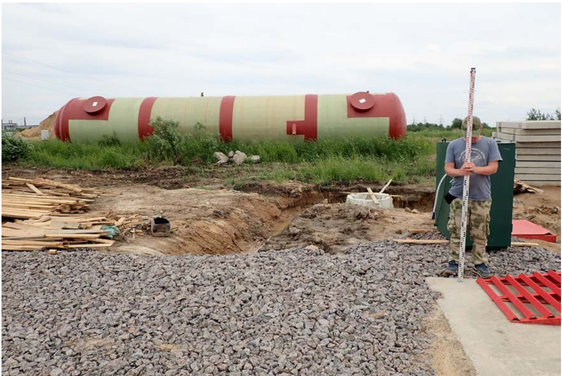
Рис. 14 Земельный участок с кадастровым номером 78:42:0018326:412, расположенный по адресу: Санкт-Петербург, внутригородское муниципальное образование Санкт-Петербурга поселок Шушары. Точка фотофиксации 2. Нарушения в центральной части участка. Вид с запада.
