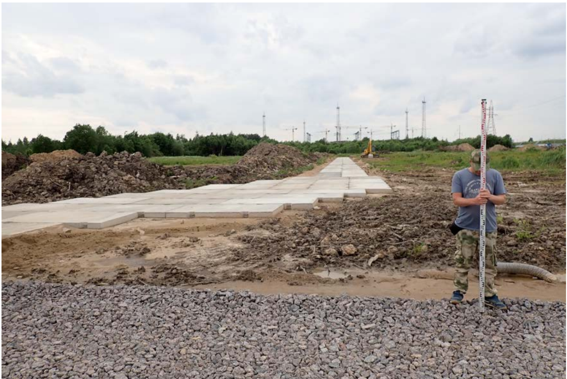
Рис. 16 Земельный участок с кадастровым номером 78:42:0018326:412, расположенный по адресу: Санкт-Петербург, внутригородское муниципальное образование Санкт-Петербурга поселок Шушары. Точка фотофиксации 2. Нарушения в центральной части участка. Вид с востока
