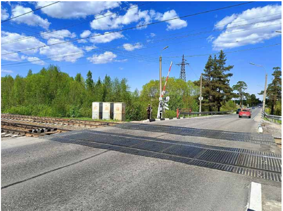
Рис. 24. СПб-2024. Г. Петергоф, Ропшинское ш., пересечение с ЖД. Точка фотофиксации 5, вид с юга.
