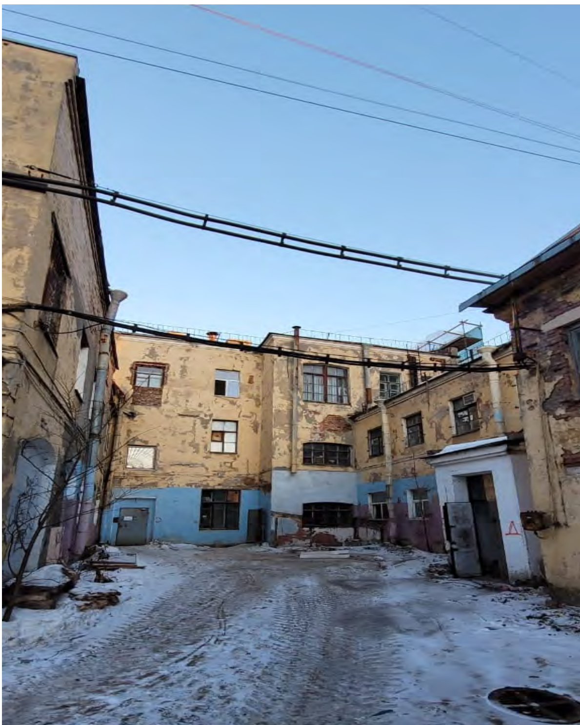
Фото 7. Общий вид со стороны двора на реконструируемое здание 1 (Биржевая линия, д. 8-10, лит. А). Фото от 30.01.2024 г.
