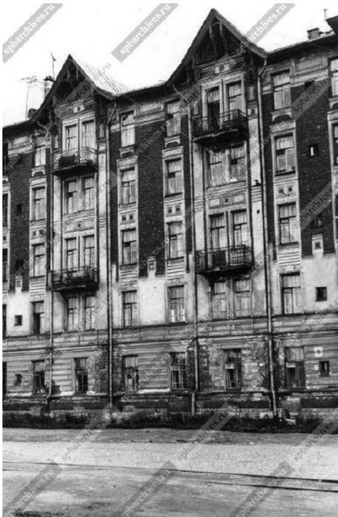
Илл. 109. Фрагмент фасада одного из разрушающихся жилых домов Жилого комплекса «Гаванский рабочий городок» (Гаванская ул., 47; Малый пр., 69, 71). 1955-1960 гг. (источник: ЦГАКФФД СПб. Фотодокумент Бр 67527).
