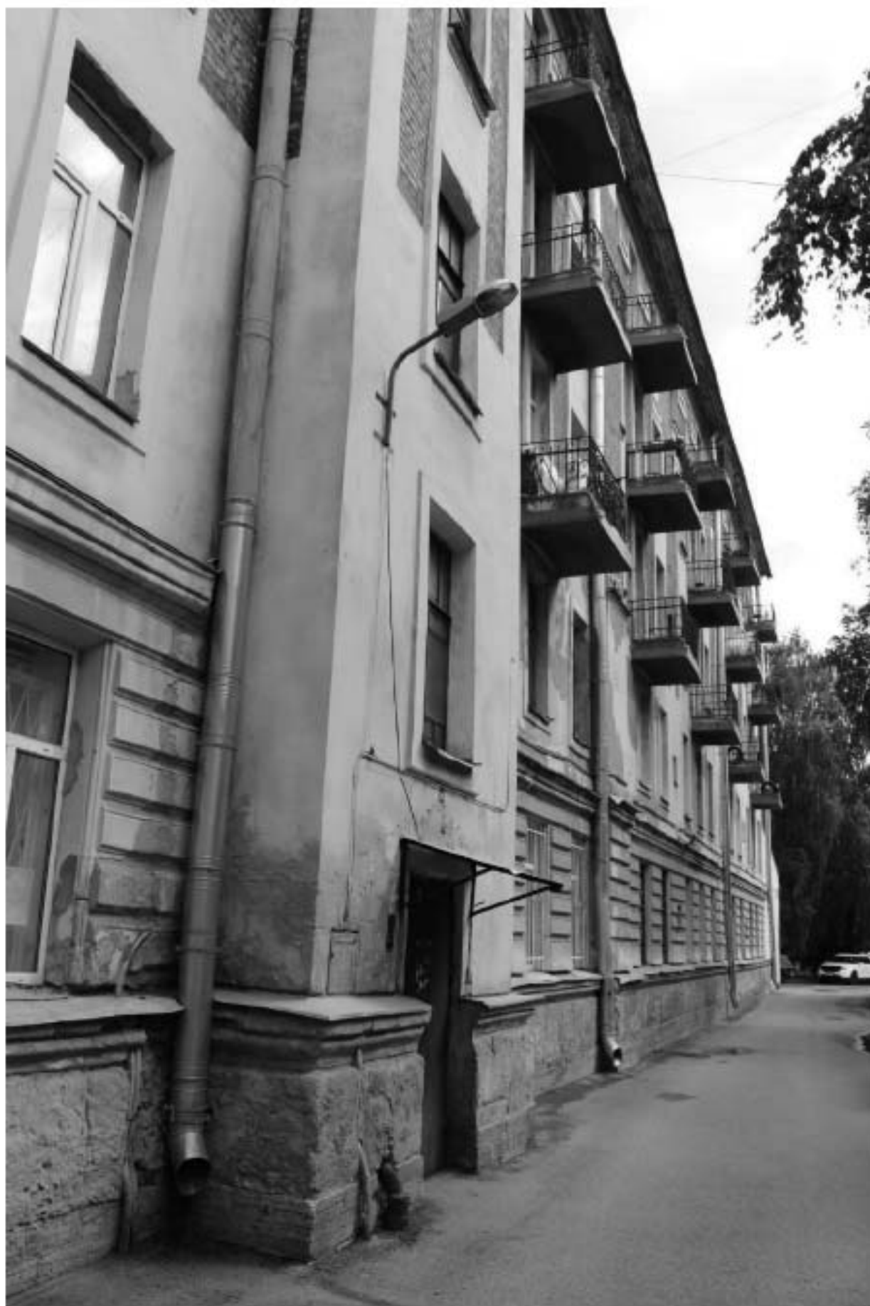
Фото 16. Вид на южный фасад объекта культурного наследия регионального значения «Жилой корпус» по адресу: Санкт-Петербург, Гаванская улица, дом 47, литера Б.
