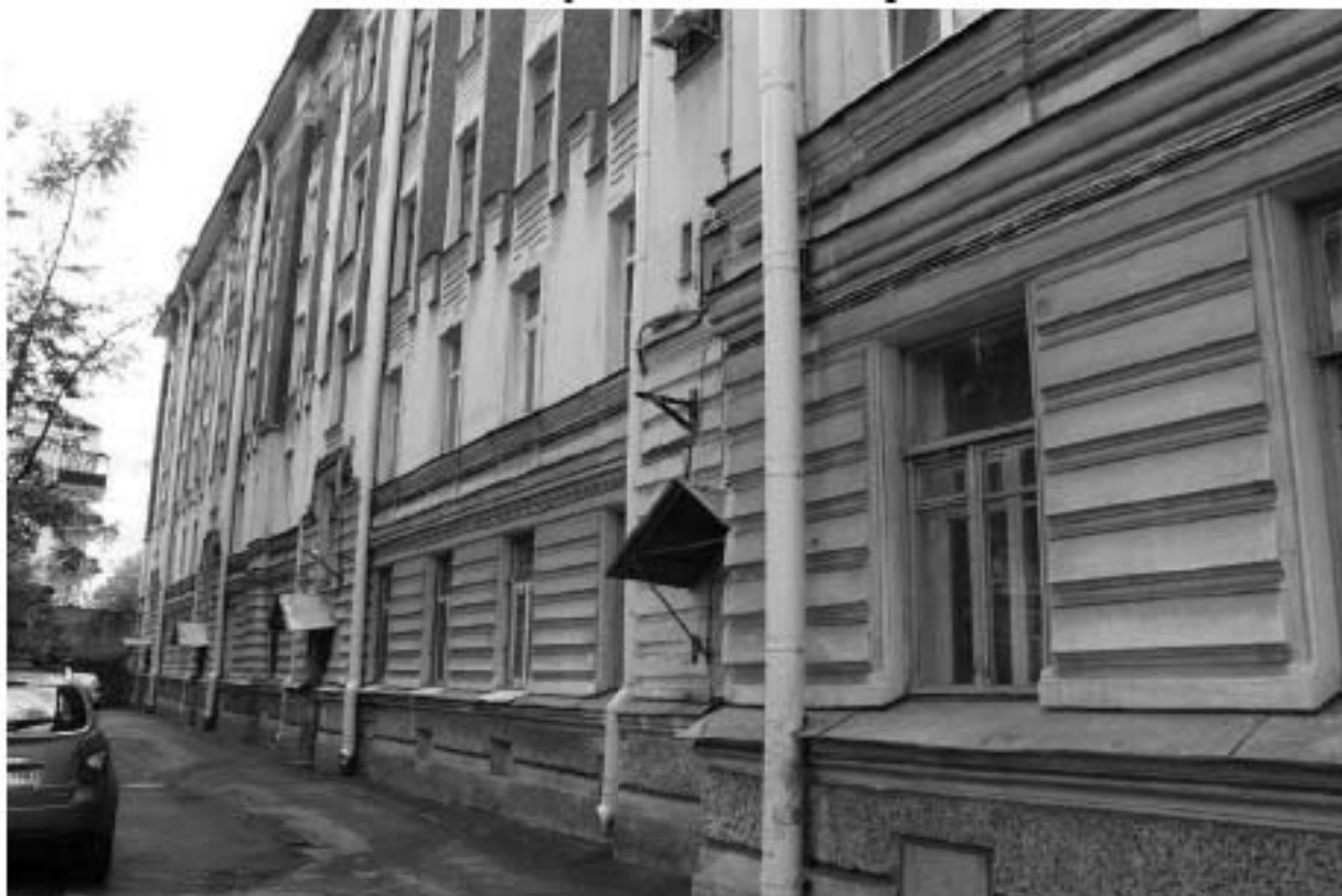
Фото 10. Вид на северный фасад объекта культурного наследия регионального значения «Жилой корпус» по адресу: Санкт-Петербург, Гаванская улица, дом 47, литера А.
