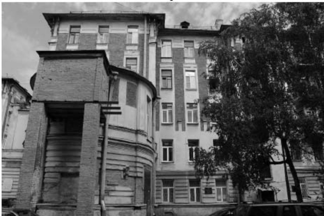
Фото 22. Вид на южный фасад объекта культурного наследия регионального значения «Жилой корпус» по адресу: Санкт-Петербург, Гаванская улица, дом 47, литера Б.
