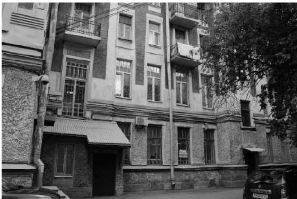
Фото 44. Вид на южный фасад объекта культурного наследия регионального значения «Жилой корпус» по адресу: Санкт-Петербург, Гаванская улица, дом 47, литера В.
