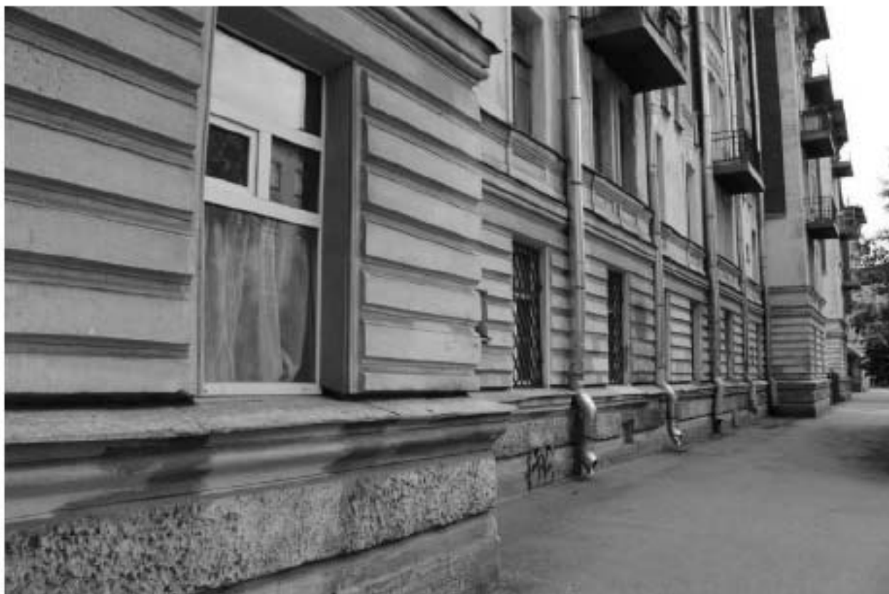
Фото 65. Вид на западный фасад объекта культурного наследия регионального значения «Жилой корпус» по адресу: Санкт-Петербург, Гаванская улица, дом 47, литера Д в уровне 1-го этажа.
