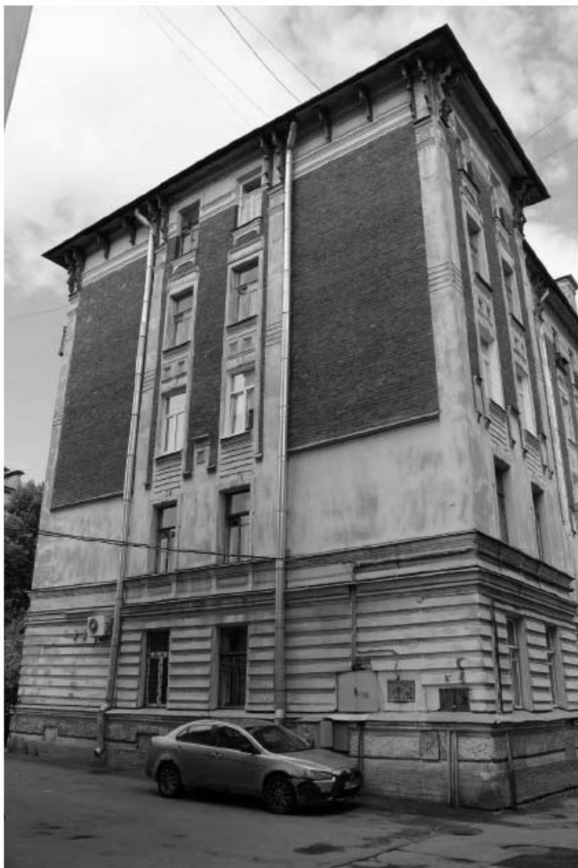
Фото 70. Вид на южный фасад объекта культурного наследия регионального значения «Жилой корпус» по адресу: Санкт-Петербург, Гаванская улица, дом 47, литера Д.
