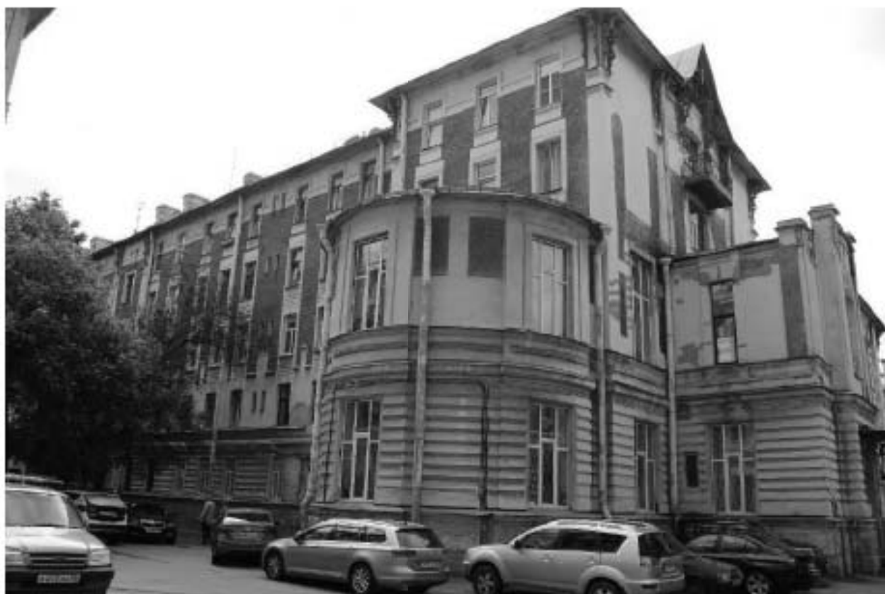
Фото 25. Вид на северный фасад объекта культурного наследия регионального значения «Жилой корпус» по адресу: Санкт-Петербург, Гаванская улица, дом 47, литера Б.
