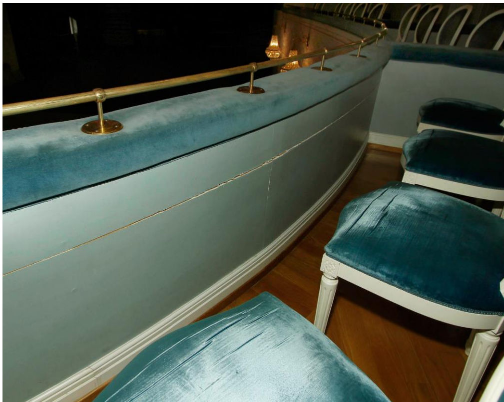
17. Объект культурного наследия федерального значения «Театр Каменноостровский» по адресу: Санкт-Петербург, Петроградский район, набережная р. Крестовки, д. 10, литера А. Зрительный зал. Бельэтаж. Фрагмент ограждения лож. Вид из ложи.
