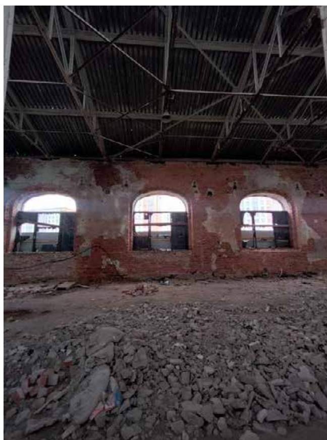
Фото 4. Интерьер объекта культурного наследия регионального значения «Сарай для императорских поездов Варшавского вокзала»
