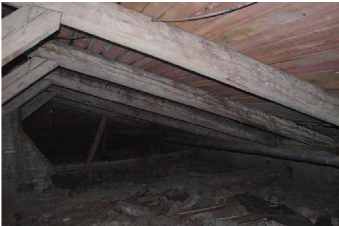
Фото 1. Объект культурного наследия федерального значения «Казармы с конюшнями», входящего в состав «Казармы лейб-гвардии конного полка» (г. Санкт-Петербург, Большая Морская ул., 67; Труда ул., 8-10; Якубовича ул., 26; Конногвардейский пер., 3-5). Чердачное пространство. Дата съемки:01.03.2024
