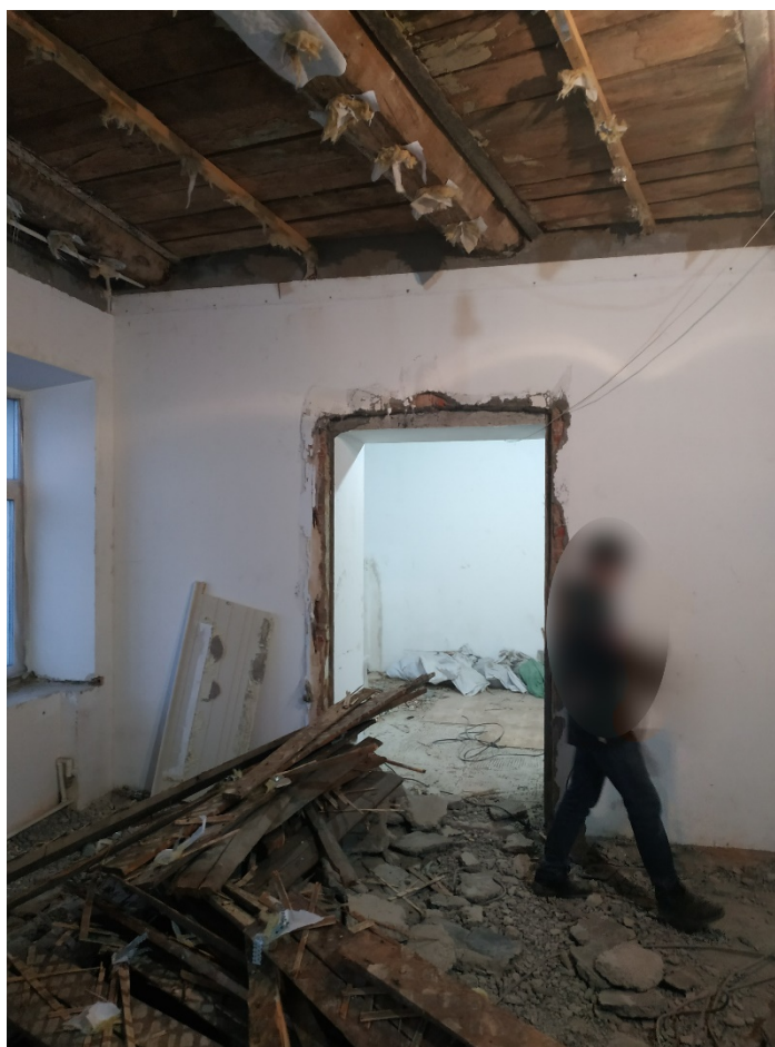
Фото 36. Отсутствие внешней отделки, складирование строительного мусора.
