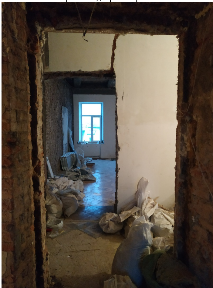
Фото 6. Отсутствие внешней отделки, складирование строительного мусора.
