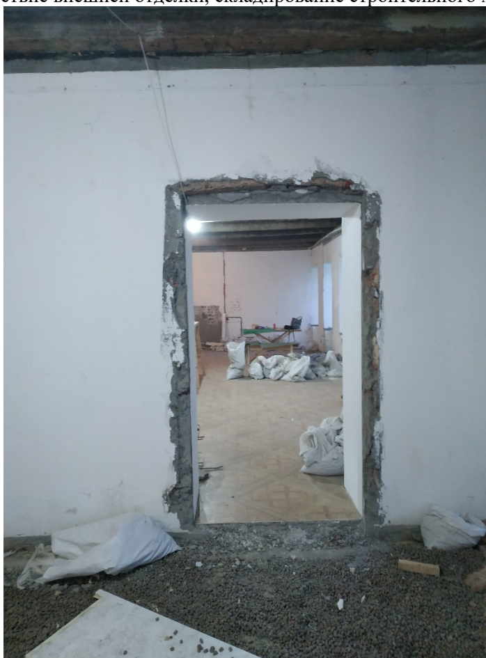
Фото 34. Отсутствие внешней отделки, складирование строительного мусора.
