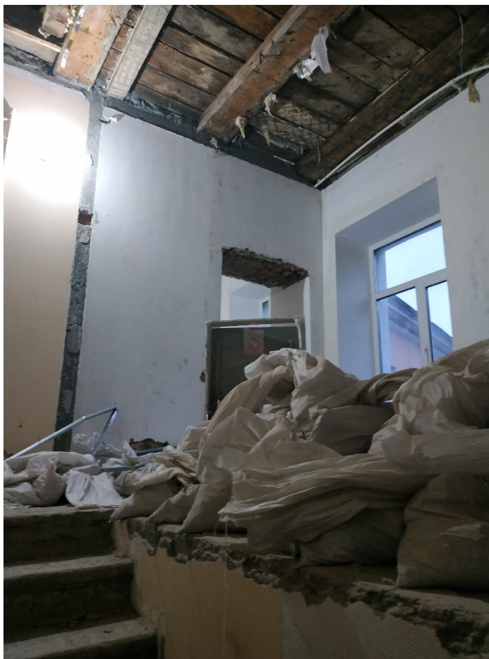
Фото 21. Лестница ЗЛК, 3 этаж. Отсутствие внешней отделки, складирование строительного мусора.
