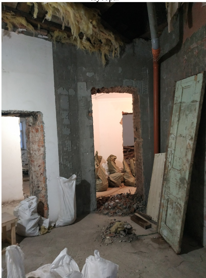
Фото 24. Отсутствие внешней отделки, складирование строительного мусора.
