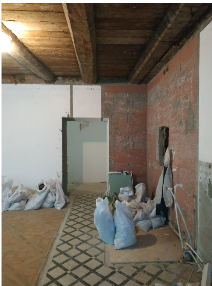
Фото 28. Отсутствие внешней отделки, складирование строительного мусора.
