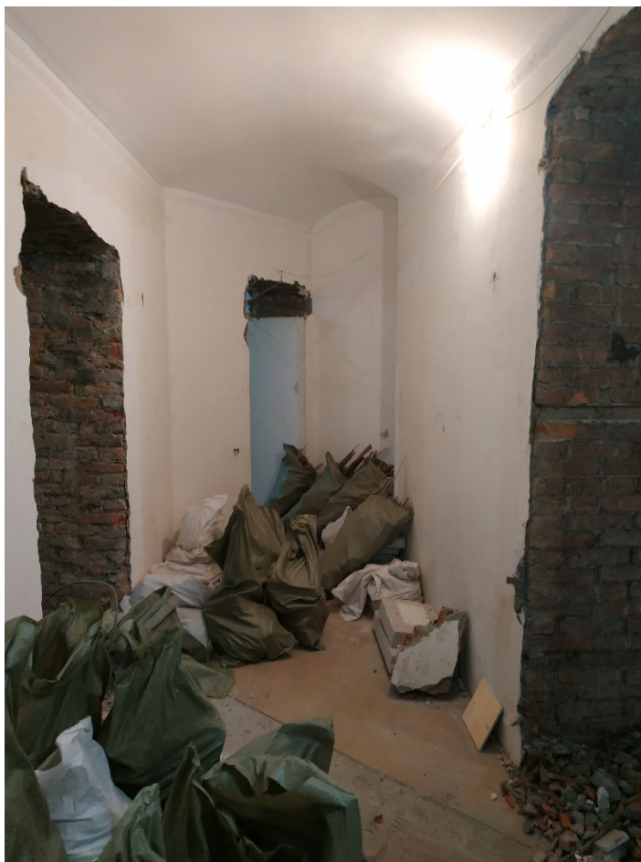
Фото 39. Отсутствие внешней отделки, складирование строительного мусора.
