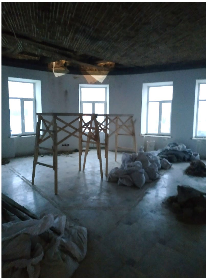
Фото 17. Отсутствие внешней отделки, складирование строительного мусора.
