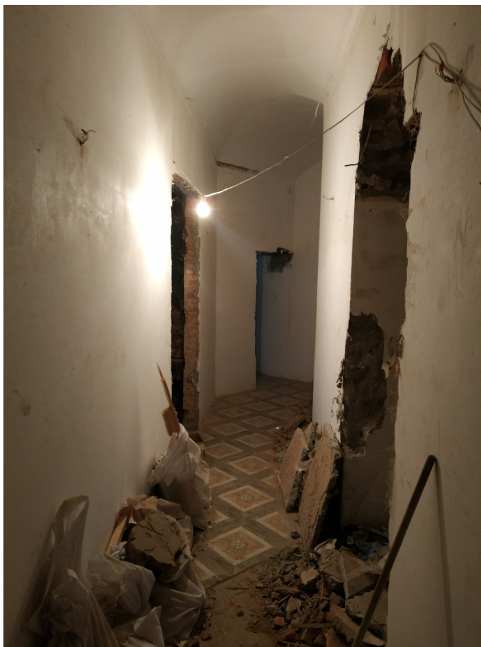
Фото 13. Отсутствие внешней отделки, складирование строительного мусора. Частичная вывалка кирпича в дверном проёме.
