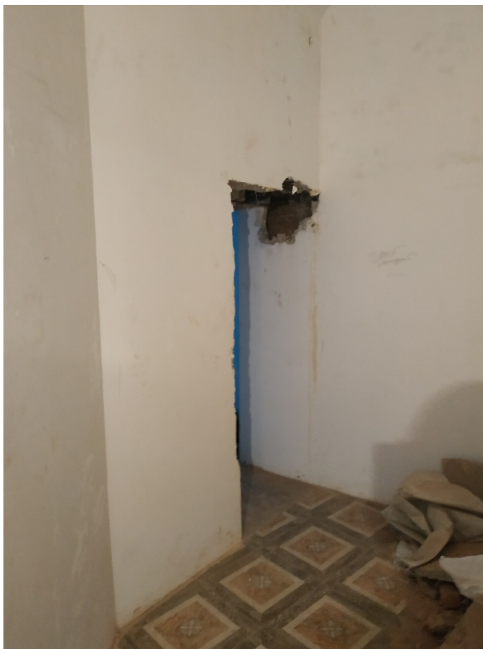
Фото 15. Отсутствие внешней отделки, складирование строительного мусора.
