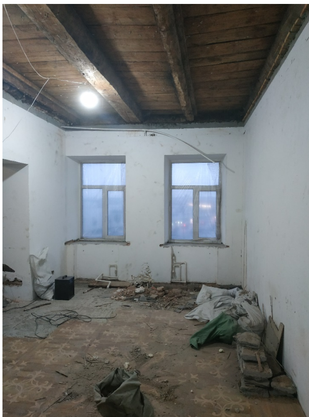
Фото 38. Отсутствие внешней отделки, складирование строительного мусора.
