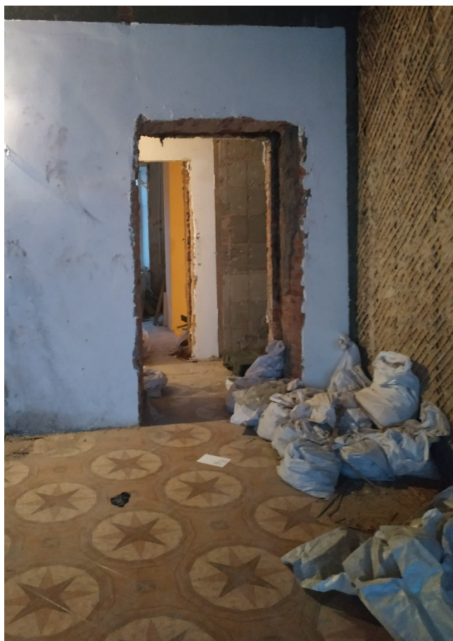
Фото 12. Отсутствие внешней отделки, складирование строительного мусора.
