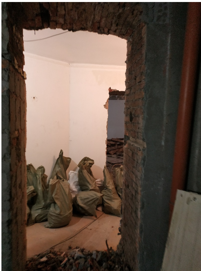
Фото 25. Отсутствие внешней отделки, складирование строительного мусора.
