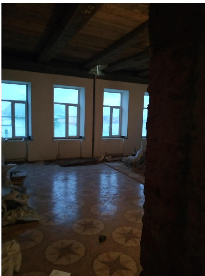
Фото 8. Отсутствие внешней отделки, складирование строительного мусора.
