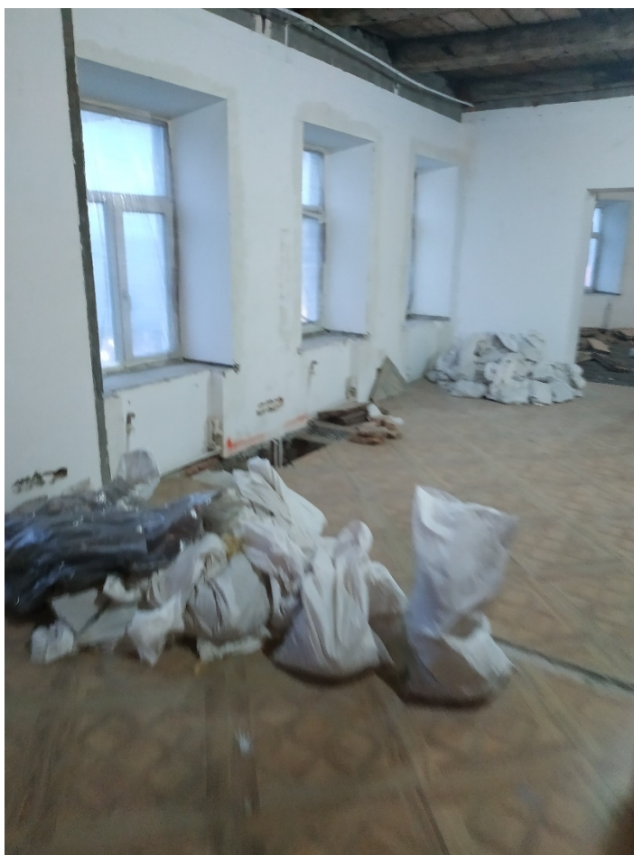
Фото 30. Отсутствие внешней отделки, складирование строительного мусора.
