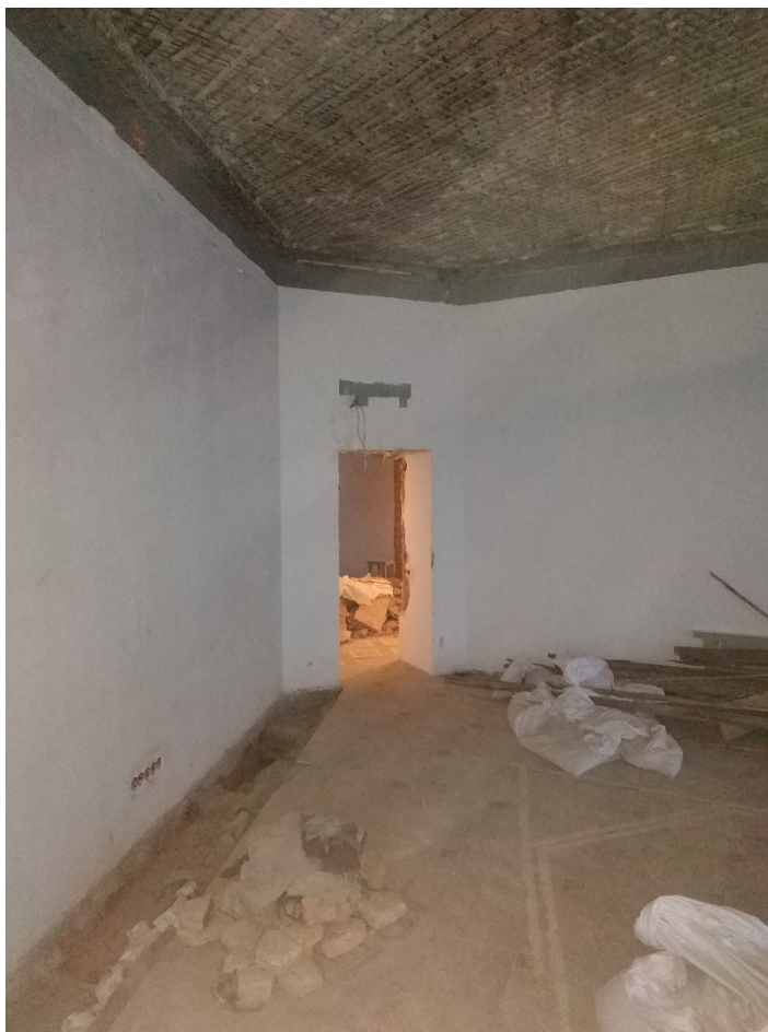
Фото 19. Отсутствие внешней отделки, складирование строительного мусора.
