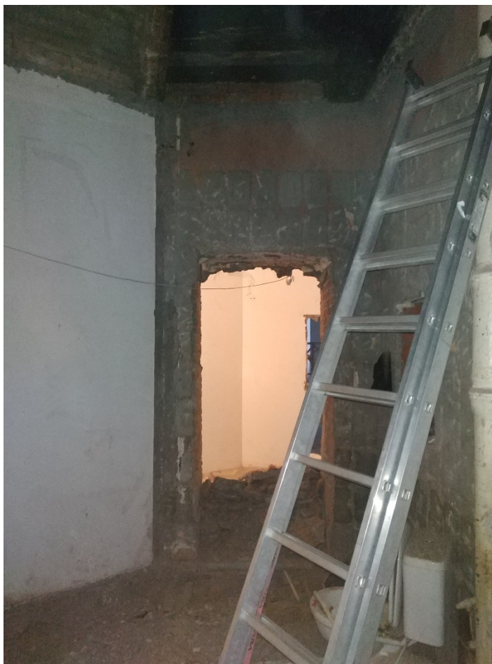
Фото 3. Отсутствие внешней отделки, складирование строительного мусора.
