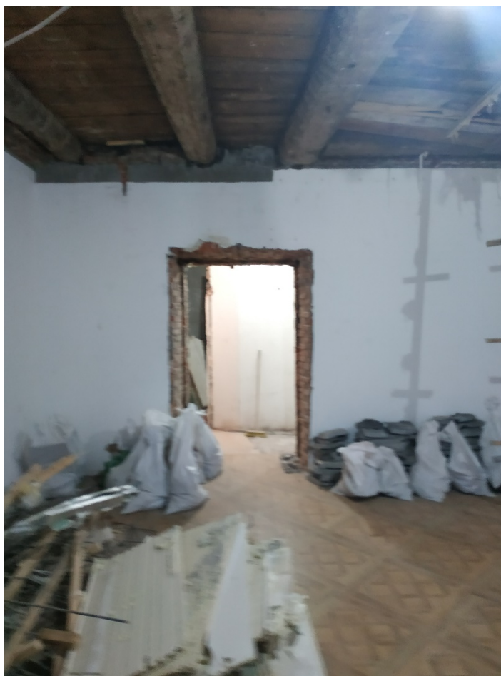
Фото 32. Отсутствие внешней отделки, складирование строительного мусора.
