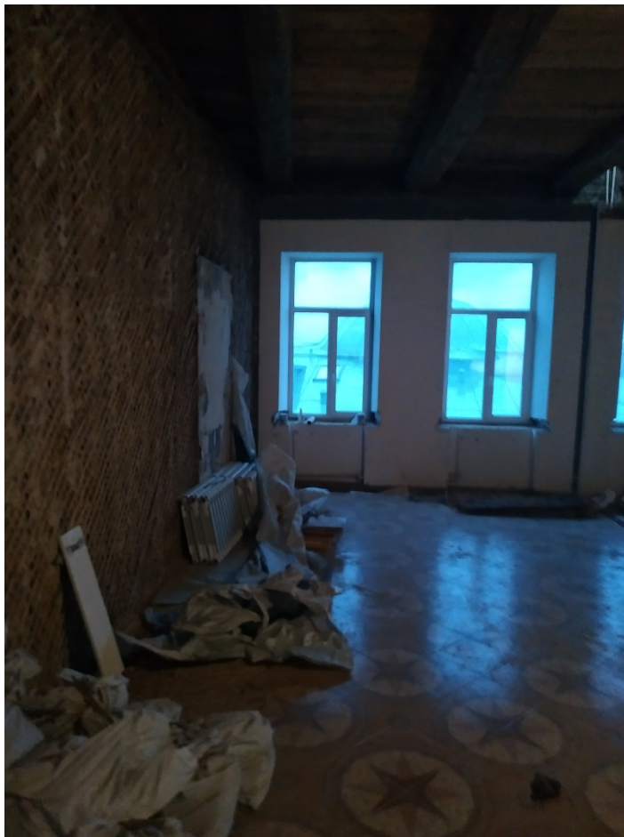
Фото 7. Отсутствие внешней отделки, складирование строительного мусора.
