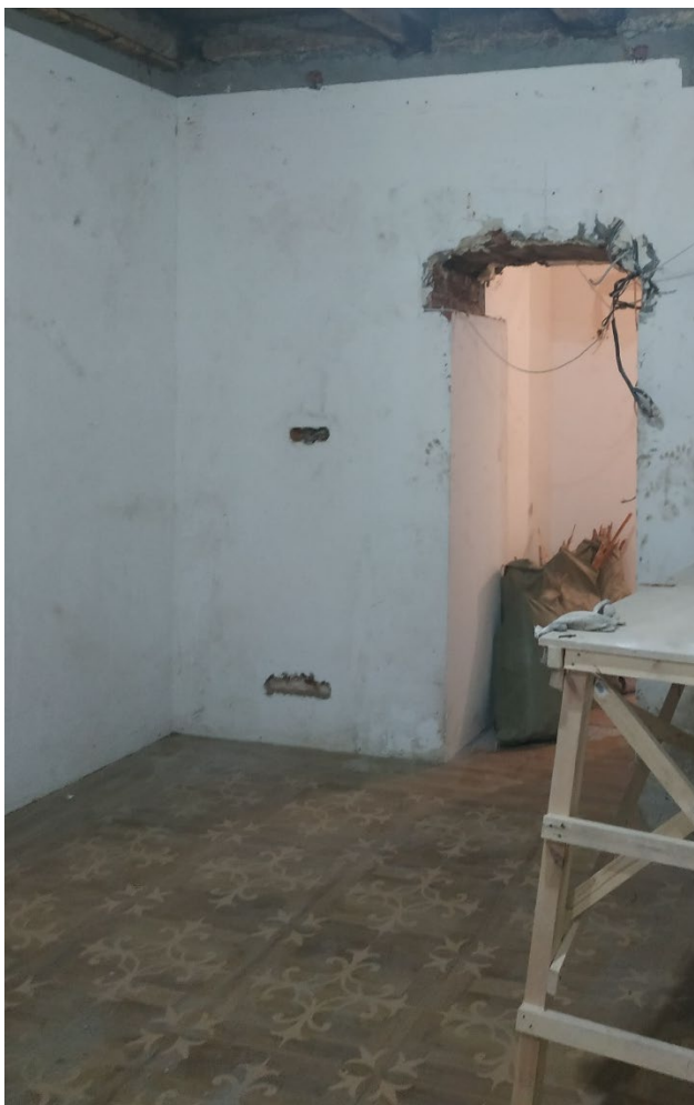
Фото 37. Отсутствие внешней отделки, складирование строительного мусора.
