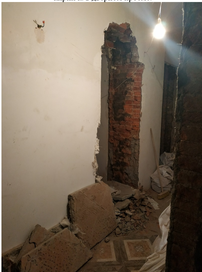
Фото 14. Отсутствие внешней отделки, складирование строительного мусора. Частичная вывалка кирпича в дверном проёме.
