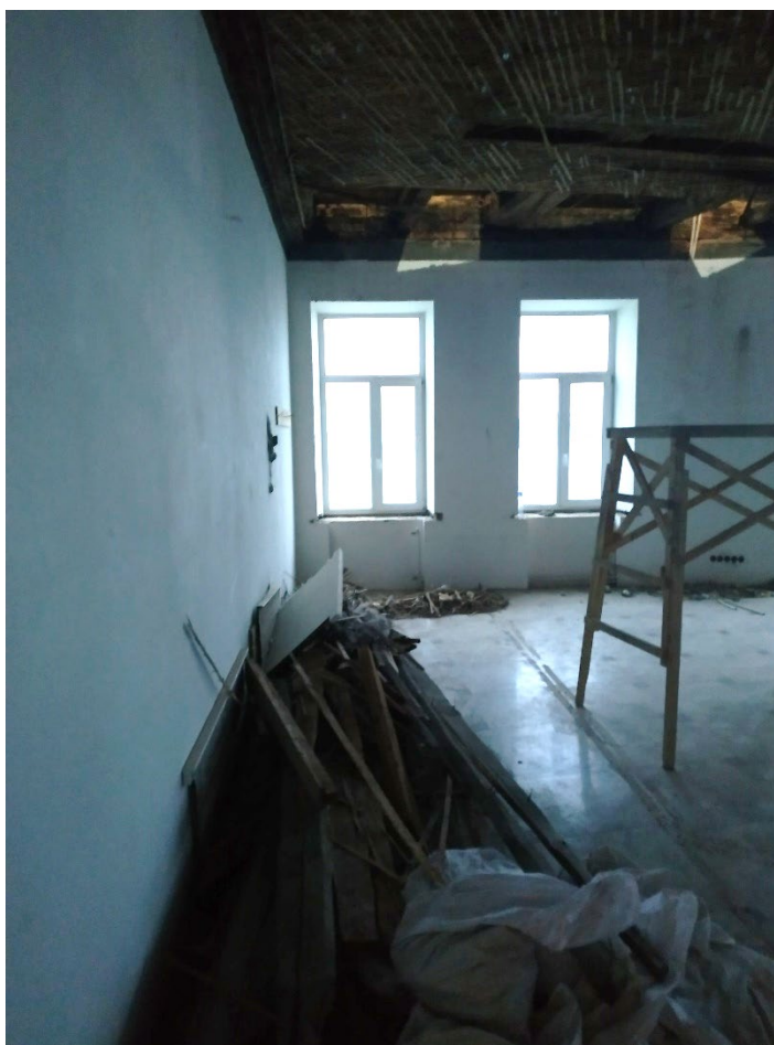
Фото 18. Отсутствие внешней отделки, складирование строительного мусора.
