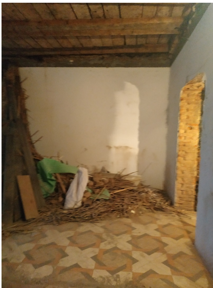
Фото 10. Отсутствие внешней отделки, складирование строительного мусора.
