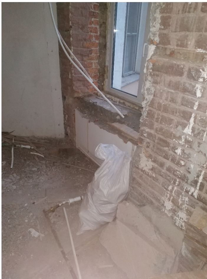
Фото 2. Отсутствие внешней отделки, складирование строительного мусора.
