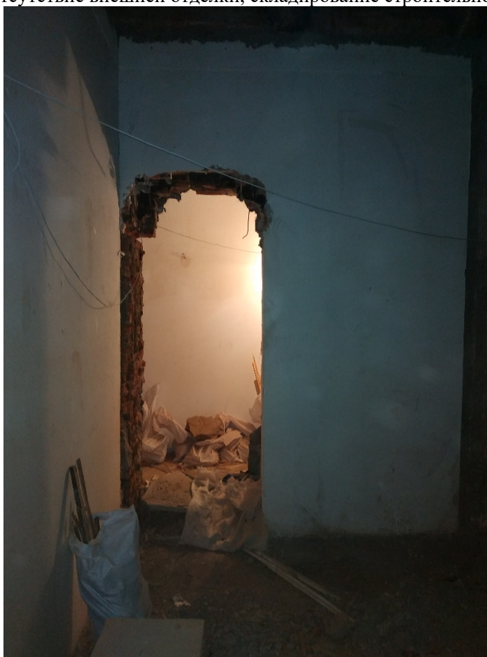
Фото 4. Отсутствие внешней отделки, складирование строительного мусора. Частичная вывалка кирпича в дверном проёме.
