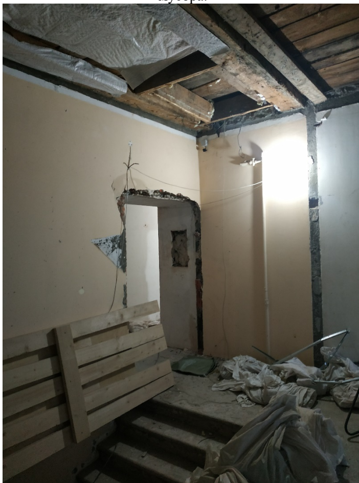
Фото 22. Лестница ЗЛК, 3 этаж. Отсутствие внешней отделки, складирование строительного мусора.
