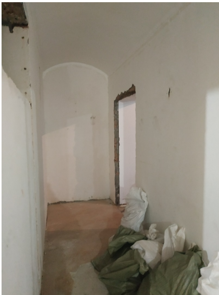
Фото 27. Отсутствие внешней отделки, складирование строительного мусора.
