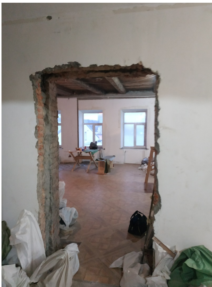
Фото 26. Отсутствие внешней отделки, складирование строительного мусора.
