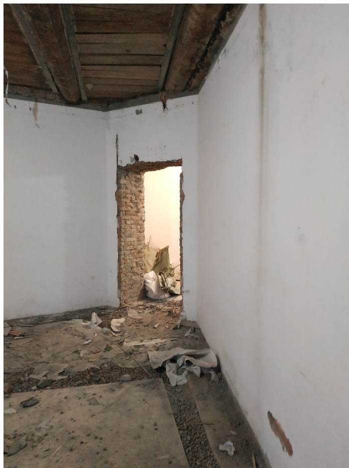
Фото 35. Отсутствие внешней отделки, складирование строительного мусора.
