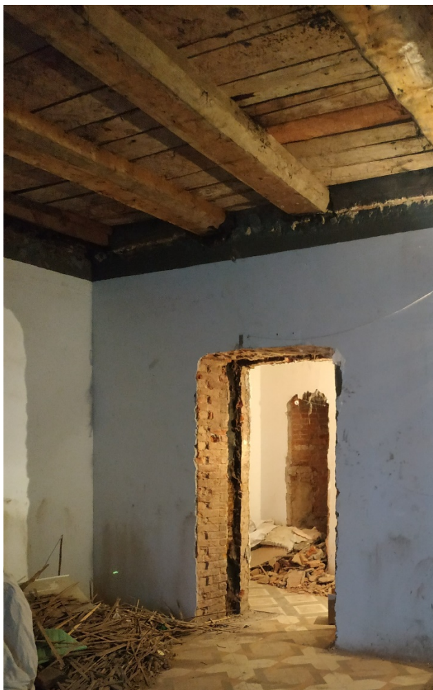
Фото 11. Отсутствие внешней отделки, складирование строительного мусора.
