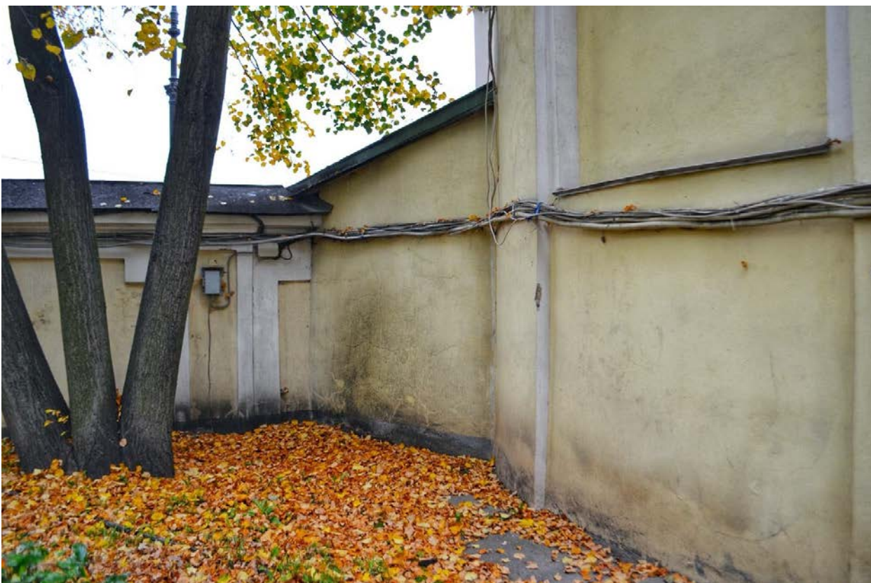
Фото 08. ОКН федерального значения «Церковь Всех Скорбящих Радости (надвратная)». Западный фасад. Фрагмент. Съёмка 26.10.2020 г.
