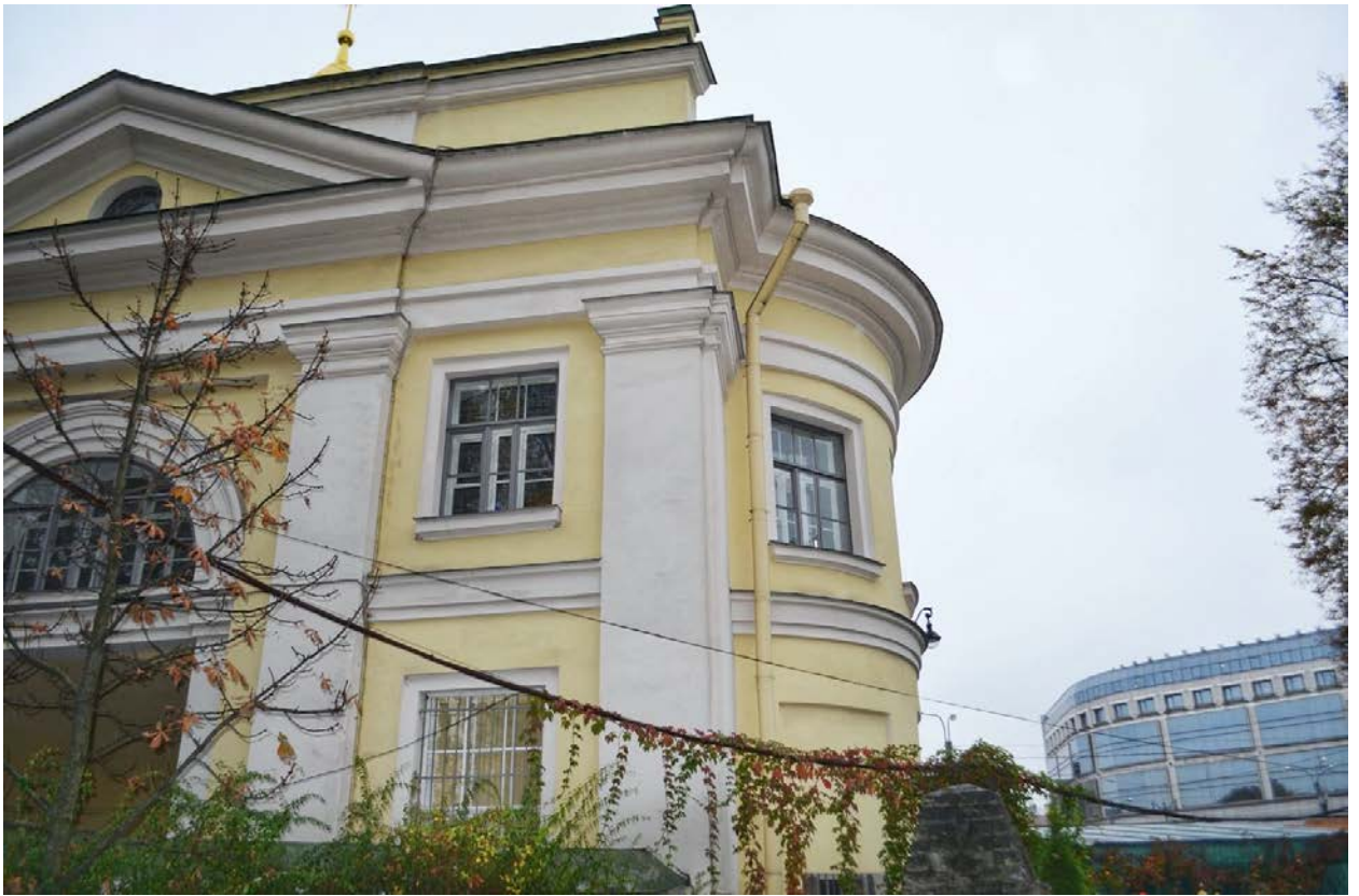
Фото 16. ОКН федерального значения «Церковь Всех Скорбящих Радости (надвратная)». Южный фасад. Фрагмент. Съёмка 26.10.2020 г.
