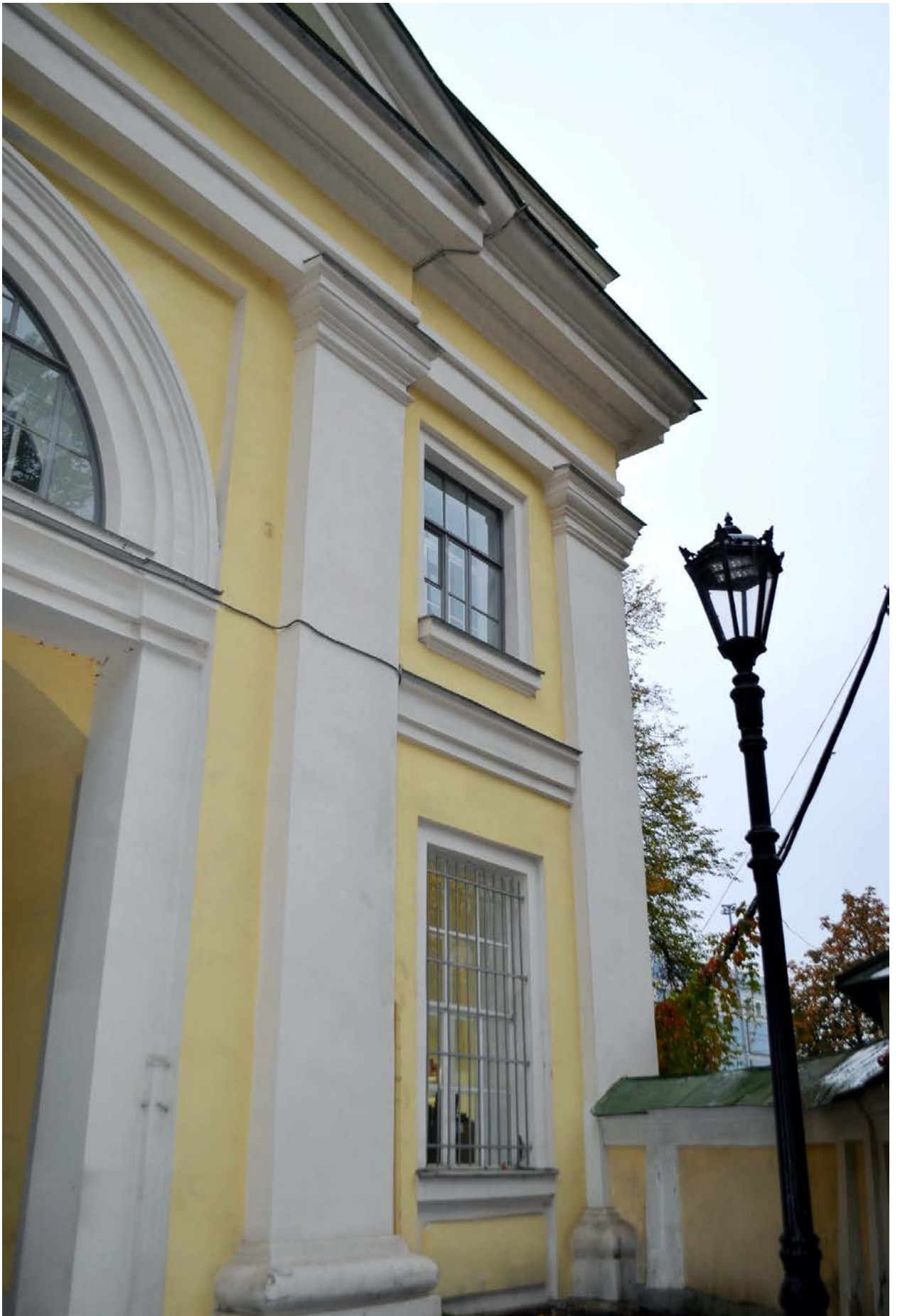
Фото 18. ОКН федерального значения «Церковь Всех Скорбящих Радости (надвратная)». Южный фасад. Фрагмент. Съёмка 26.10.2020 г.
