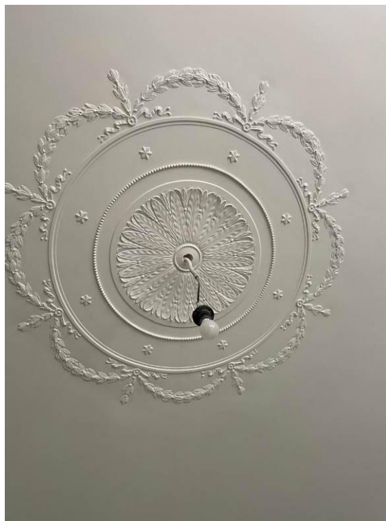
Фото 10. Интерьер квартиры № 5 выявленного объекта культурного наследия «Дом Второго Санкт-Петербургского товарищества для устройства постоянных квартир (с курдонером, палисадниками и оградой)»
