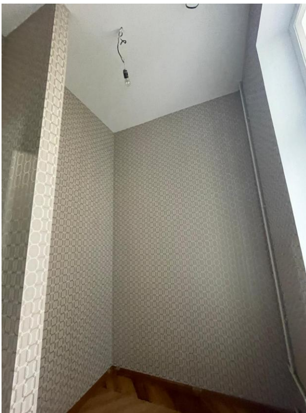
Фото 27. Интерьер квартиры № 5 выявленного объекта культурного наследия «Дом Второго Санкт-Петербургского товарищества для устройства постоянных квартир (с курдонером, палисадниками и оградой)»
