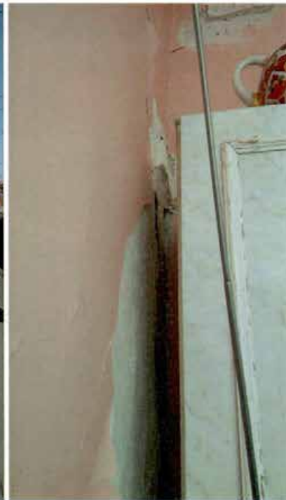
11. Трещины с маяками в квартирах последнего этажа
