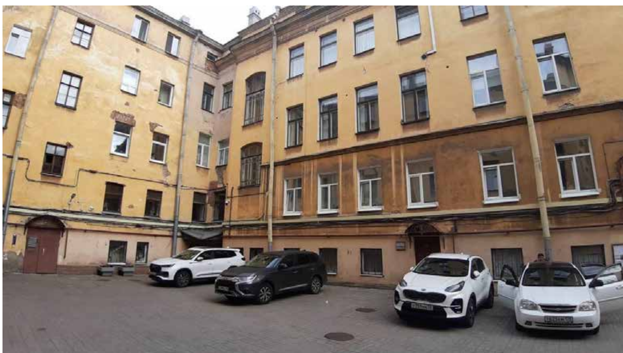
34. «Особняк А.П.Гагариной (дом Н.П.Жеребцовой)» (Миллионная ул., д. 11, лит. А). Дворовый фасад. Фото мест установки оборудования и прокладки кабельных трасс. Штиглиц М.С. 10.06.2024.
