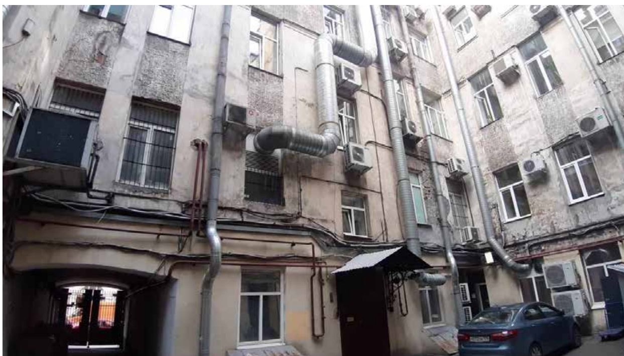
40. «Дом Ш.З. Иофа» (ул. Белинского, д. 13, лит. А). Дворовый фасад. Фото мест установки оборудования и прокладки кабельных трасс. Штиглиц М.С. 10.06.2024.
