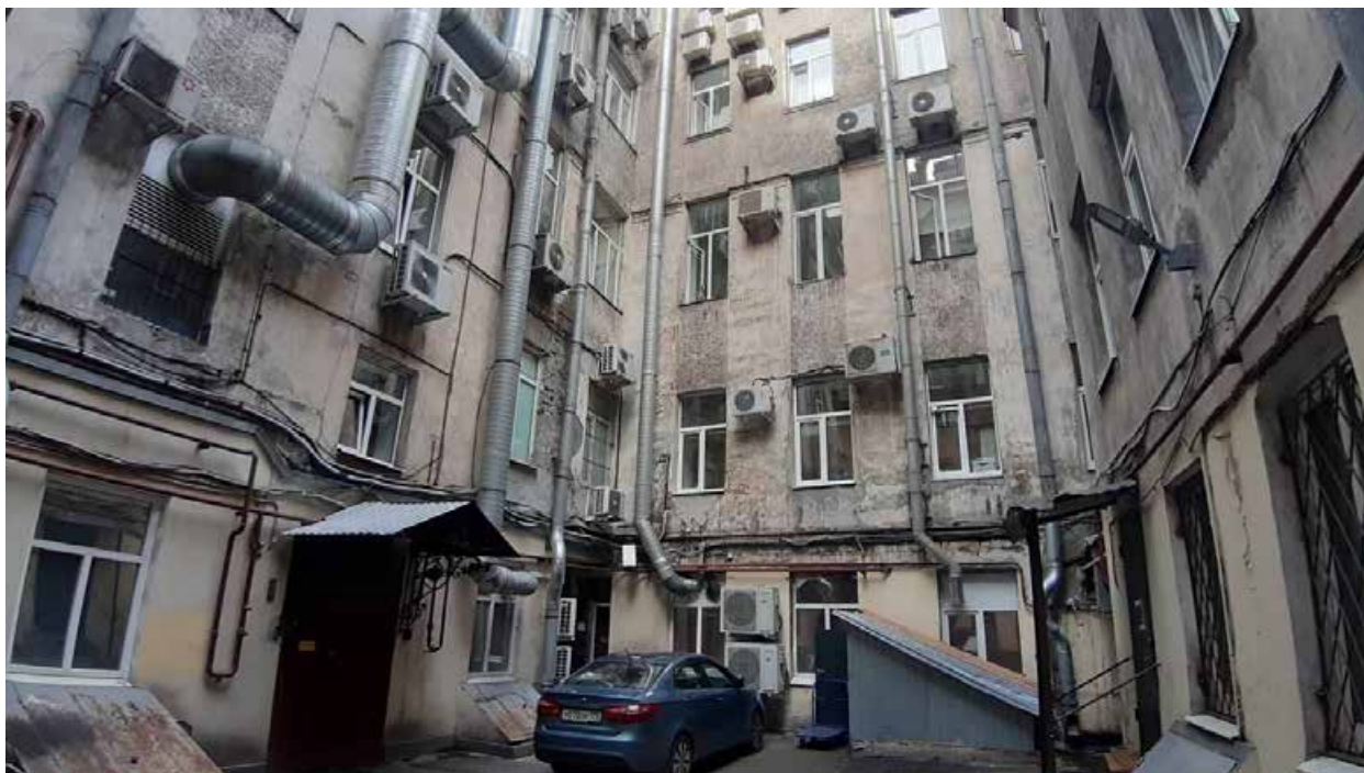
41. «Дом Ш.З. Иофа» (ул. Белинского, д. 13, лит. А). Дворовый фасад. Фото мест установки оборудования и прокладки кабельных трасс. Штиглиц М.С. 10.06.2024.
