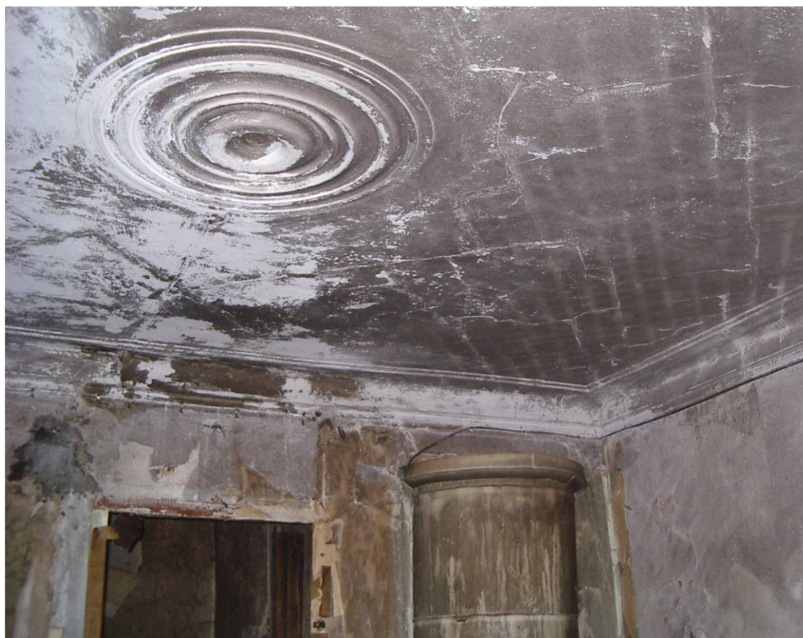
Илл. 21. Лепной декор потолка одного из помещений жилого дома (состояние после пожара). Фотография. 2004 г.
