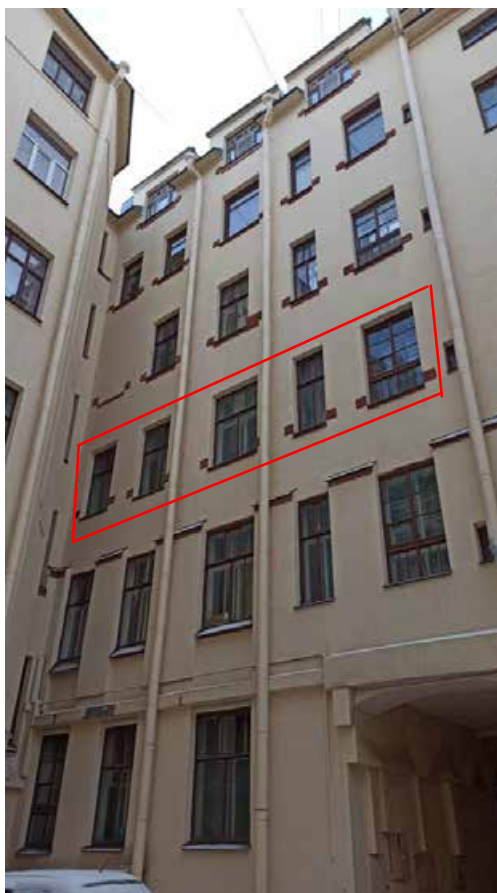
Фото 4. Фрагмент дворового фасада объекта культурного наследия регионального значения «Дом инженера А.Ф. Циммермана (лицевой дом с палисадником, ограждением палисадника и 2 флигелями)»
