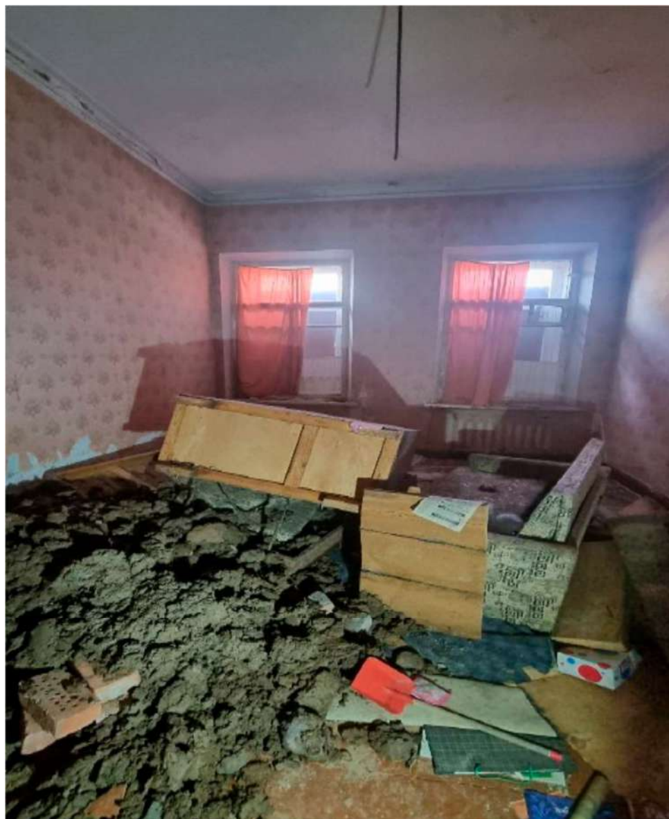
11. Выявленный объект культурного наследия «Казарма Офицерской стрелковой школы» по адресу: Санкт-Петербург, г. Ломоносов, Владимирская ул., д.12, литера А
