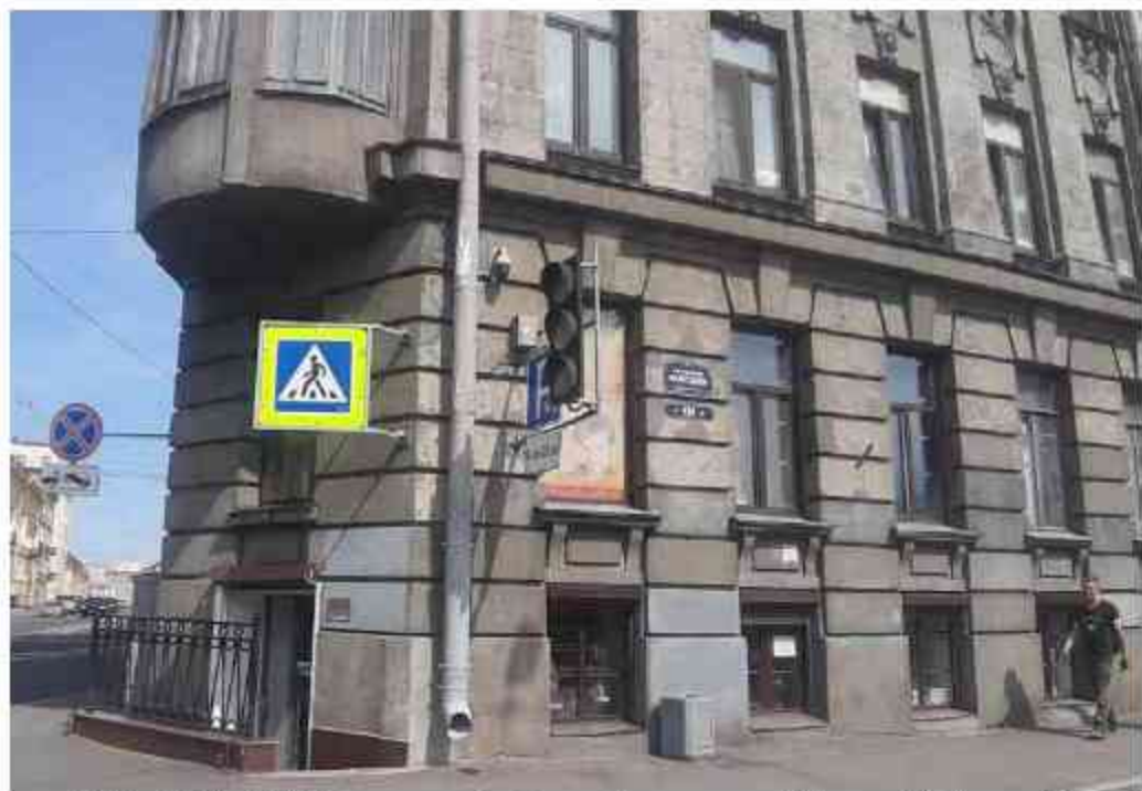
50. Дом С.И. и Б.И.Марголиных (наб. реки Фонтанки, д. 131, лит. А). Лицевой фасад. Фото мест установки оборудования и прокладки кабельных трасс. Штиглиц М.С. 11.06.2024.
