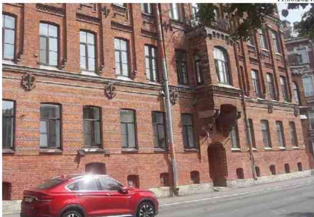
40. Доходный дом (в составе «Дом и фабрика шелковых изделий А.И.Ниссена») (наб. реки Фонтанки, д. 183, лит. А). Лицевой фасад. Фото мест установки оборудования и прокладки кабельных трасс. Штиглиц М.С. 11.06.2024.
