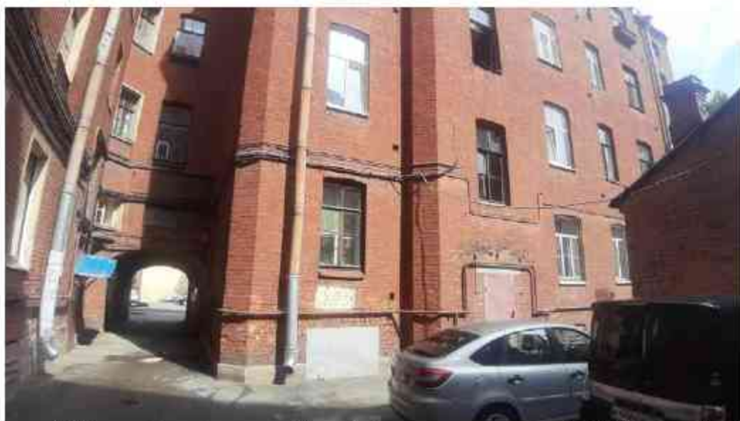
43. Доходный дом (в составе «Дом и фабрика шелковых изделий А.И.Ниссена») (наб. реки Фонтанки, д. 183, лит. А). Дворовый фасад. Фото мест установки оборудования и прокладки кабельных трасс. Штиглиц М.С. 11.06.2024.
