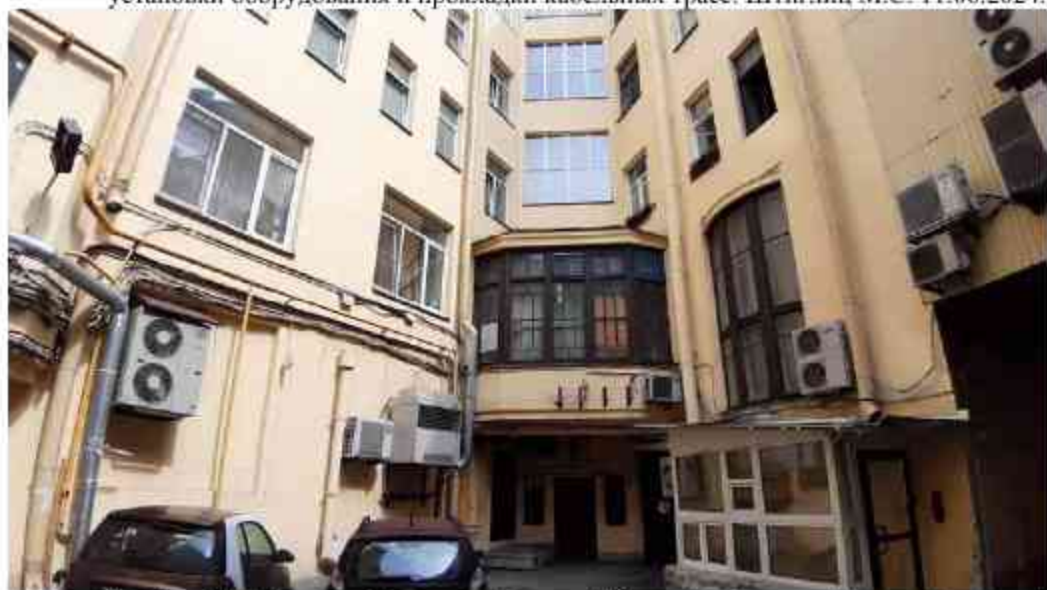
26. Дом Я.И. Перетца (Московский пр., д. 1/2, лит.А). Дворовый фасад. Фото мест установки оборудования и прокладки кабельных трасс. Штиглиц М.С. 11.06.2024.
