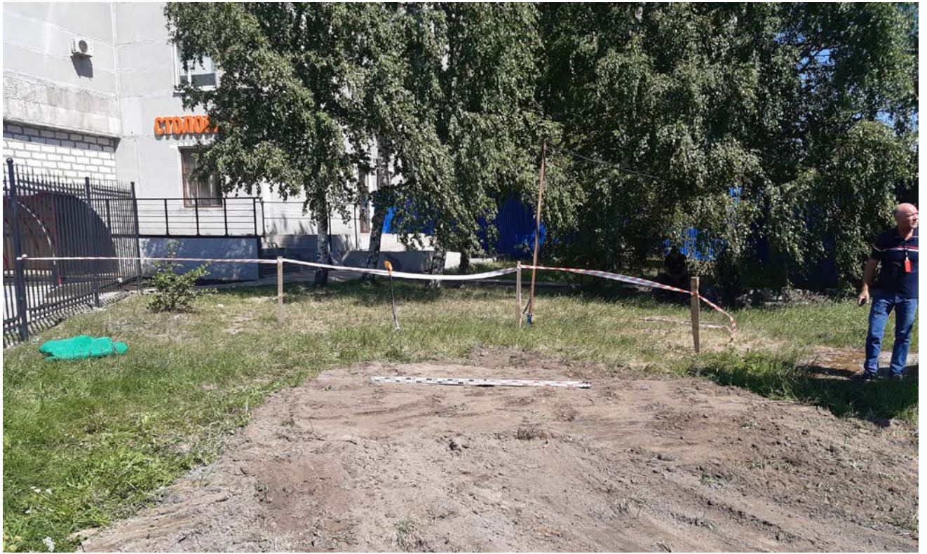
Рис. 40. Санкт-Петербург, Выборгский район, 1-й Верхний пер. д. 2 лит. Б. Шурф 1. Фотофиксация после рекультивации вид на север.
