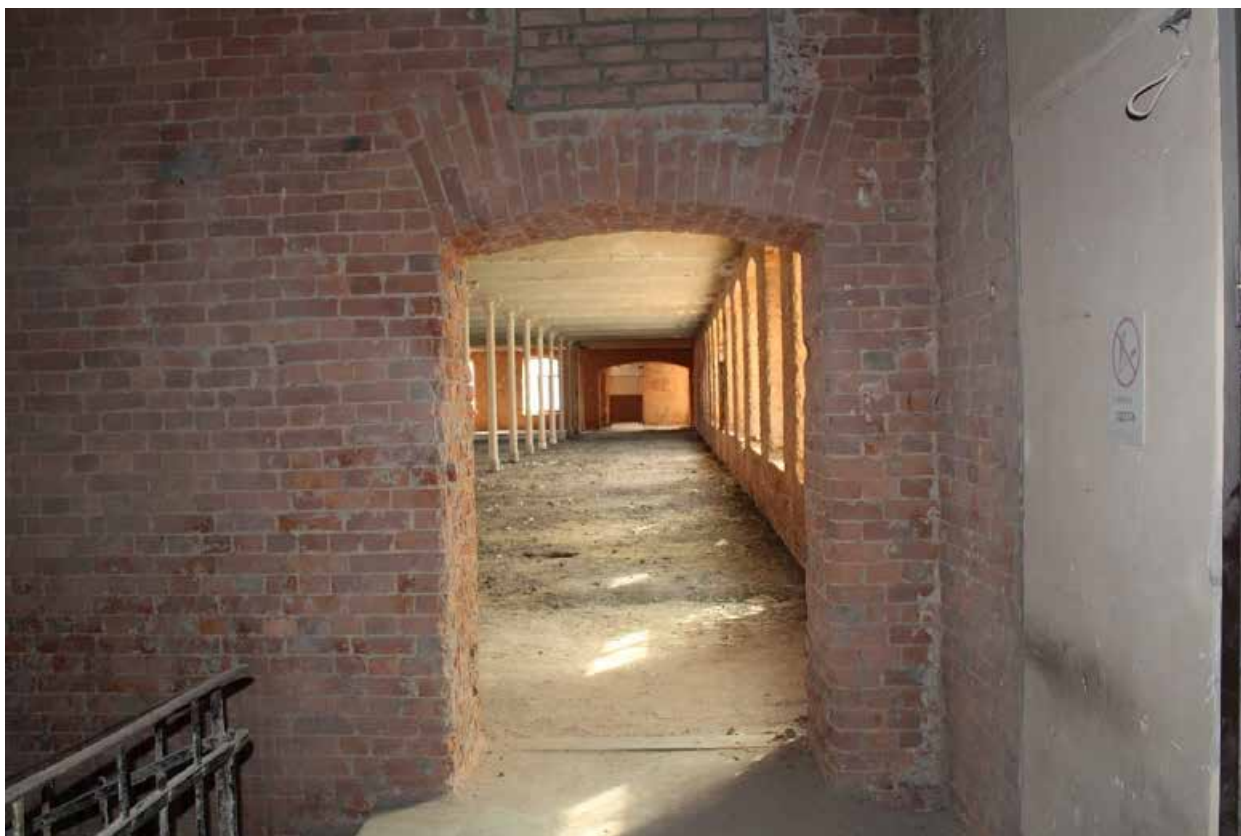
Фото 58. Центральный корпус объекта культурного наследия регионального значения «Производственные корпуса обувной фабрики». 2ЛК в уровне 3-го этажа.
