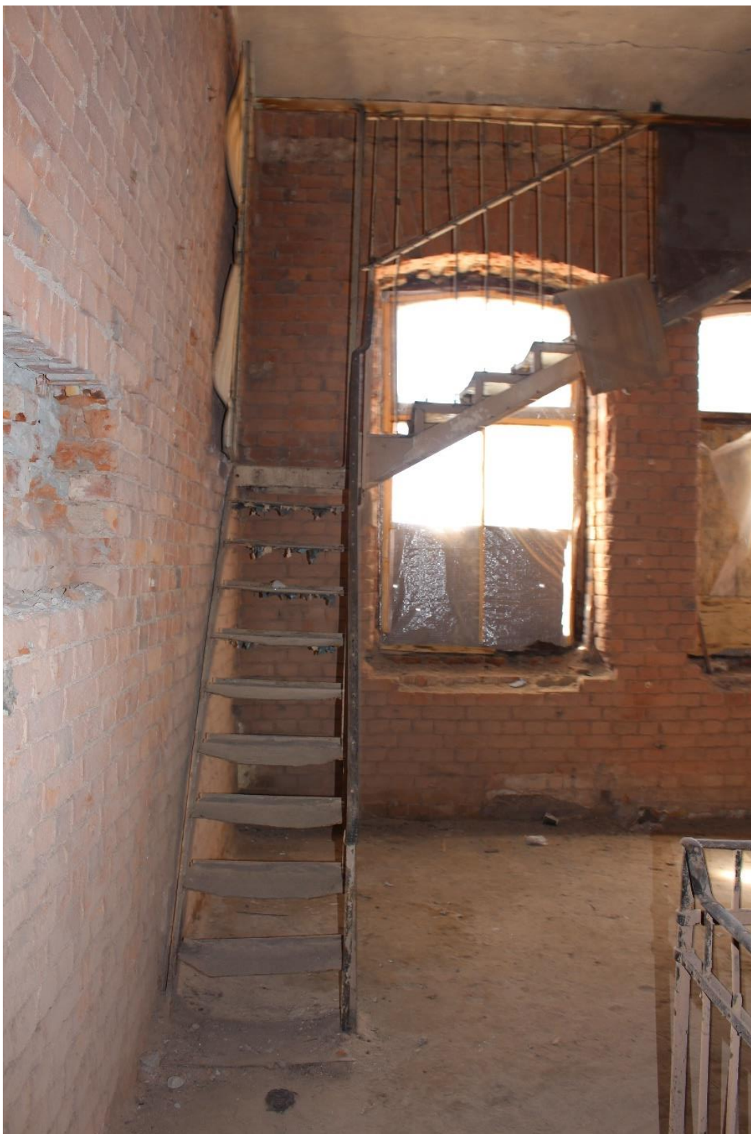
Фото 115. Центральный корпус объекта культурного наследия регионального значения «Производственные корпуса обувной фабрики». 2ЛК в уровне 5-го этажа.
