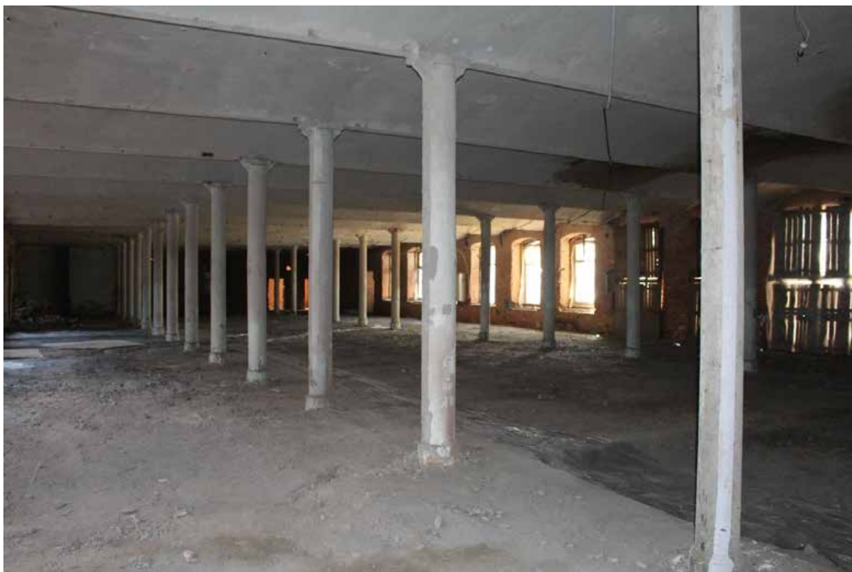
Фото 31. Центральный корпус объекта культурного наследия регионального значения «Производственные корпуса обувной фабрики». Внутренние помещения 1-го этажа.
