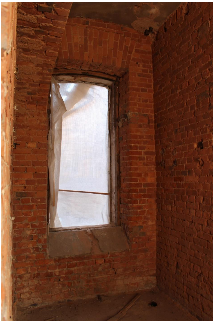
Фото 35. Центральный корпус объекта культурного наследия регионального значения «Производственные корпуса обувной фабрики». Внутренние помещения 1-го этажа.
