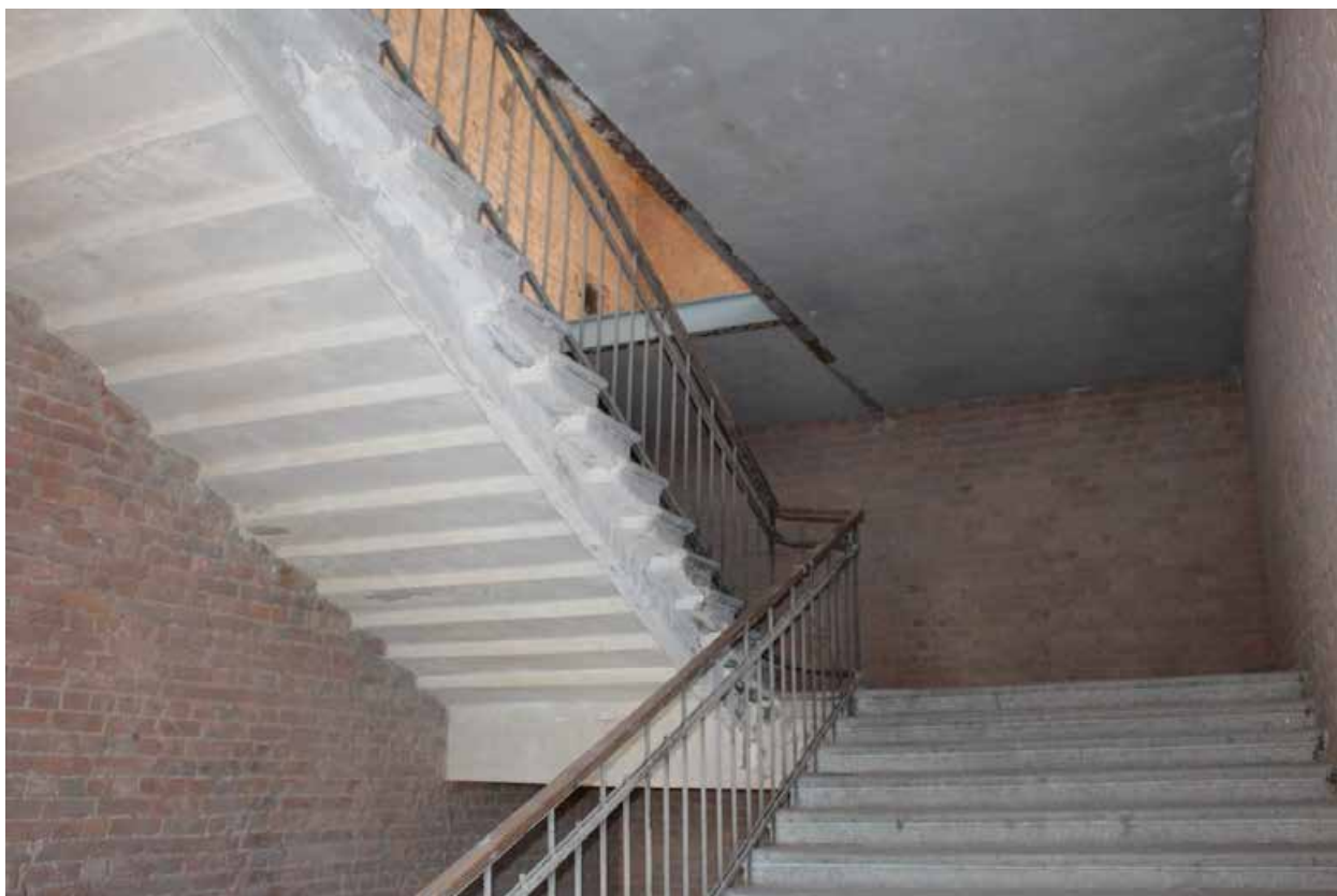
Фото 79. Центральный корпус объекта культурного наследия регионального значения «Производственные корпуса обувной фабрики». 1ЛК вид с 4-го этажа.
