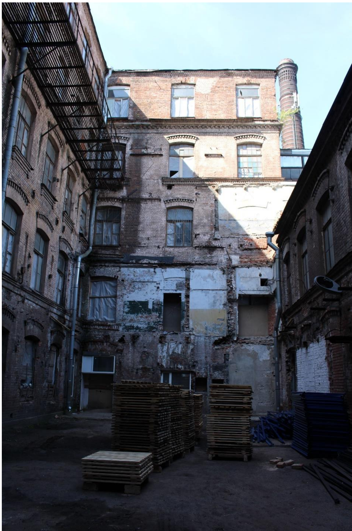
Фото 14. Вид на восточный фасад северной части центрального корпуса объекта культурного наследия регионального значения «Производственные корпуса обувной фабрики».
