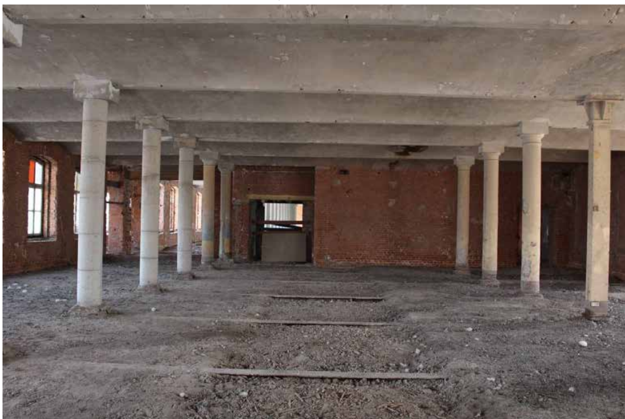
Фото 92. Центральный корпус объекта культурного наследия регионального значения «Производственные корпуса обувной фабрики». Внутренние помещения 4-го этажа.
