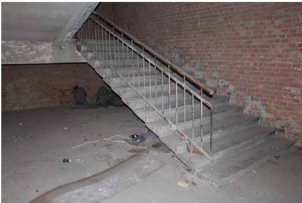
Фото 36. Центральный корпус объекта культурного наследия регионального значения «Производственные корпуса обувной фабрики». 1 ЛК в уровне 1-го этажа.
