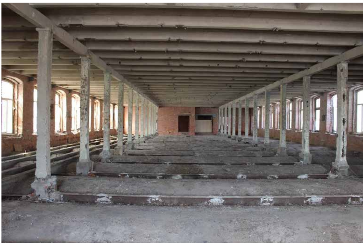
Фото 105. Центральный корпус объекта культурного наследия регионального значения «Производственные корпуса обувной фабрики». Внутренние помещения 5-го этажа.
