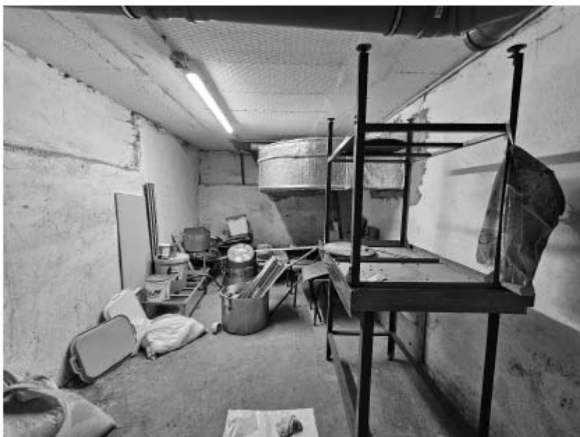
13. Объект культурного наследия регионального значения «Дом П.М. Станового», по адресу: г. Санкт-Петербург, Мыгнинская ул., д. 5/2, лит. А. Фрагмент пом. 8-Н (1) в уровне подвала.
