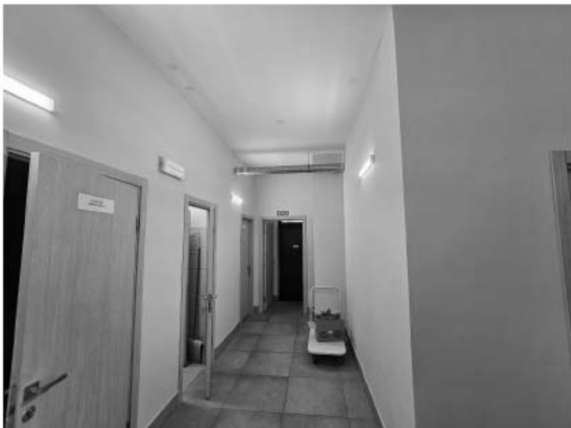
38. Объект культурного наследия регионального значения «Дом П.М. Станового», по адресу: г. Санкт-Петербург, Мытнинская ул., д. 5/2, лит. А. Фрагмент пом. 2-Н (5) в уровне 1-го этажа.
