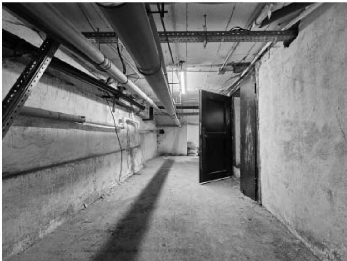
11. Объект культурного наследия регионального значения «Дом П.М. Станового», по адресу: г. Санкт-Петербург, Мытнинская ул., д. 5/2, лит. А. Фрагмент пом. 8-Н (1) в уровне подвала.
