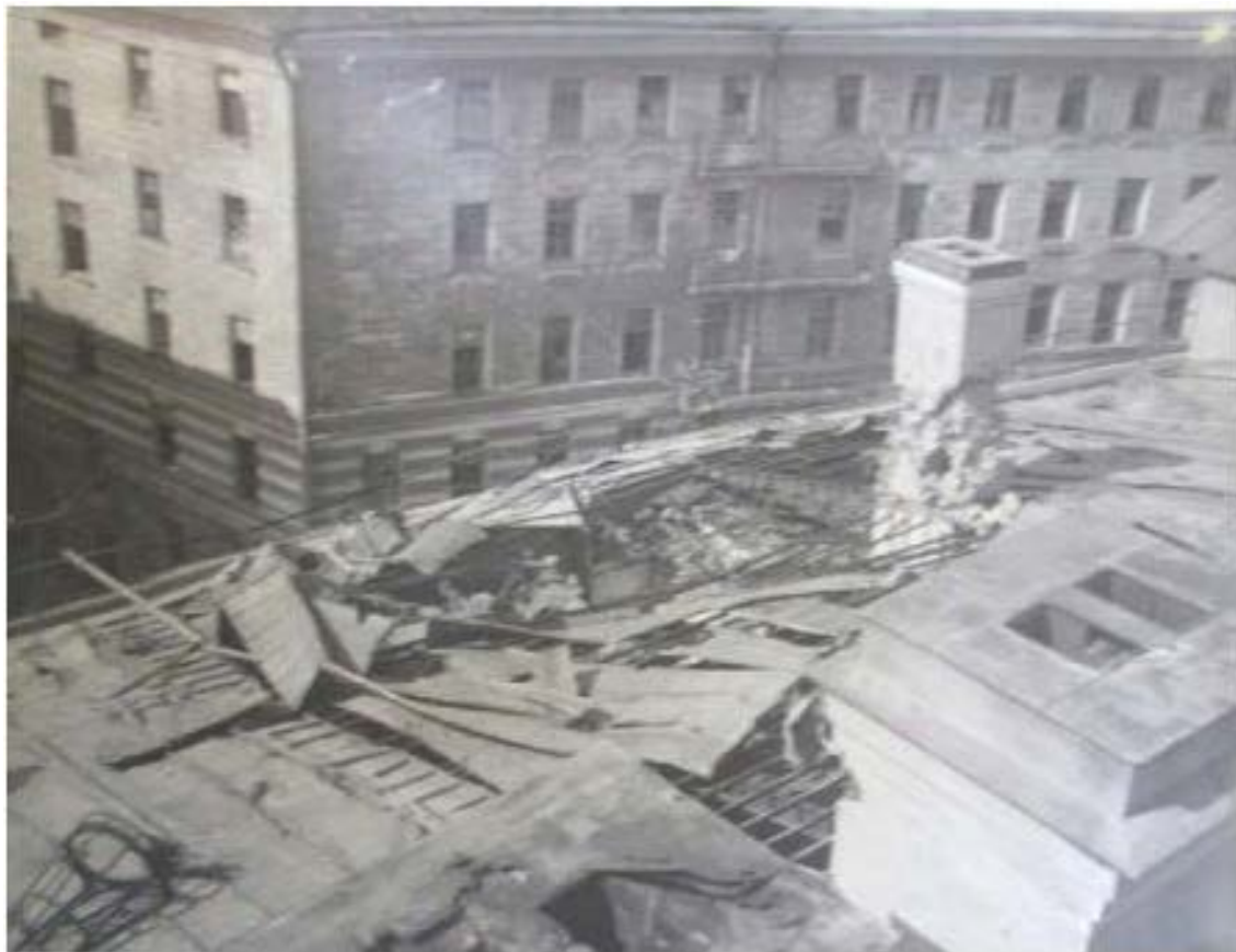
25. Разрушение крыши полуциркульной части памятника. Октябрь 1943 г. Следы разрушений. Акт обследования здания б. Госбанка. Ленинград. Архив КГИОП.
