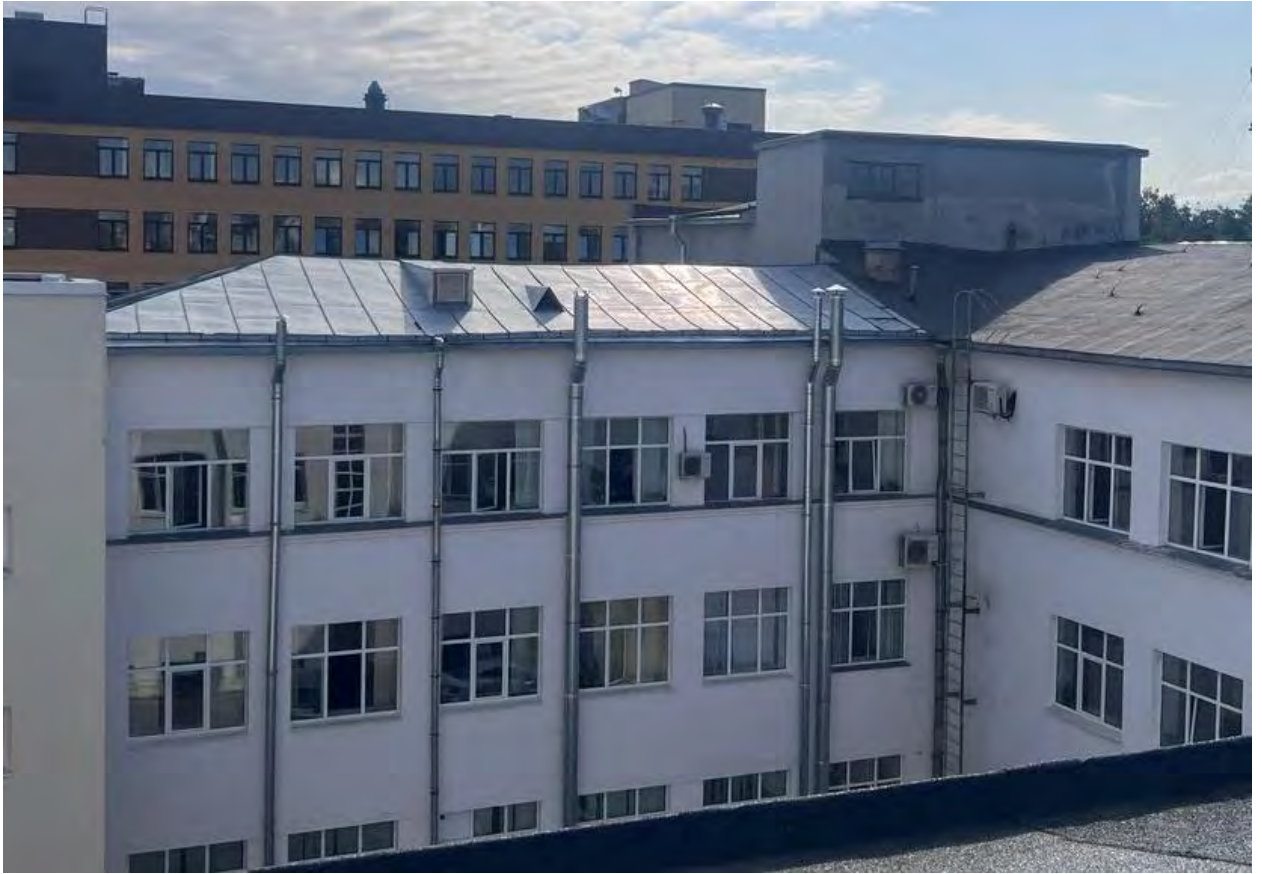
Фото 03. Выявленный ОКН «Гидротехнический институт им. Б.Е. Веденеева (лицевой корпус с примыкающими дворовыми флигелями)», расположенного по адресу: Санкт-Петербург, Гжатская д. 21, лит. А. Кровля. Фрагмент. Съёмка 16.08.2024 г.
