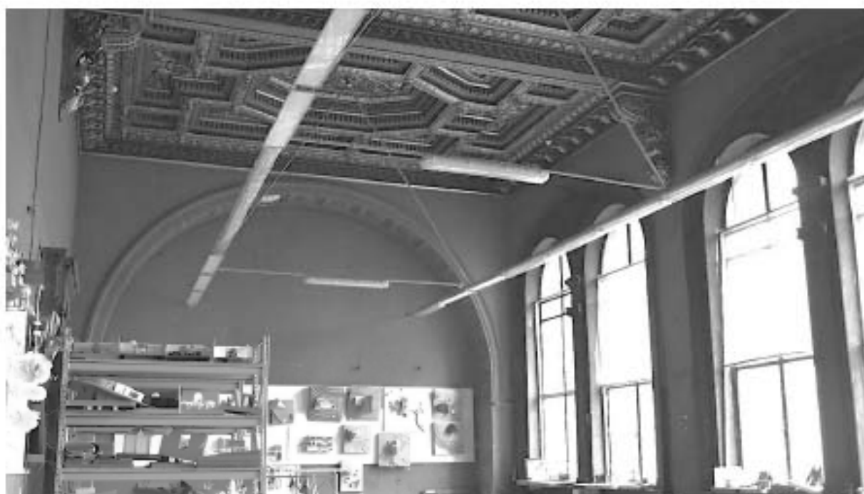
15. Зал Фарфезе (помещение 284 по ПИБ). Объект культурного наследия федерального значения «Музей», входящий в состав объекта культурного наследия федерального значения «Центральное училище технического рисования и музей Штакельберг А.Л.». Санкт-Петербург, Солдатый переулок, дом 13-15, литера В. Дата съемки: 15.06.2024.
