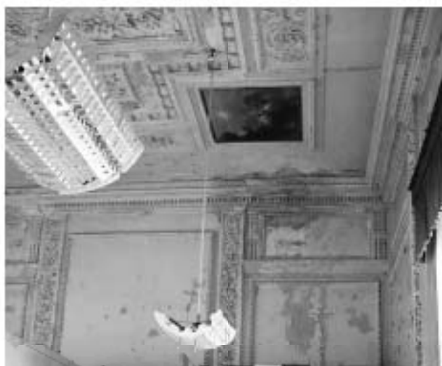
29. Венецианский зал (помещение 307 по ПИБ). Объект культурного наследия федерального значения «Музей», входящий в состав объекта культурного наследия федерального значения «Центральное училище технического рисования и музей Штиглица А.Л.». Санкт-Петербург, Соляной переулок, дом 13-15, литера В. Дата съемки: 15.06.2024.
