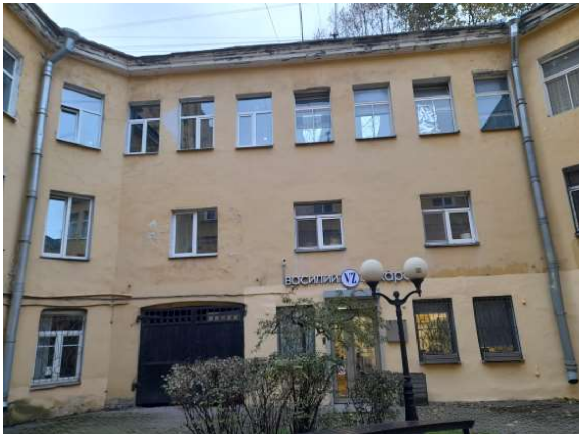
185. Здание по адресу: г. Санкт-Петербург, Караванная ул., 7. Западный дворовый флигель Западный фасад. Фото 11.11.2023 г.
