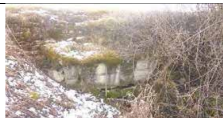
фрагменты кирпичной кладки
