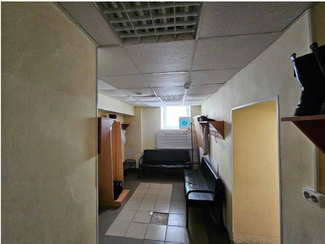
17. Выявленный объект культурного наследия «Здание женской гимназии Э.П. Шаффе», по адресу: г. Санкт-Петербург, 5-я линия, 16, (правая часть). Общий вид пом. 2-Н (20) в уровне подвала.
