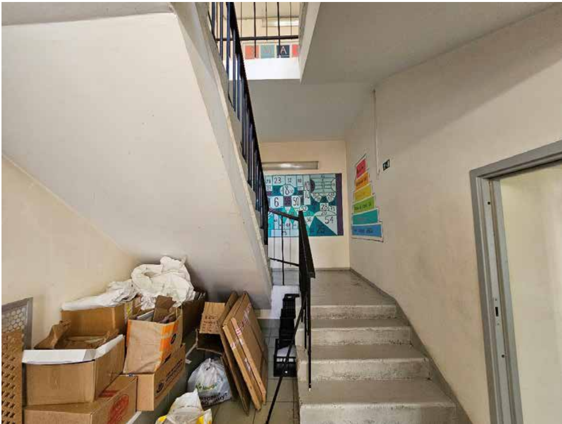
74. Выявленный объект культурного наследия «Дом А.А. Куракиной (Э.П. Шаффе)», по адресу: г. Санкт-Петербург, Большой пр. В.О., 17; 5-я линия, 16 (левая часть). Общий вид лестницы Л-5 (пом. 2-Н (63)) в уровне 1-го этажа.
