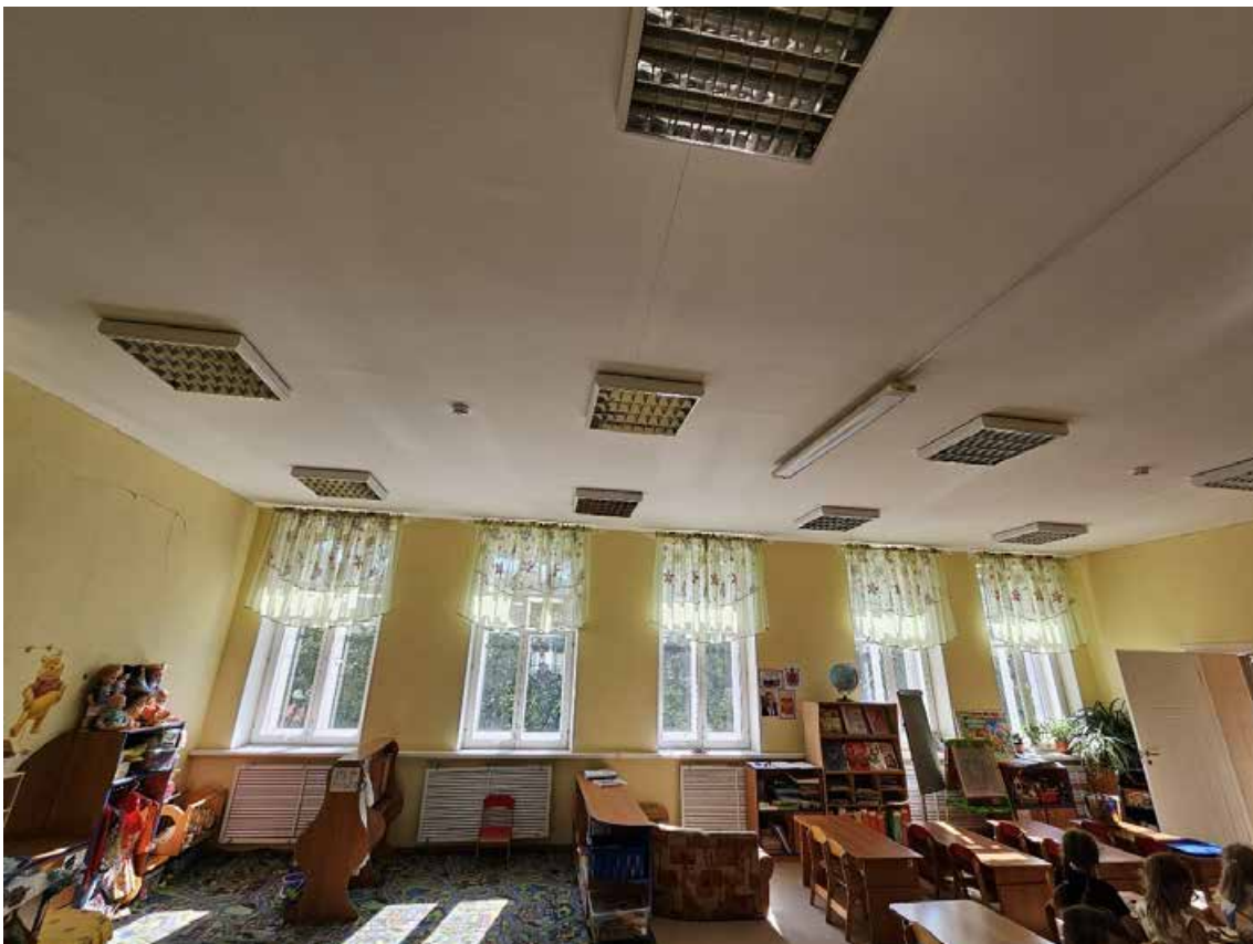
126. Выявленный объект культурного наследия «Дом А.А. Куракиной (Э.П. Шаффе)», по адресу: г. Санкт-Петербург, Большой пр. В.О., 17; 5-я линия, 16 (левая часть). Общий вид пом. 1-Н (86) в уровне 3-го этажа.
