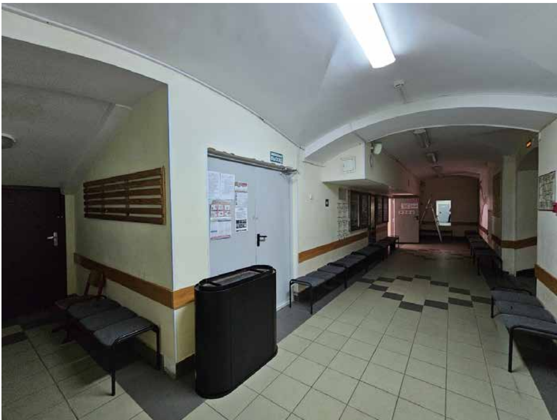
14. Выявленный объект культурного наследия «Здание женской гимназии Э.П. Шаффе», по адресу: г. Санкт-Петербург, 5-я линия, 16, (правая часть). Общий вид пом. 2-Н (15) в уровне подвала.
