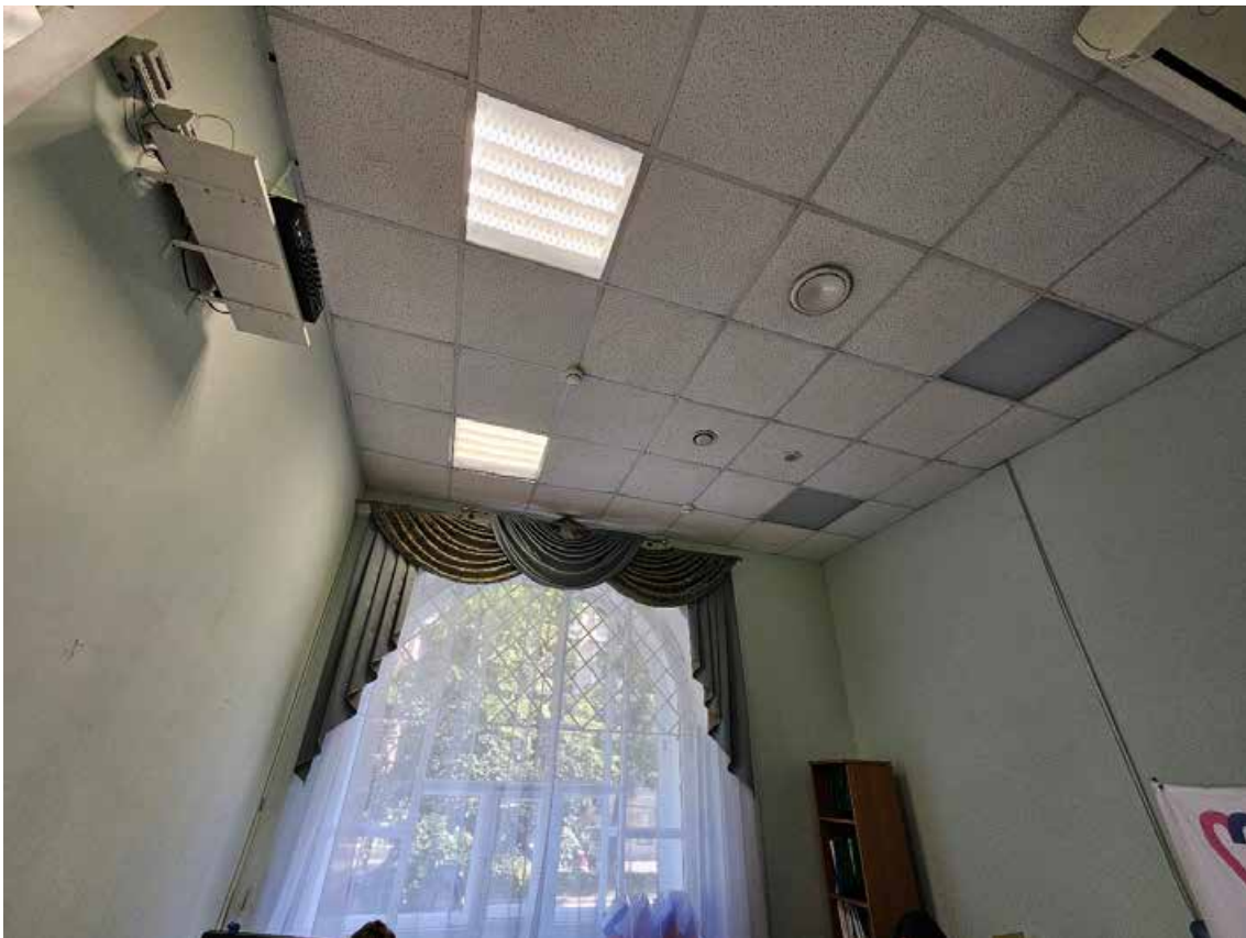
31. Выявленный объект культурного наследия «Здание женской гимназии Э.П. Шаффе», по адресу: г. Санкт-Петербург, 5-я линия, 16, (правая часть). Общий вид пом. 2-Н (6) в уровне 1-го этажа.
