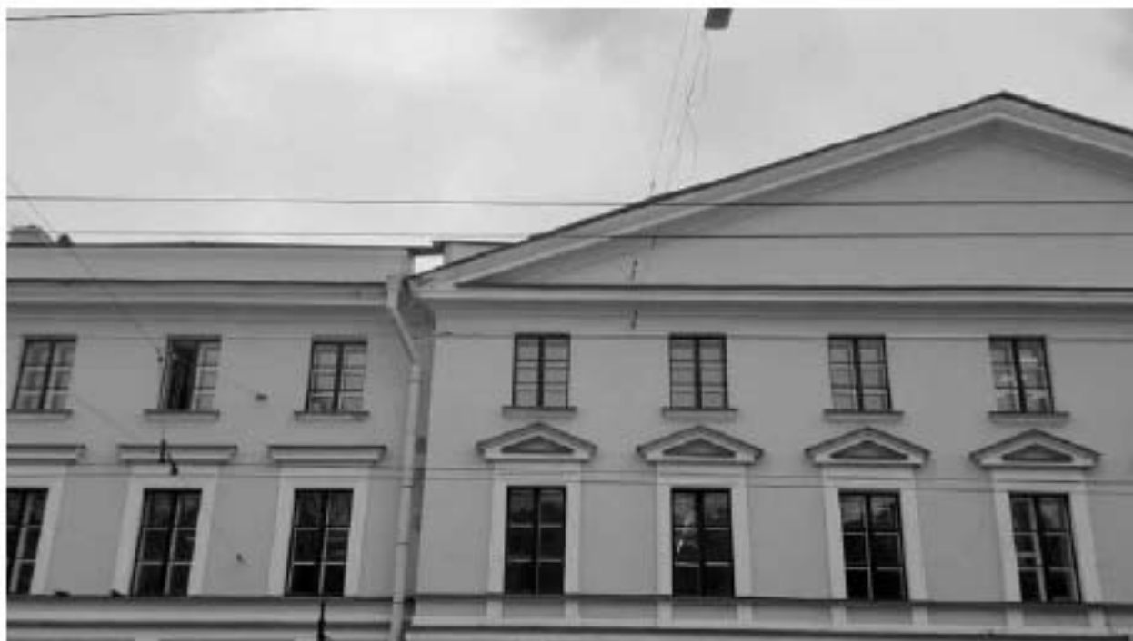
35. Казармы (Трехэскадронный корпус) (в составе «Манеж и казармы Конногвардейского полка») (Конногвардейский бульвар, д. 4, лит. А). Лицевой фасад (фрагмент). Фото мест установки оборудования и кабельных трасс. Штиглиц М.С. 07.05.2024.
