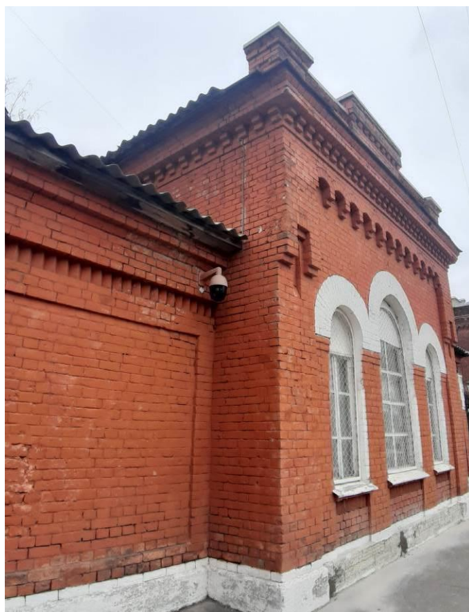
12. Караульная с оградой. Фото мест установки оборудования и кабельных трасс. (Академика Лебедева ул., д. 18, лит. А). Штиглиц М.С. 18.04.2024.
