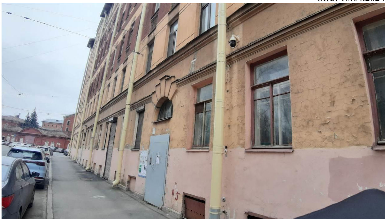
20. Дом М.Е. Румшишского (Академика Лебедева ул., д. 14/2, лит. А). Фрагмент лицевого фасада. Фото мест установки оборудования и кабельных трасс. Штиглиц М.С. 18.04.2024.
