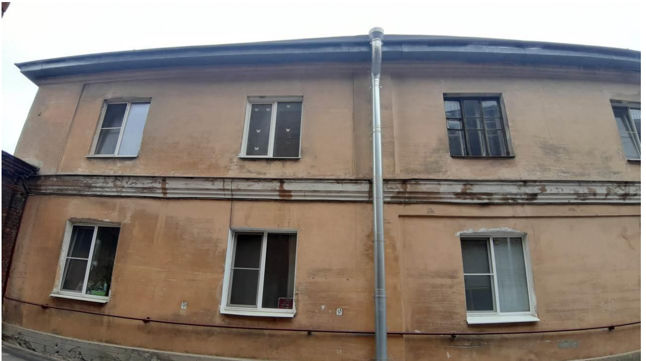
8. Казармы со службой. Фото мест установки оборудования и кабельных трасс. (Академика Лебедева ул., д. 20а, лит. Б). Штиглиц М.С. 18.04.2024.
