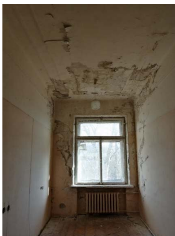
Фото 19. Помещение 5.130 (кабинет). Плохое состояние красочных и отделочных слоёв, сохранился е выраженный карниз по периметру потолка.
