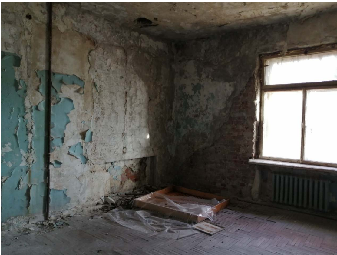
Фото 15. Общий вид помещения 5.132. Частичная утрата штукатурного покрытия стен, красочного покрытия.
