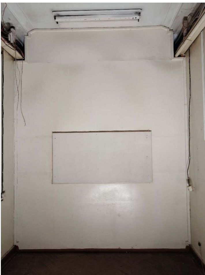
Фото 5. Помещение 5.175. Перегородка, выделяющая часть помещения в объёме коридора с сохранением тяги по периметру потолка.
