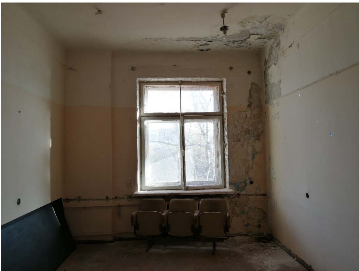
Фото 17. Общий вид помещения 5.131. Плохое состояние красочного слоя и штукатурной отделки помещения.
